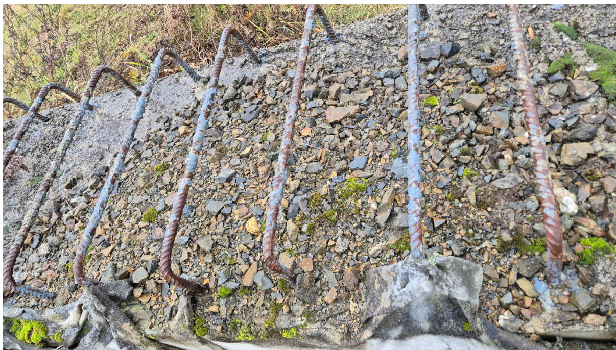
Obr. 1 Degradace betonu a výztuže horního povrchu křídel
