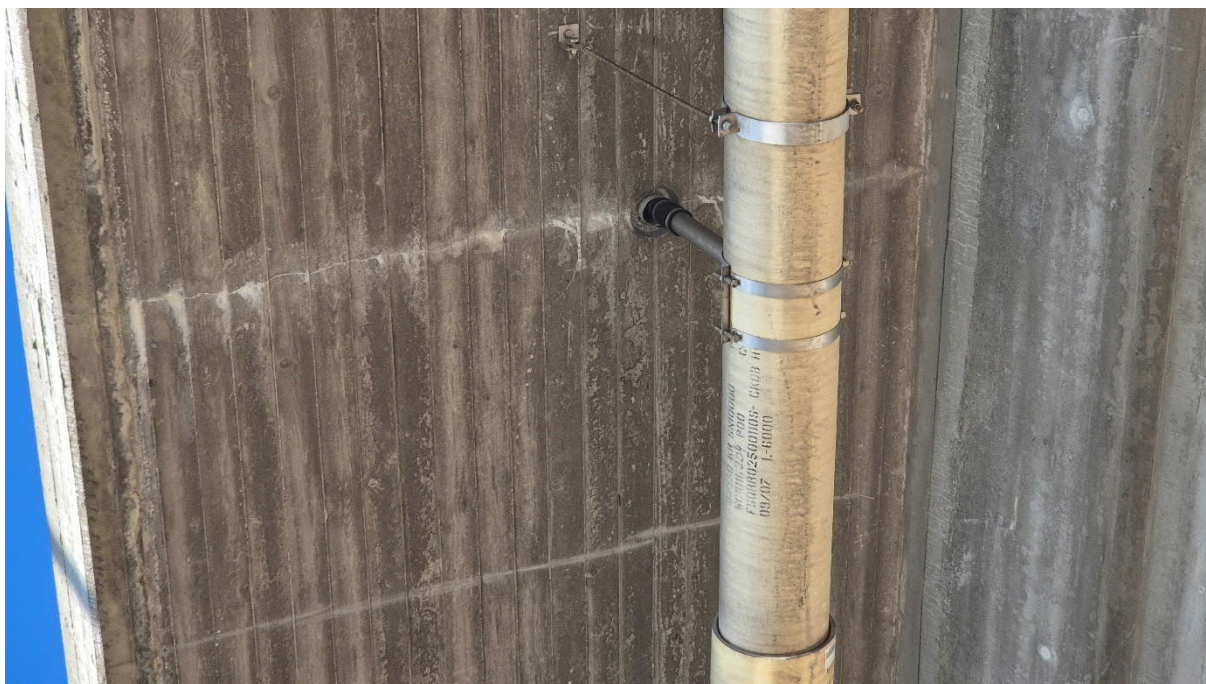
Obr. 13 Trhlina na vnější konzole
