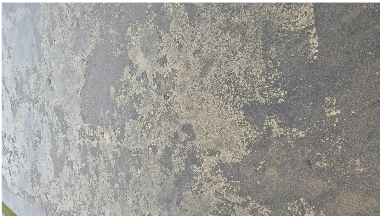
Obr. 7 Stav izolace horního povrchu nosné konstrukce
