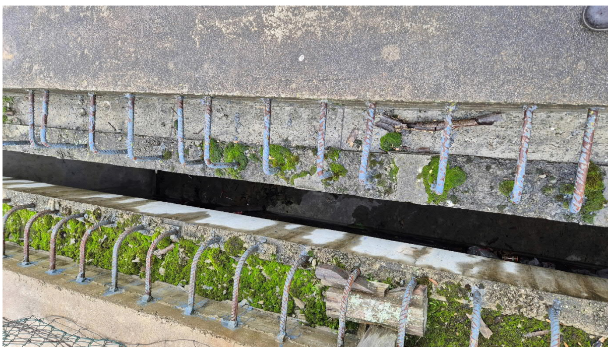
Obr. 6 Degradace betonu a výztuže horního povrchu kapsy pro dilatační závěr
