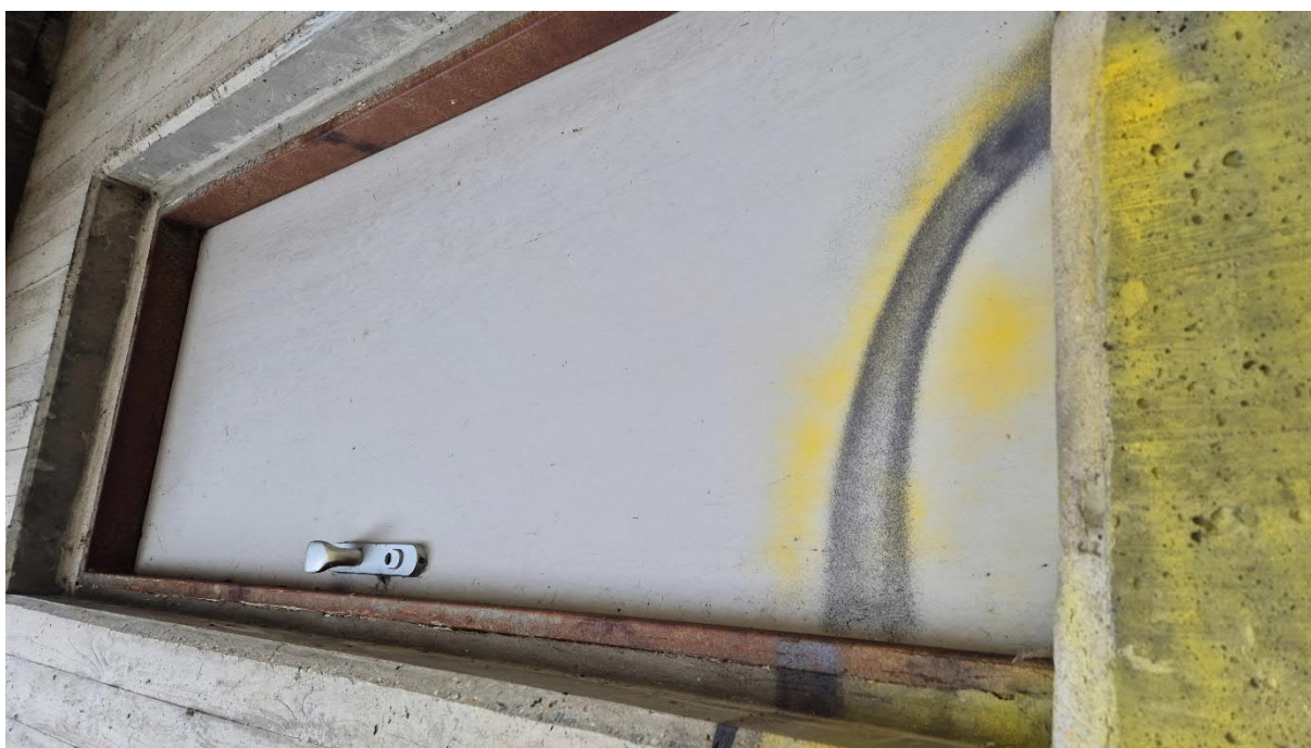
Obr. 12 Dveře vstupu do opěry, není osazen typ dveří v souladu s VL4, z toho důvodu nejsou v rozpočtu zahrnuty
