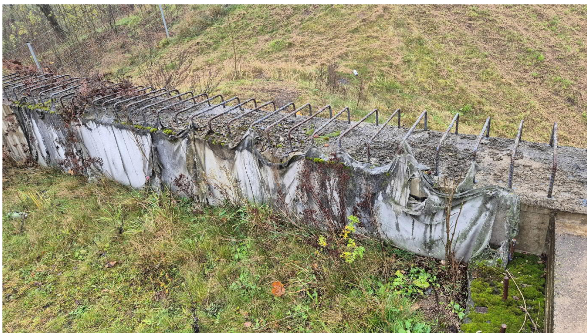
Obr. 2 Degradace betonu a výztuže horního povrchu křídel
