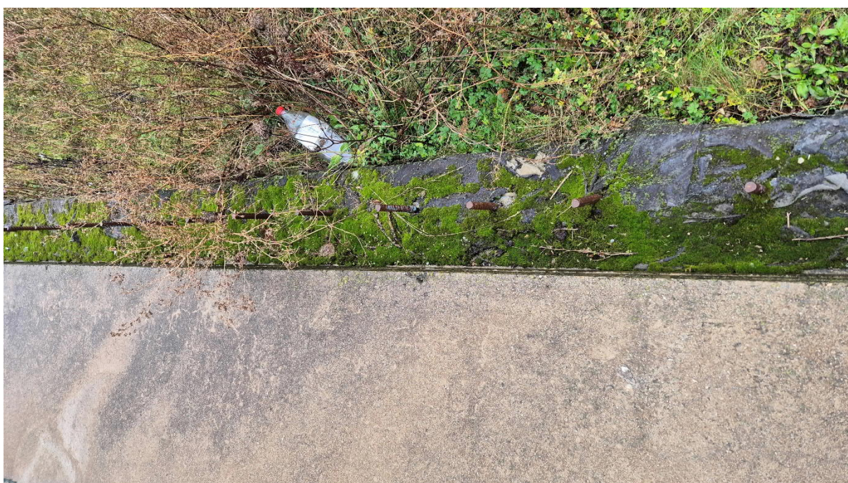
Obr. 4 Degradace betonu a výztuže horního povrchu kapsy pro přechodovou desku
