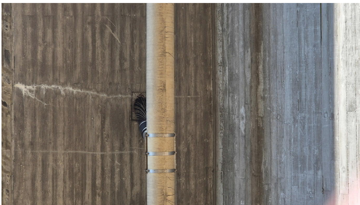
Obr. 14 Trhlina na vnější konzole
