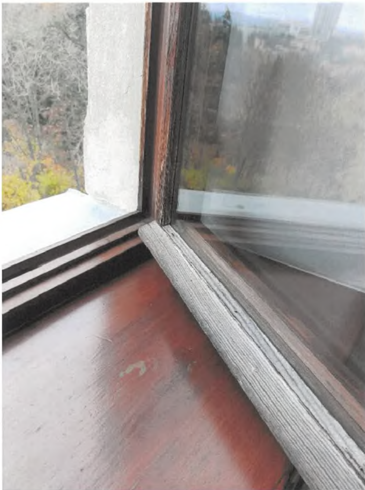
Foto 50 – Interiér – Parapety dřevěné vyhovující – okenní křídlo s degradací nejvíce vodou namáhané okapové lišty
