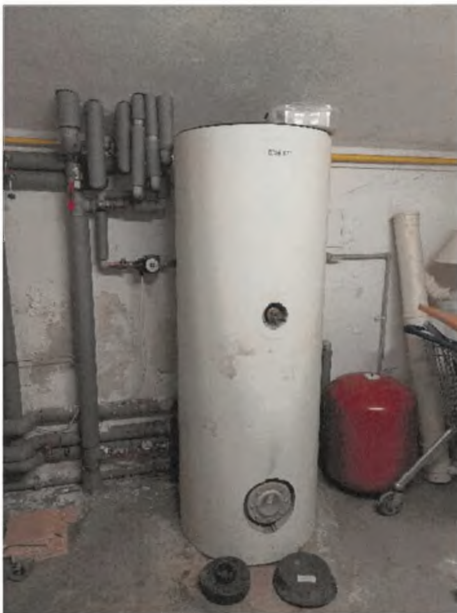
Foto 35 – Interiéry – technická místnost – zásobník TUV + expanzní nádoba vytápění
