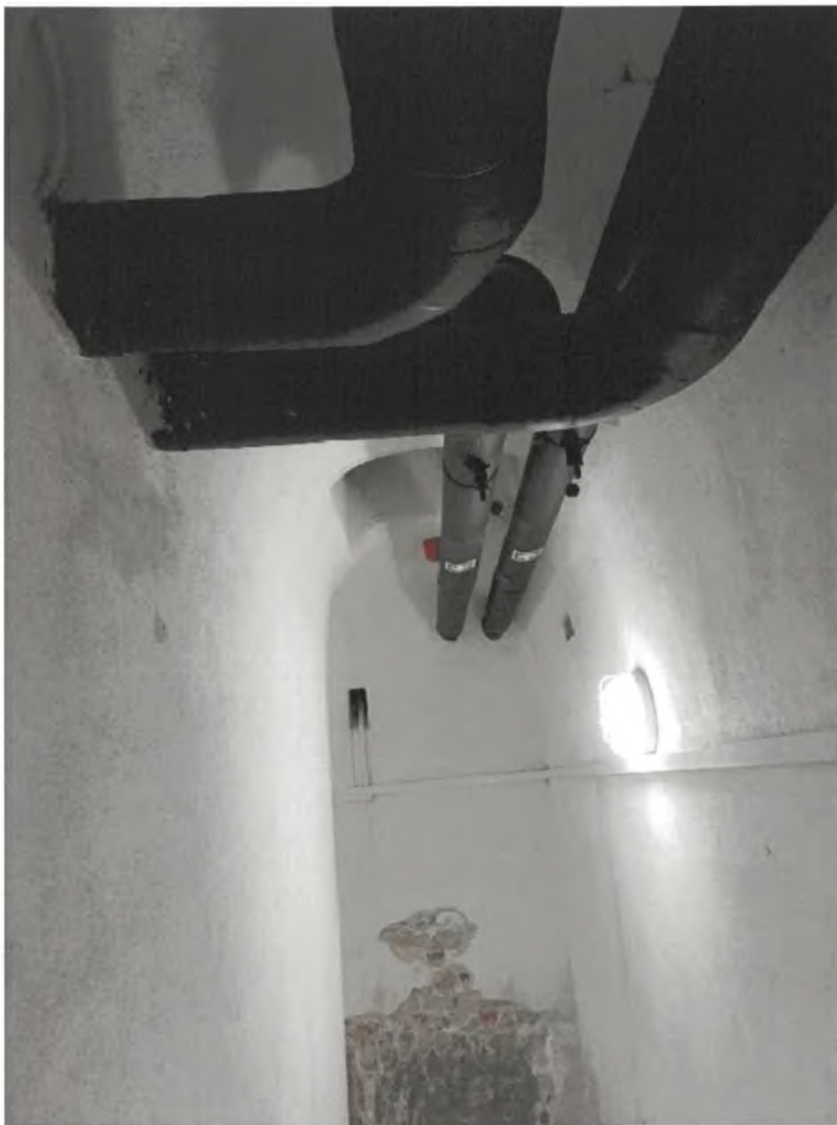
Foto 76 – Interiér – Vlhké sklepy – doporučeno řešit větrání + potrubí čerpadla
