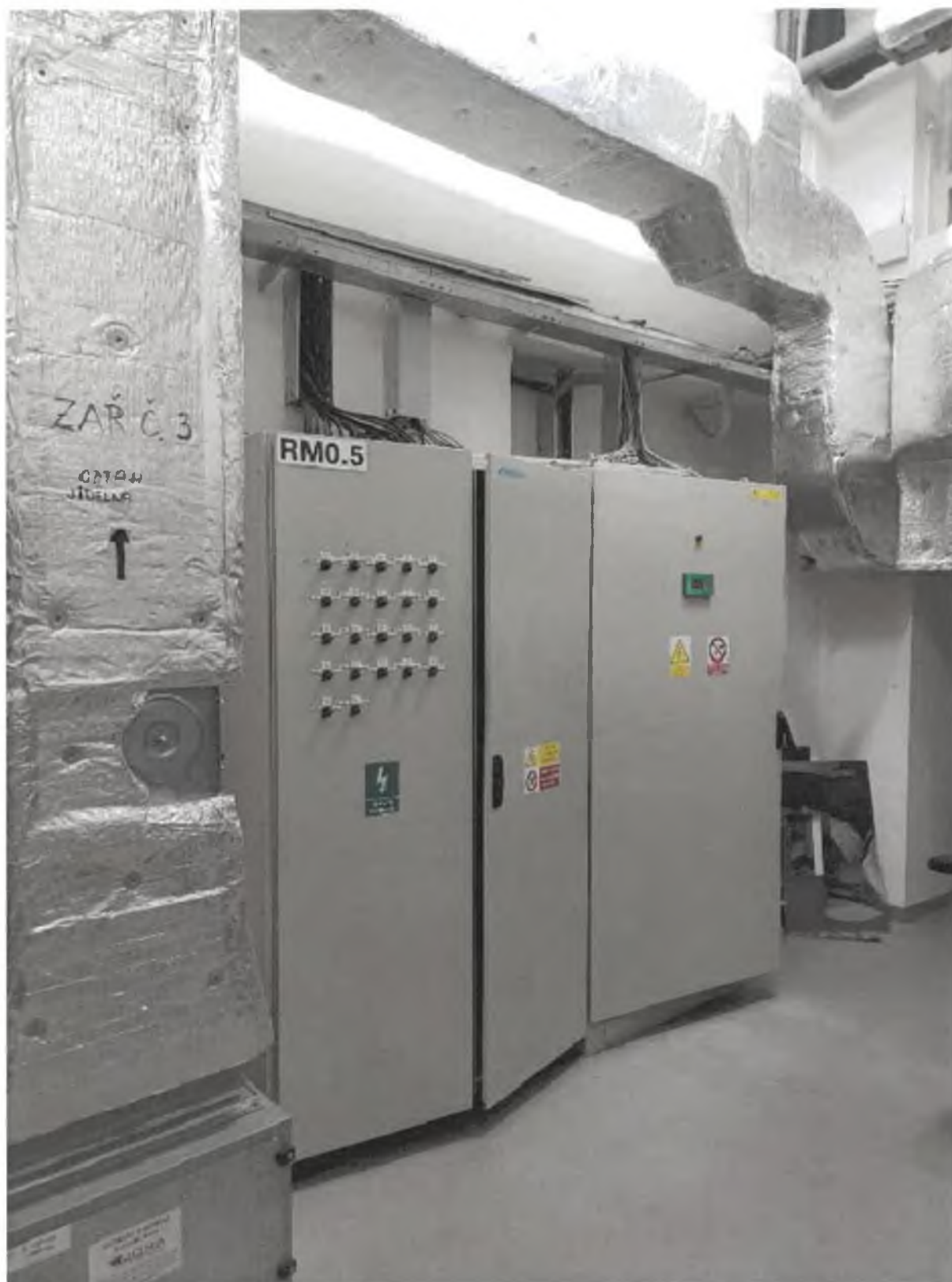
Foto 94 – Interiér – VZT potrubí vyhovující + elektrorozvaděče
