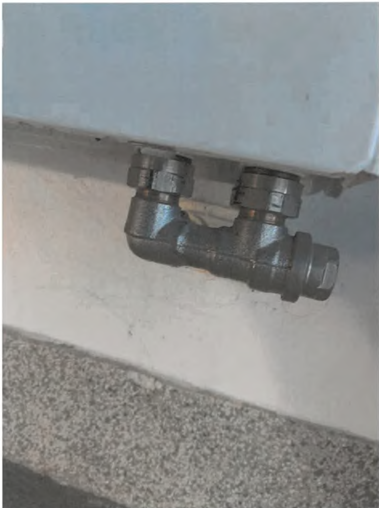
Foto 46 – Interiér – Armatury topného systému těles
