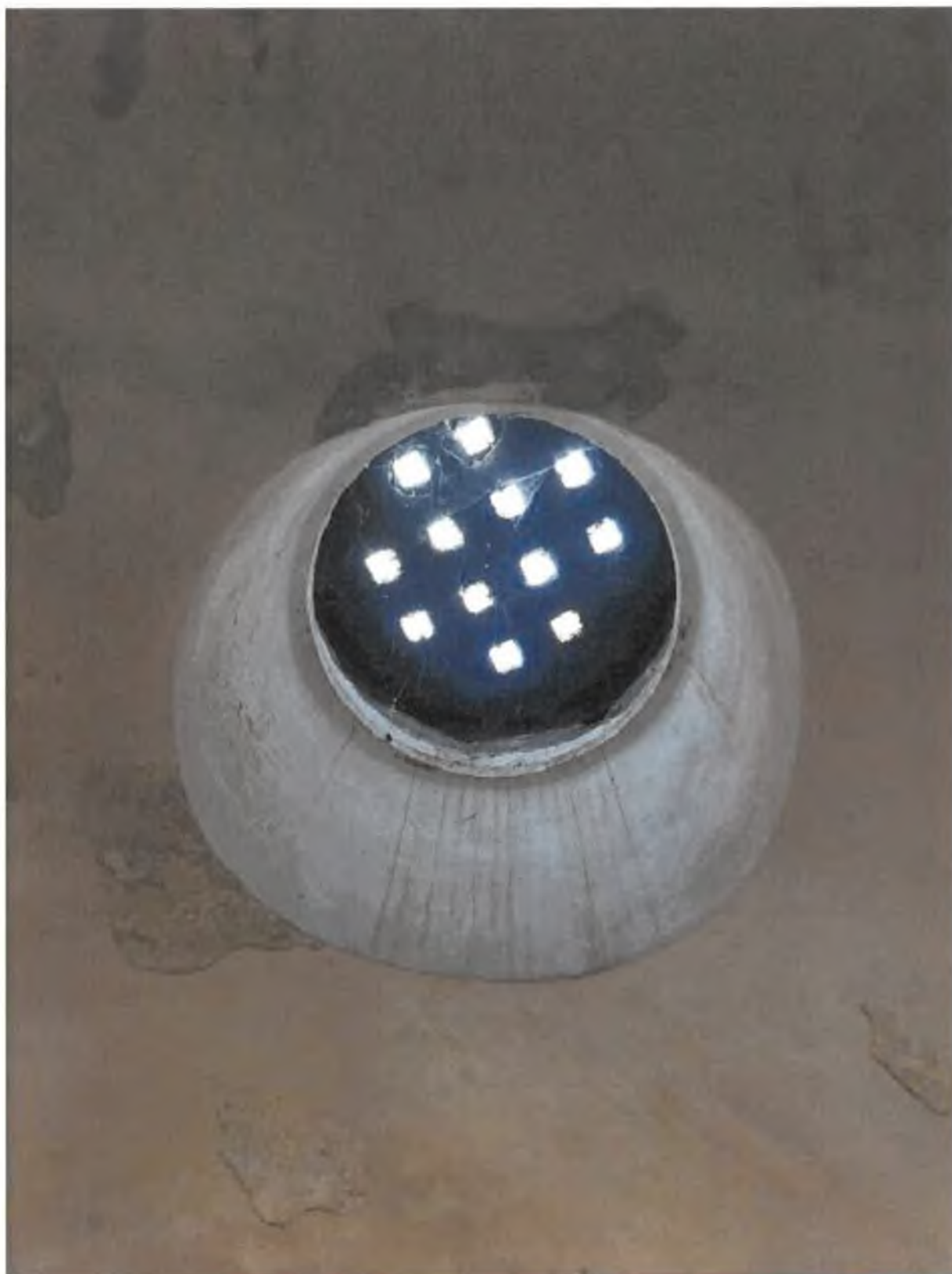
Foto 61 – Interiér – Vlhké sklepy – částečné větrání poklopem
