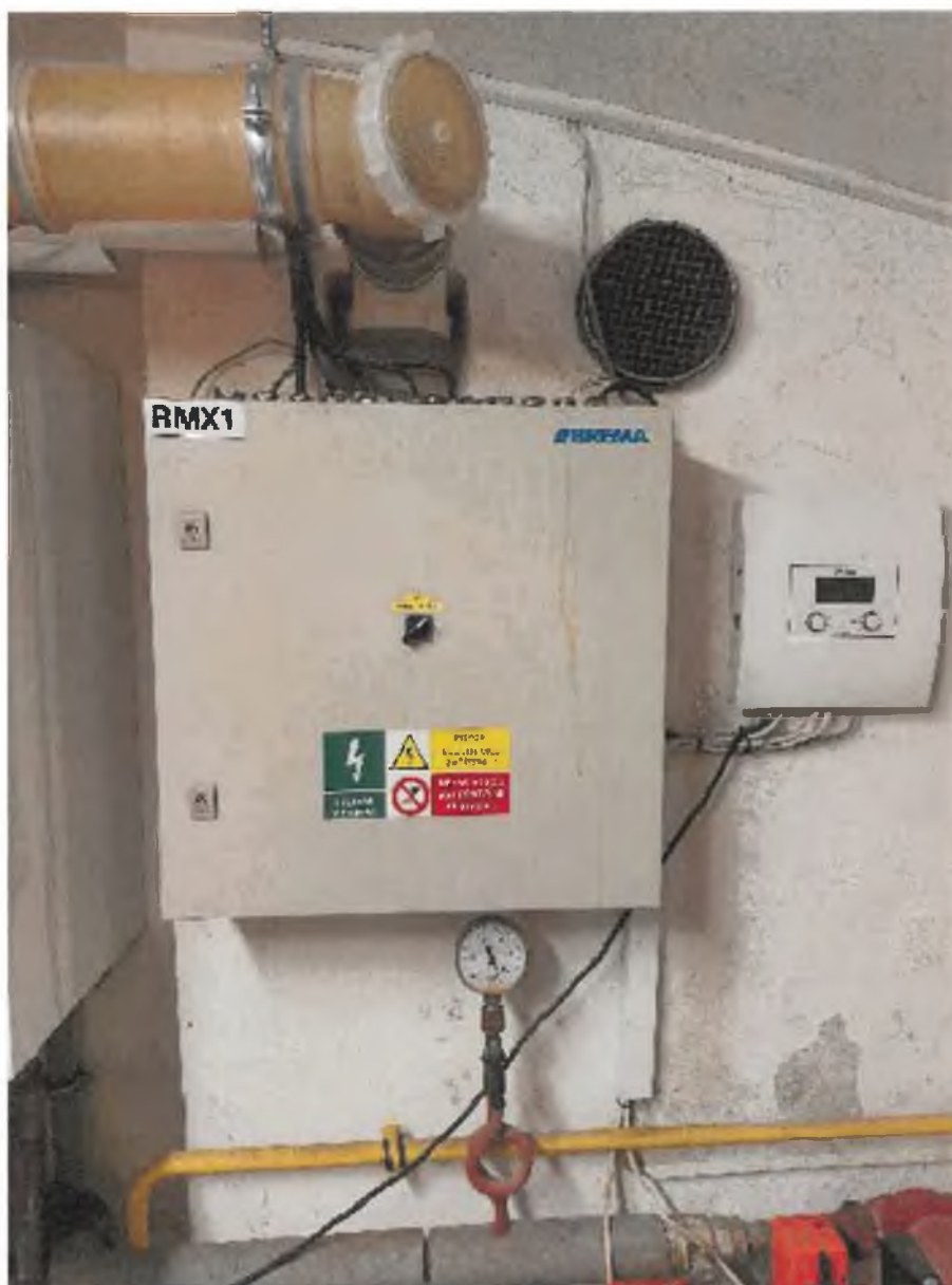
Foto 28 – Interiéry – technická místnost – elektrorozvaděč + odkouření
