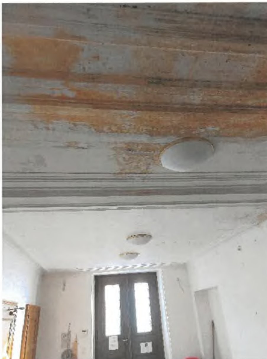
Foto 37 – Interiéry – hlavní vstupní chodba a známky zatékání v do stropu – doporučeno prověřit kompletní stav vodovodu a kanalizace
