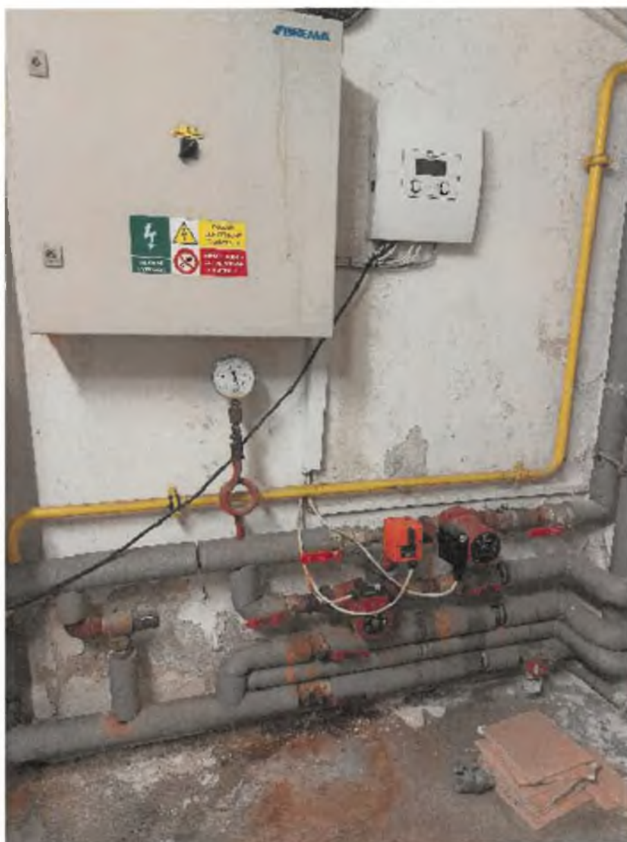
Foto 27 – Interiéry – technická místnost – otopná soustava v kotelně + plynovod a elektrozvaděč – neřešeno odvodnění podlahy technické místnosti
