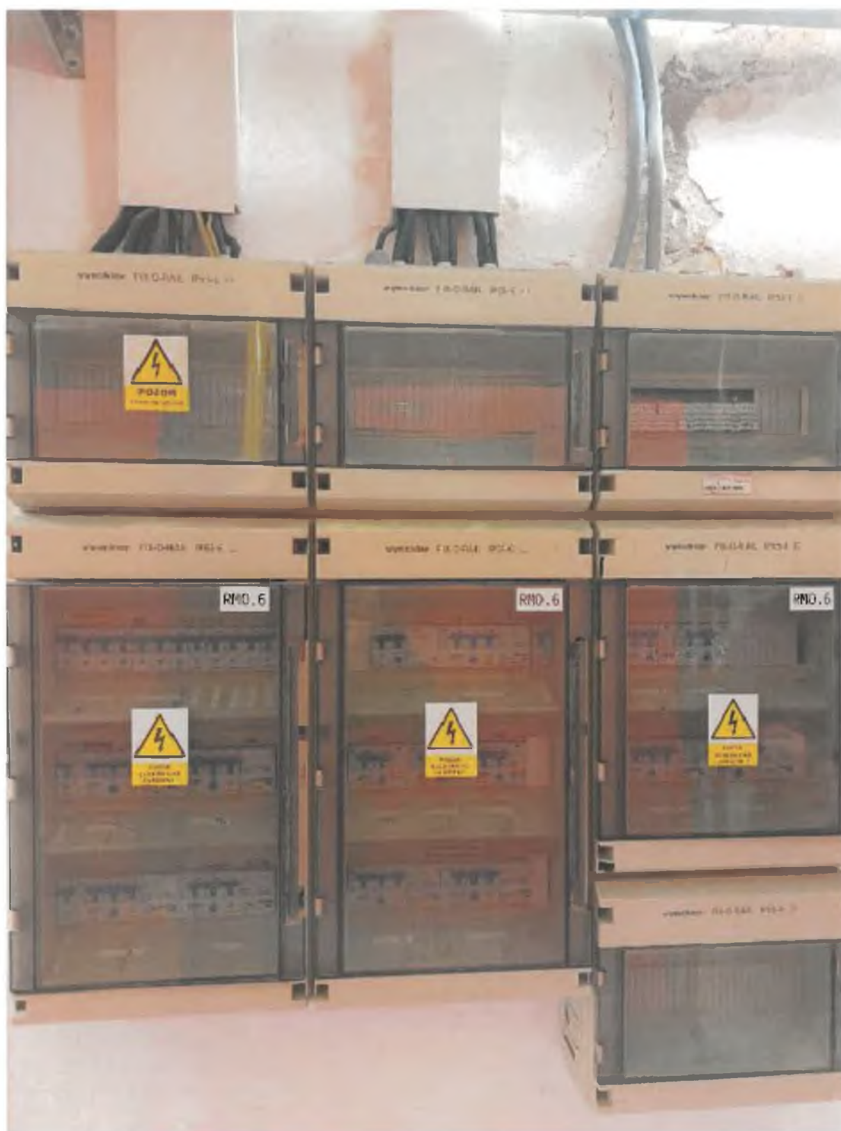
Foto 78 – Interiér – hnízdo rozvaděčů
