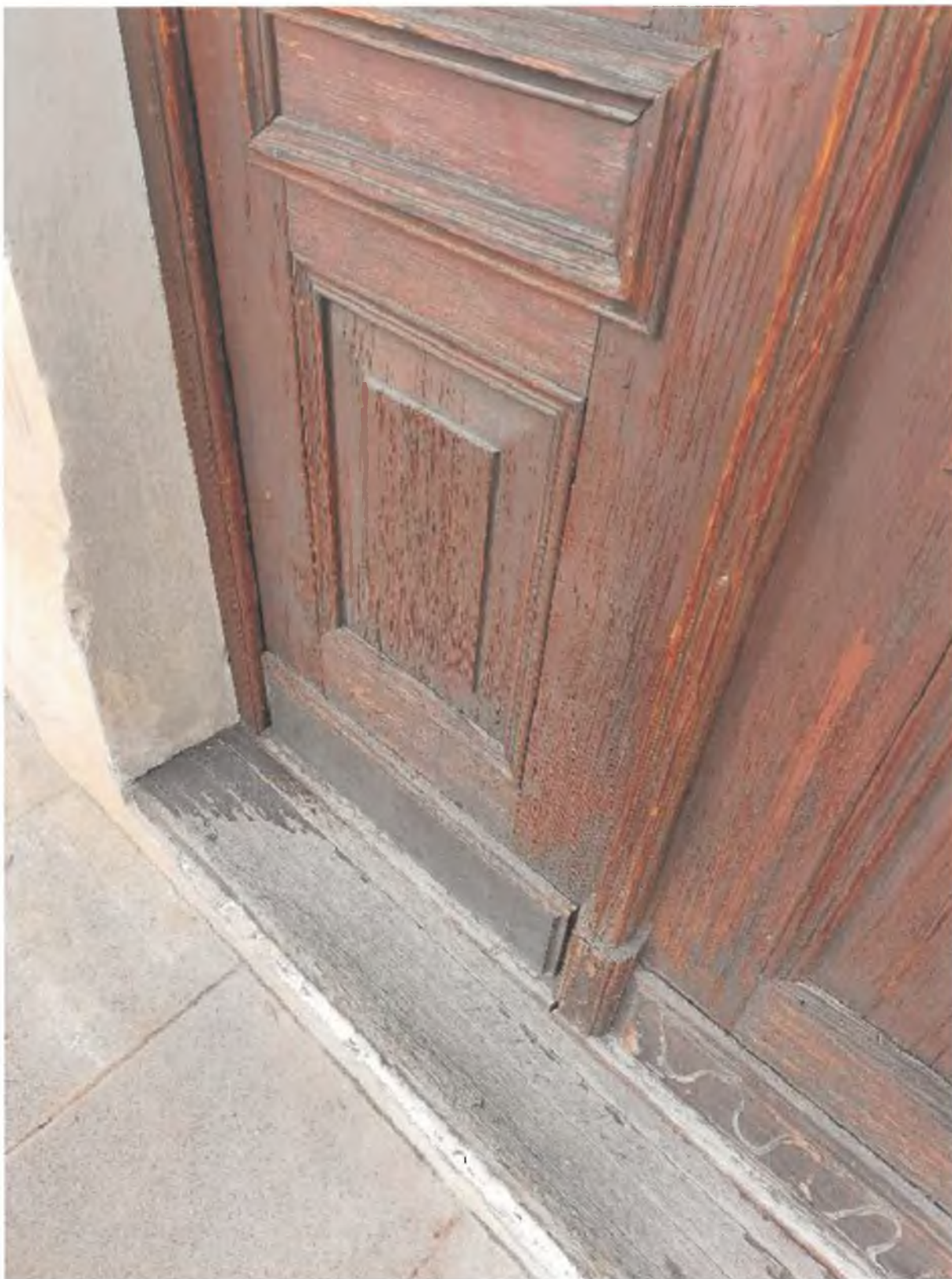
Foto 32 – Výplně otvorů – dveře jižní fasády – rozšiřování vláken dřeva – nevhodná kvalita dřeva
