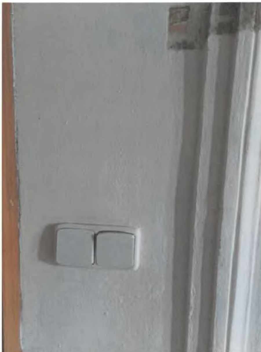
Foto 8 – Interiéry – vyhovující koncové prvky elektroinstalace
