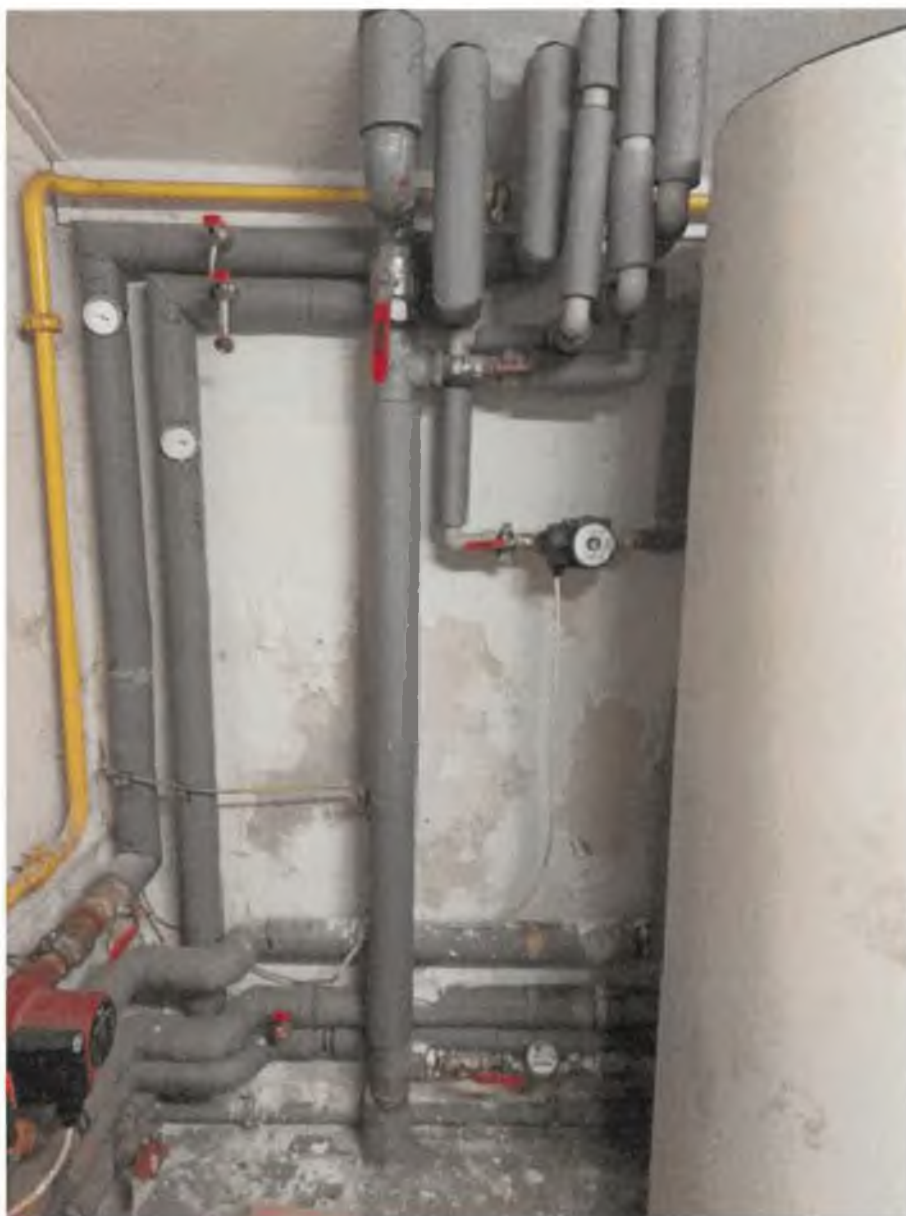
Foto 25 – Interiéry – technická místnost – otopná soustava v kotelně + TUV
