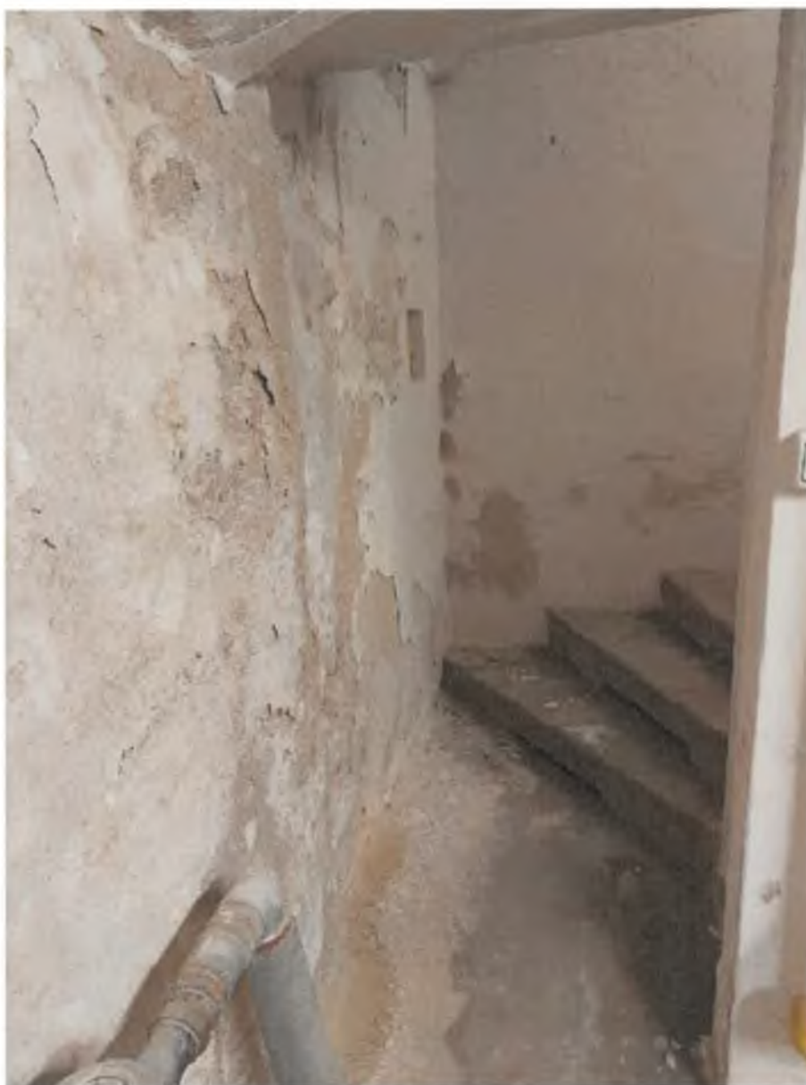
Foto 31 – Interiéry – technická místnost –vlhké podzemní zdivo
