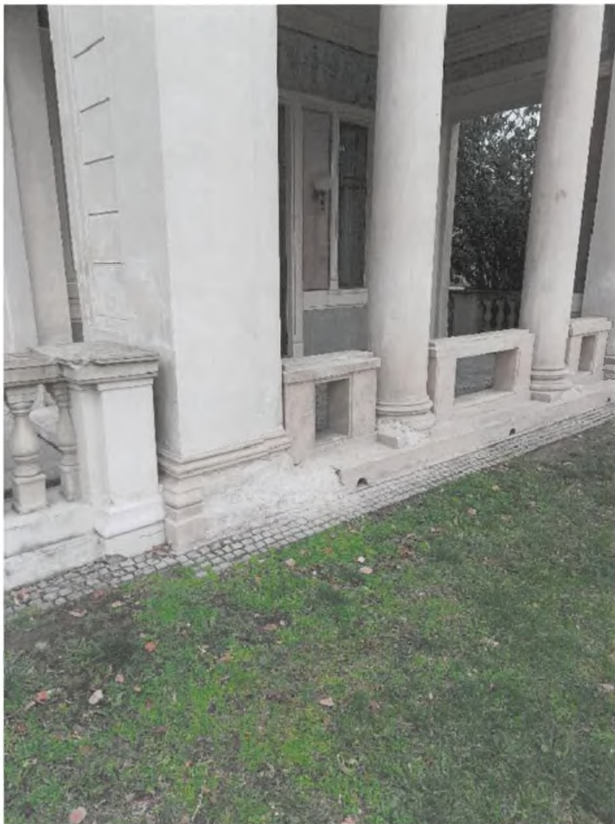
Foto 13 – Fasáda – jižní fasáda - degradace omítky
