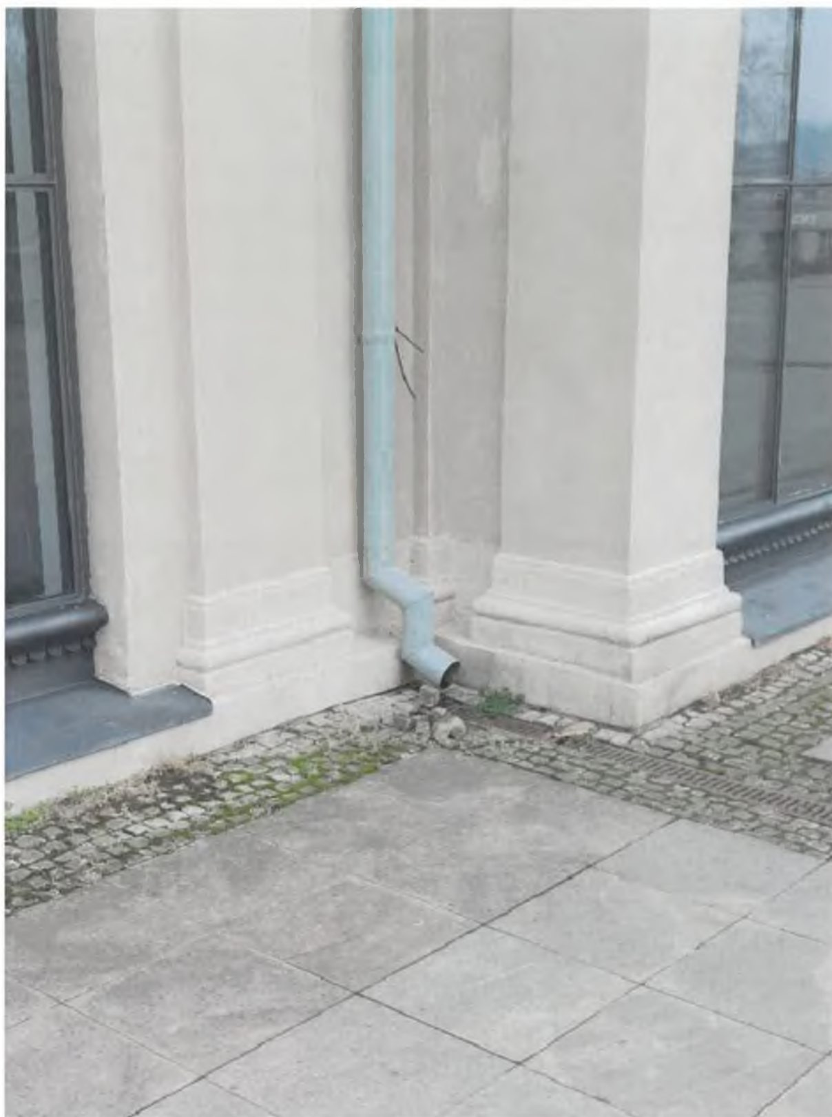
Foto 37 – Venky – Odvodnění dešťů do liniového žlabu, okapový chodníček doporučeno řešit dlažbou
