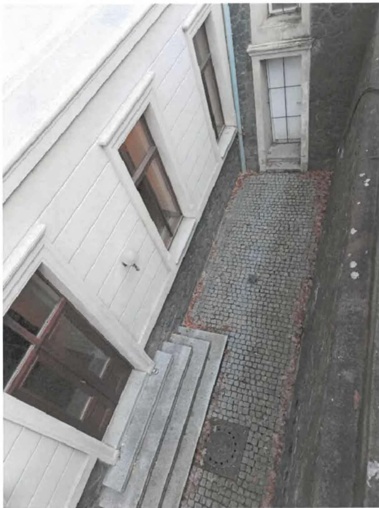
Foto 4 – Fasáda – východní fasáda – zarostlá dlažba mechem
