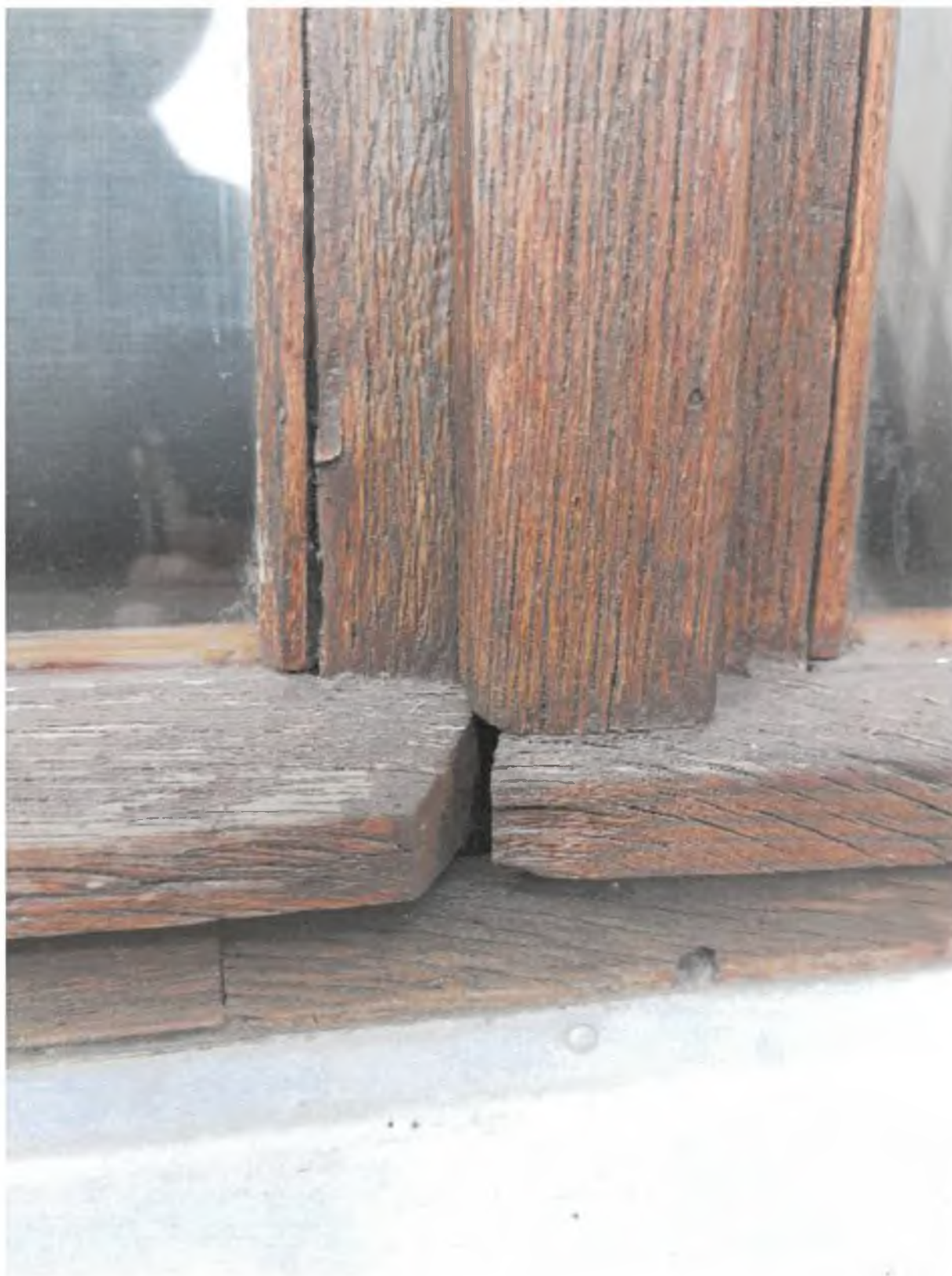
Foto 33 – Výplně otvorů – detail uzavření křídel okna a vlevo viditelný zásah náhradou materiálu – zřejmě provedeno při posledních stavebních úpravách v rámci repase
