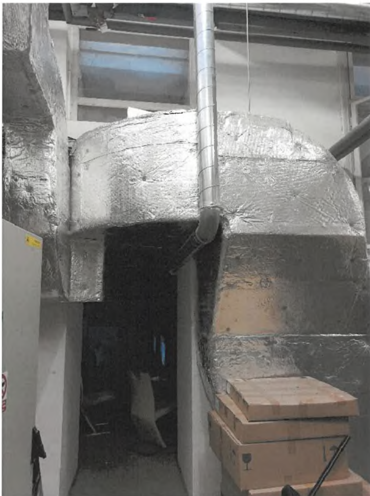
Foto 93 – Interiér – VZT potrubí vyhovující
