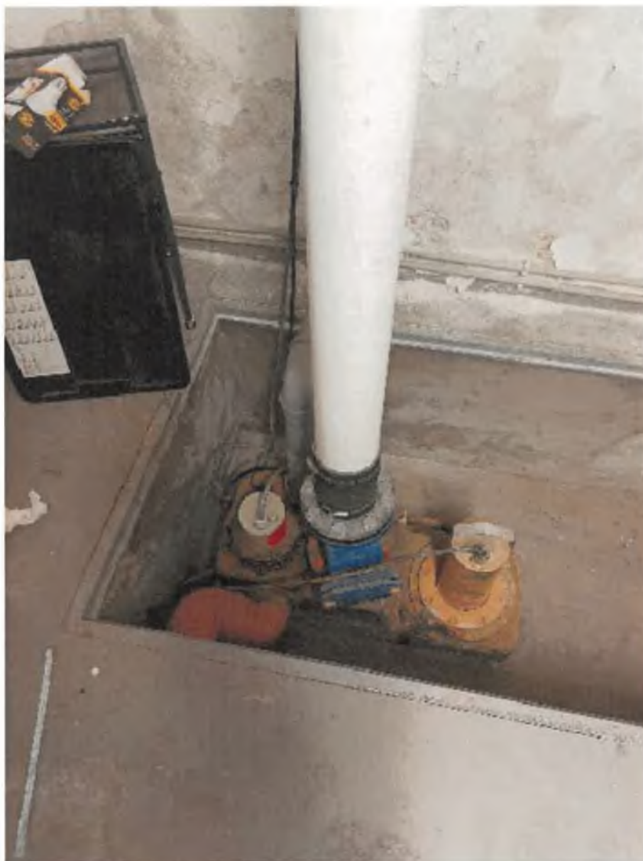
Foto 29 – Interiéry – technická místnost – přečerpávání splaškových vod
