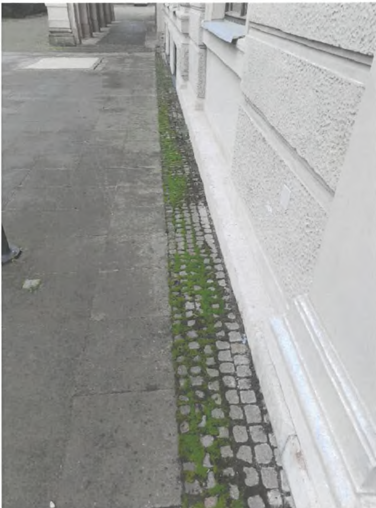
Foto 44 – Venky – Okapový chodníček nevhodně proveden z dlažby kamenné. Toto řešení umožňuje zasakovat vody přímo u objektu, který nemá hydroizolace. V případě výměny okapového chodníku z kamenných kostek na dlaždice by se voda odvedla od objektu, což je žádoucí.
