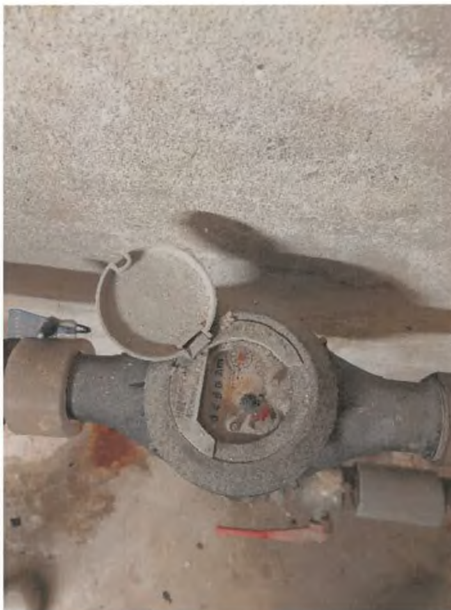
Foto 30 – Interiéry – technická místnost –vodoměr
