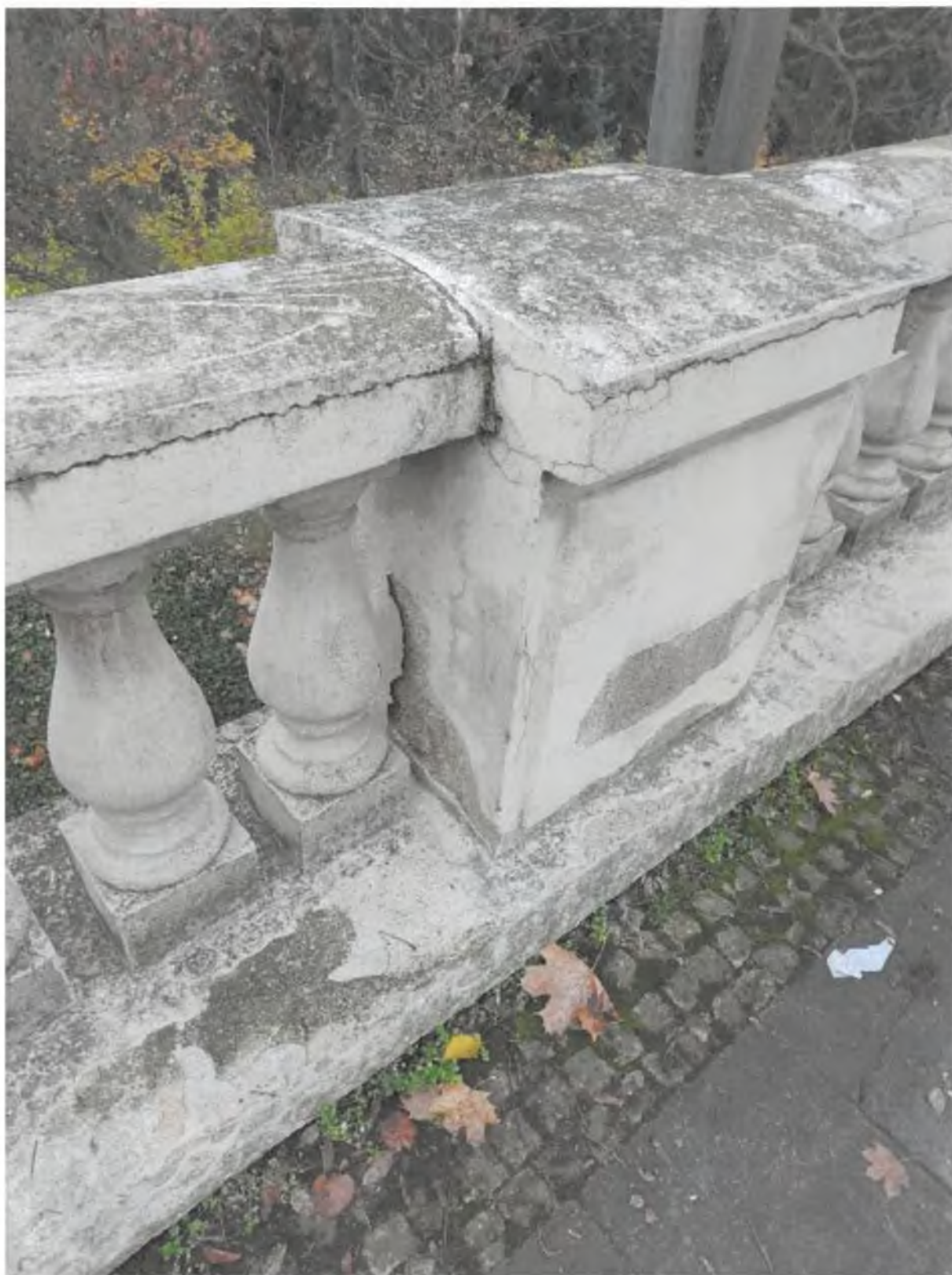
Foto 41 – Venky – Balustrády degradované omítky
