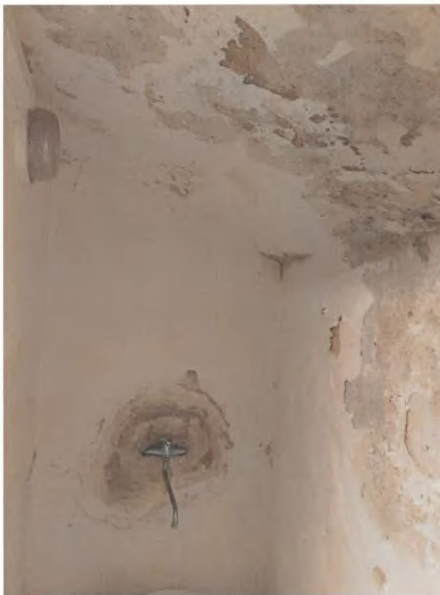
Foto 32 – Interiéry – technická místnost –vlhké podzemní zdivo – zatékání kolem vodovodní baterie – možné průsaky potrubím
