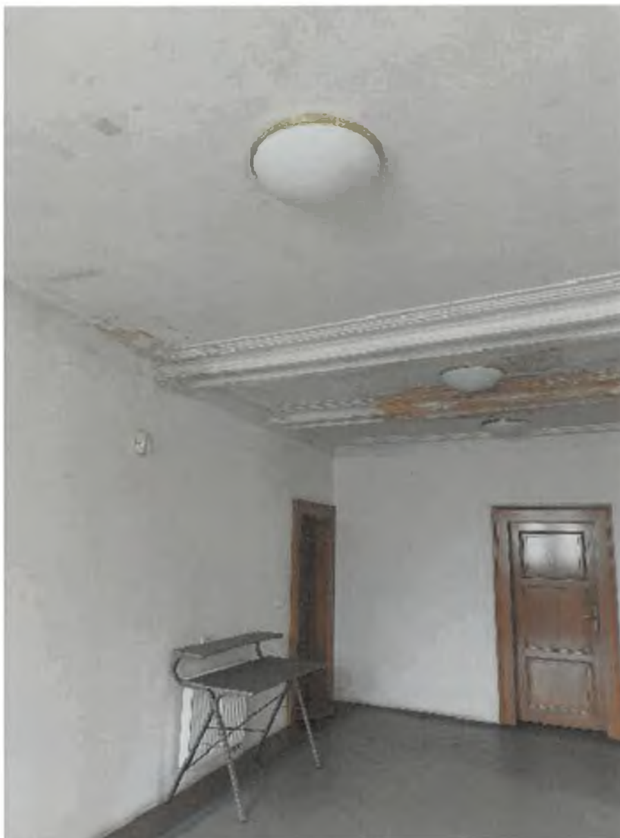
Foto 12 – Interiéry – podhledy v hlavní chodbě – nutno odstranit příčinu zatékání + provést sanaci a výmalbu povrchů
