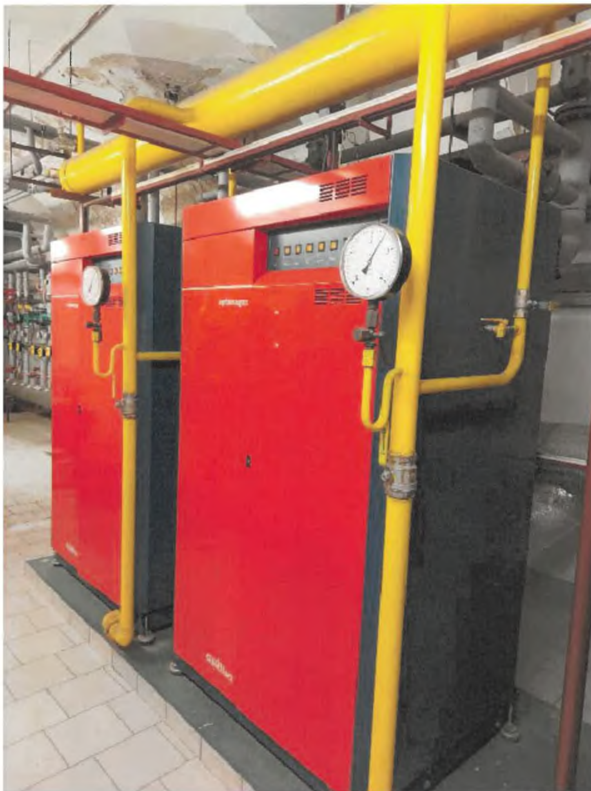
Foto 99 – Interiér – vytápění a ohřev TUV, kotle plynové
