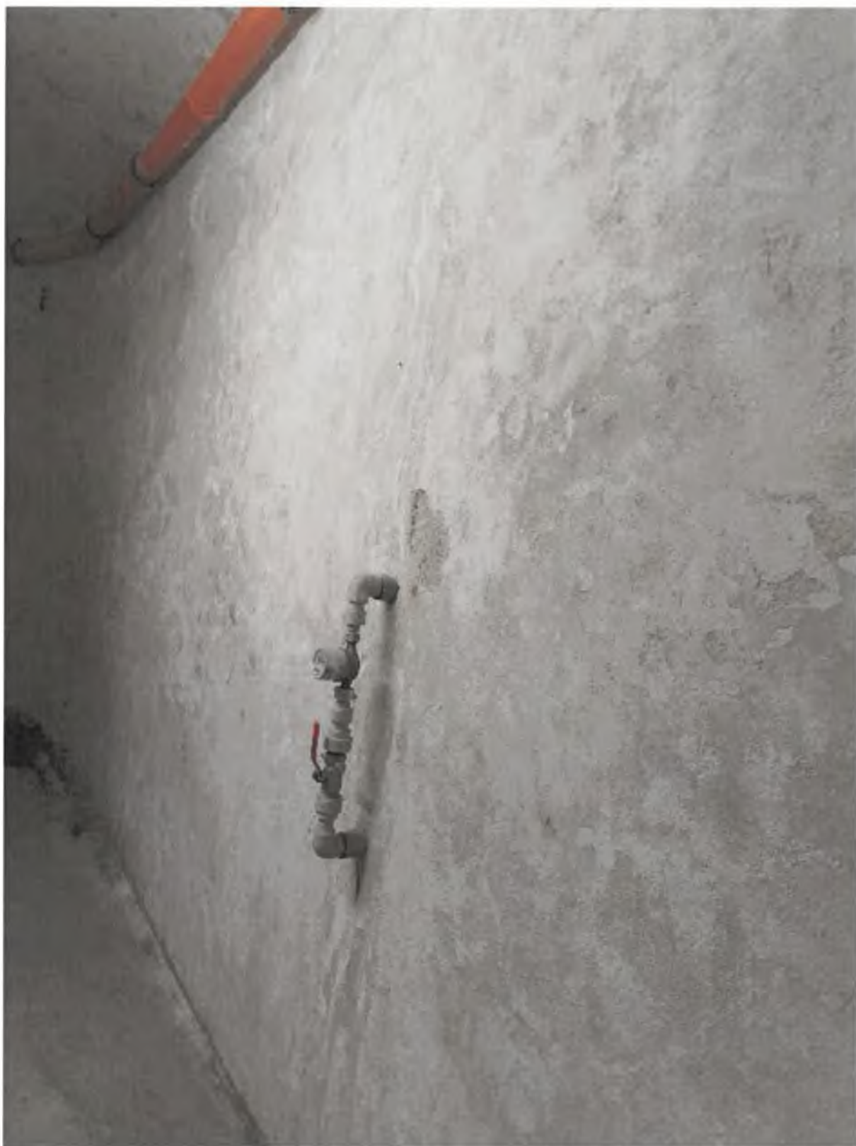
Foto 59 – Interiér – Vlhké sklepy – doporučeno řešit větrání sklepů + podružný vodoměr
