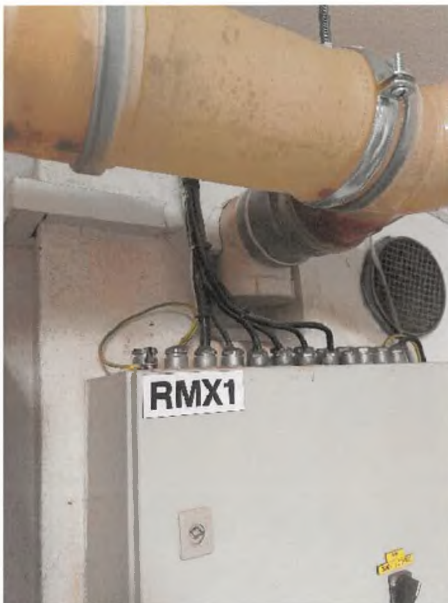
Foto 15 – Interiéry – technická místnost – viditelný rozvaděč elektroinstalace + odkouření plynových kotlů
