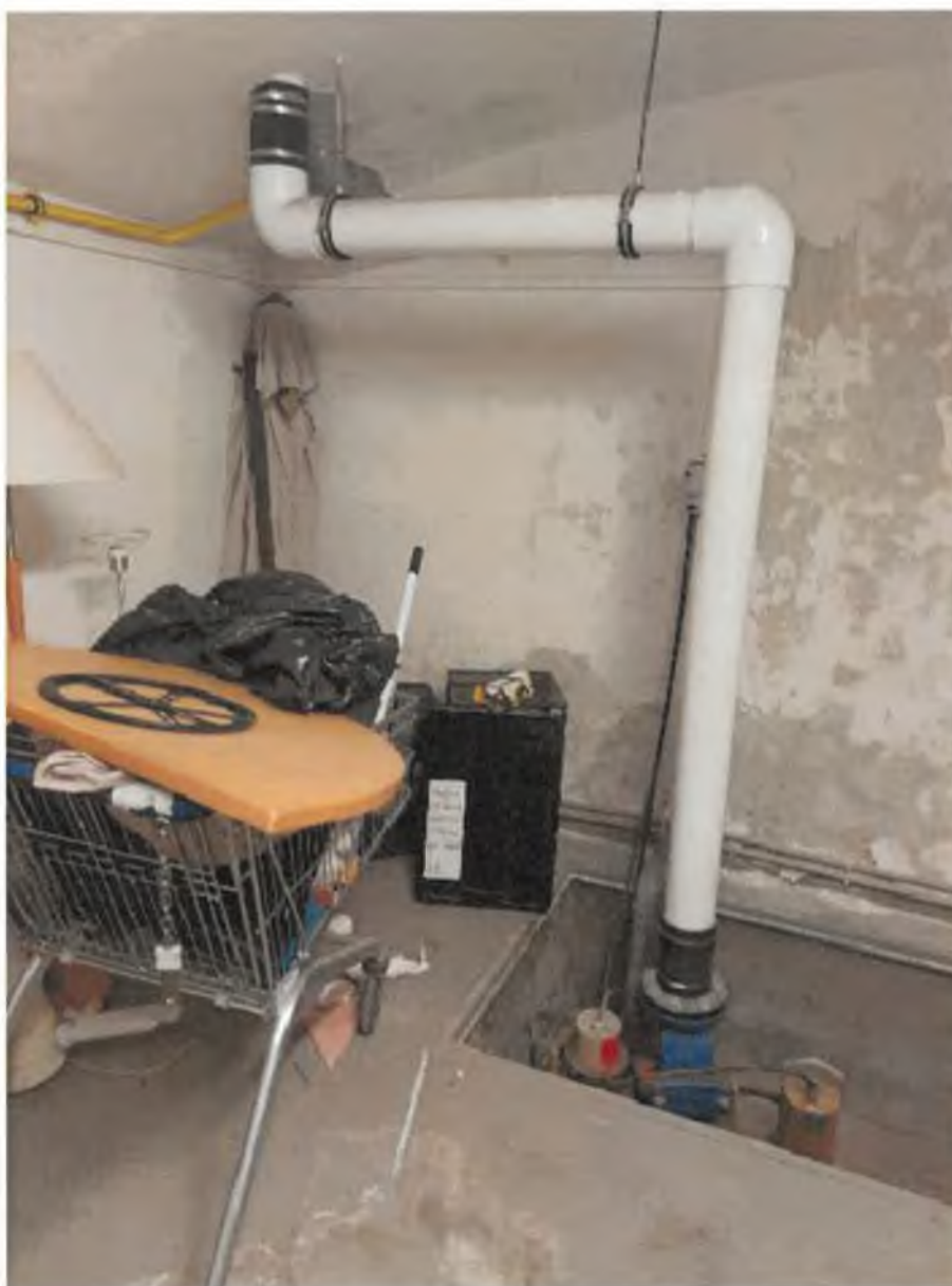
Foto 36 – Interiéry – technická místnost – odkanalizování do přečerpávací stanice
