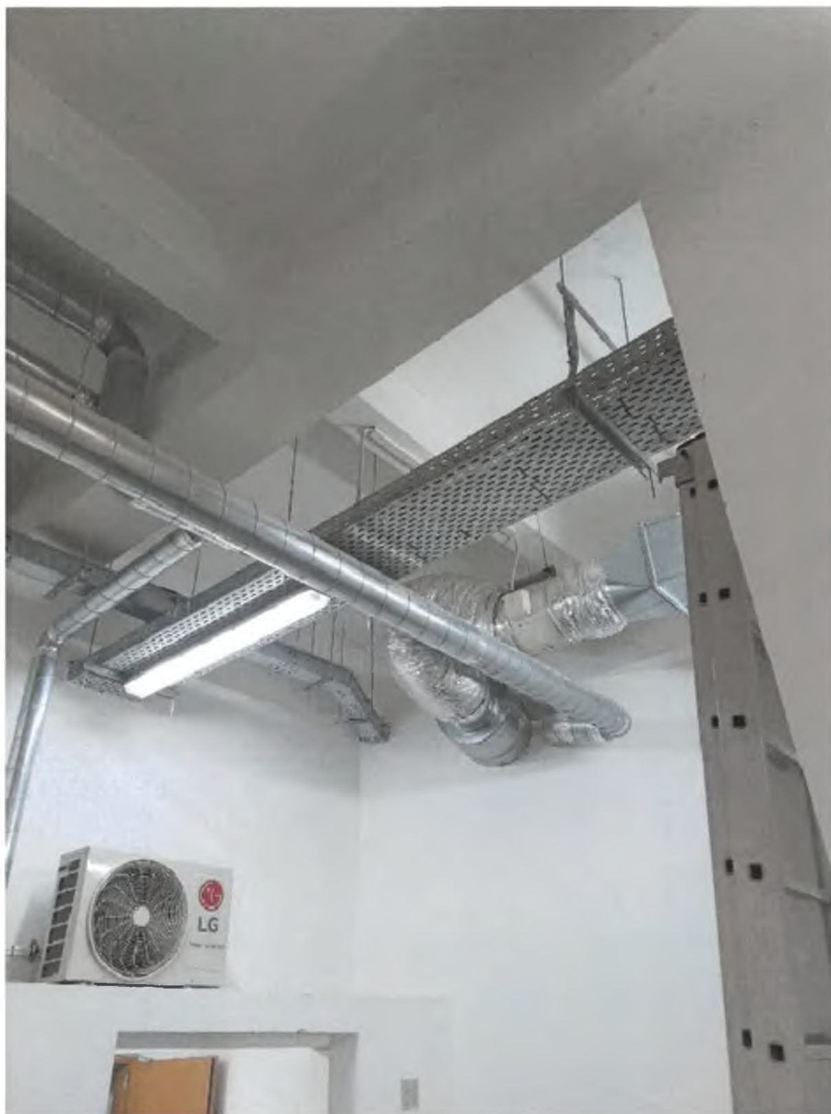
Foto 87 – Interiér – potrubí VZT, plynu, elektro, v technických částech
