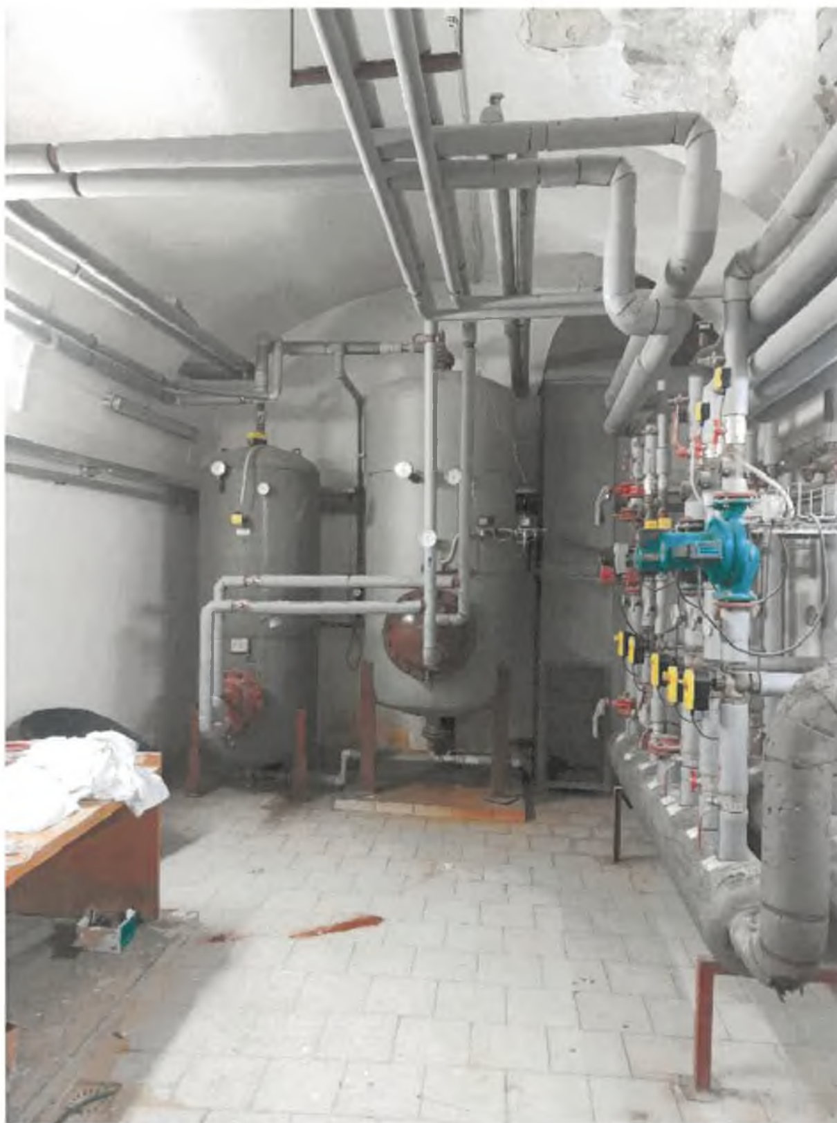
Foto 97 – Interiér – vytápění a ohřev TUV – doporučeno v budoucnu vyměnit TUV zásobníky
