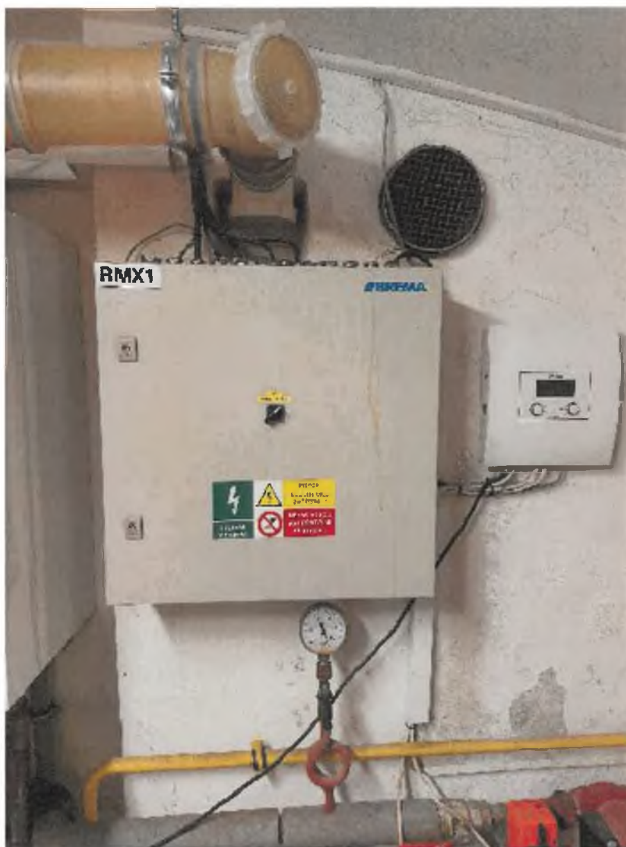
Foto 28 – Interiéry – technická místnost – elektrorozvaděč + odkouření
