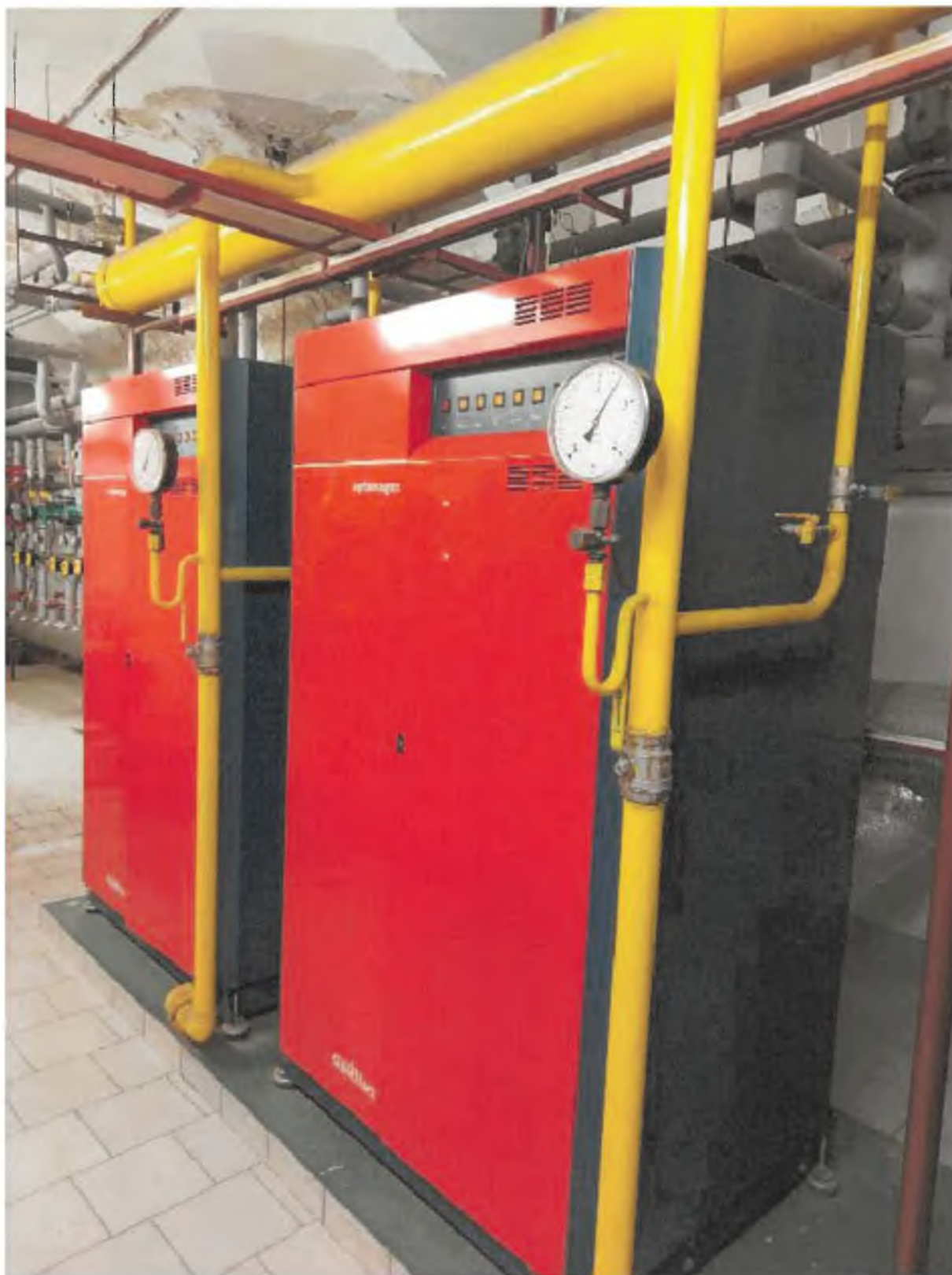
Foto 99 – Interiér – vytápění a ohřev TUV, kotle plynové
