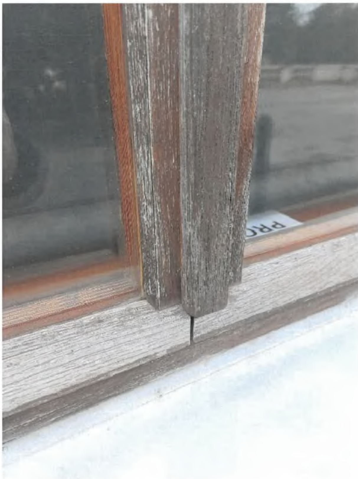
Foto 25 – Výplně otvorů – parapet lakovaný pozink – okenní rám bez drážky pro parapet, nedostatečně řešení tmelením
