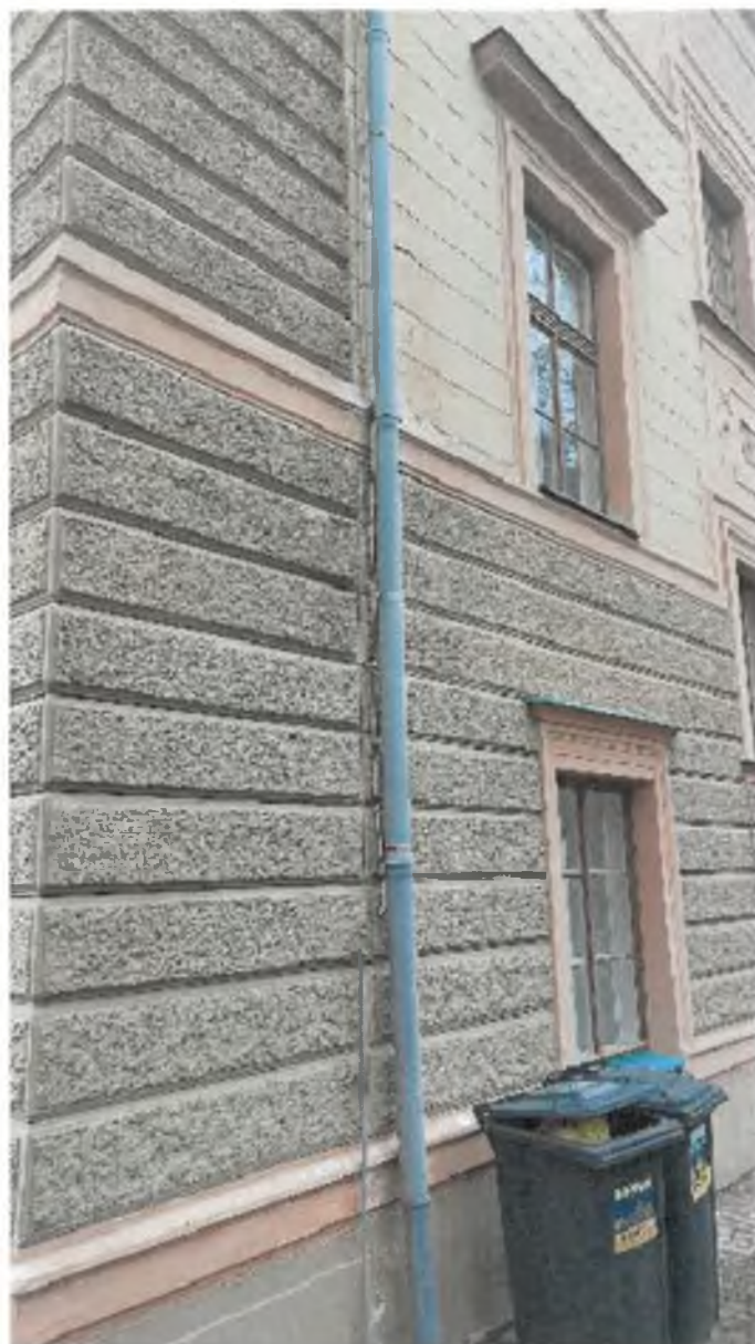
Foto 7 – Výplně otvorů – okna a ostění
