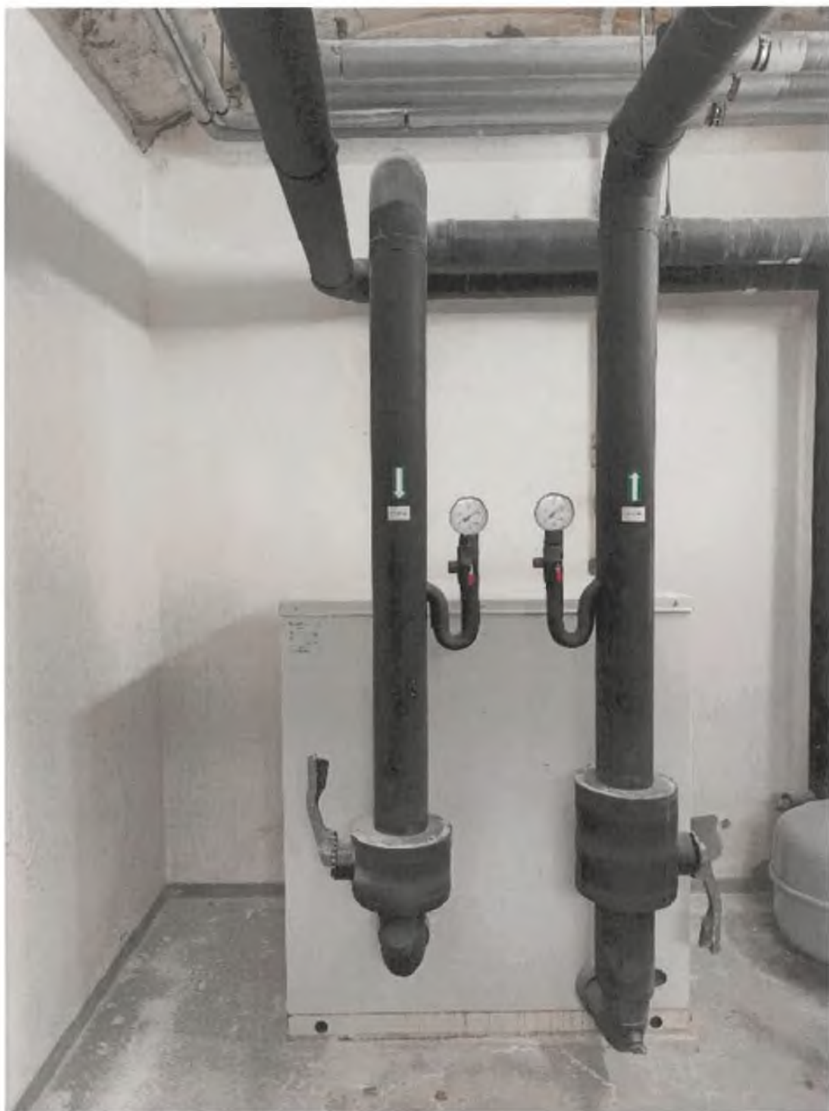
Foto 56 – Interiér – tepelné čerpadlo
