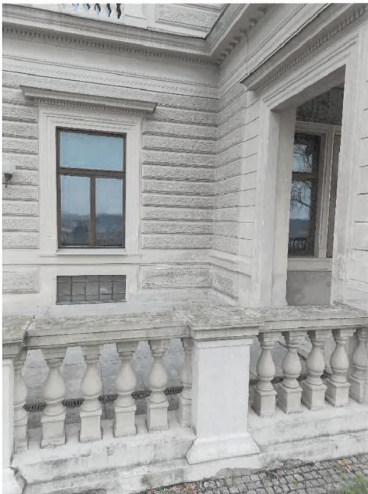
Foto 5 – Fasáda – jižní fasáda – odpadaná omítka nad terénem vlivem vlhkosti a již nefunkčních sanačních omítek
