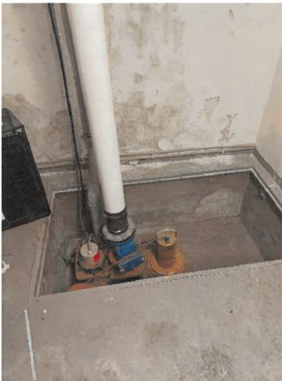
Foto 34 – Interiéry – technická místnost – přečerpávací stanice splaškových vod
