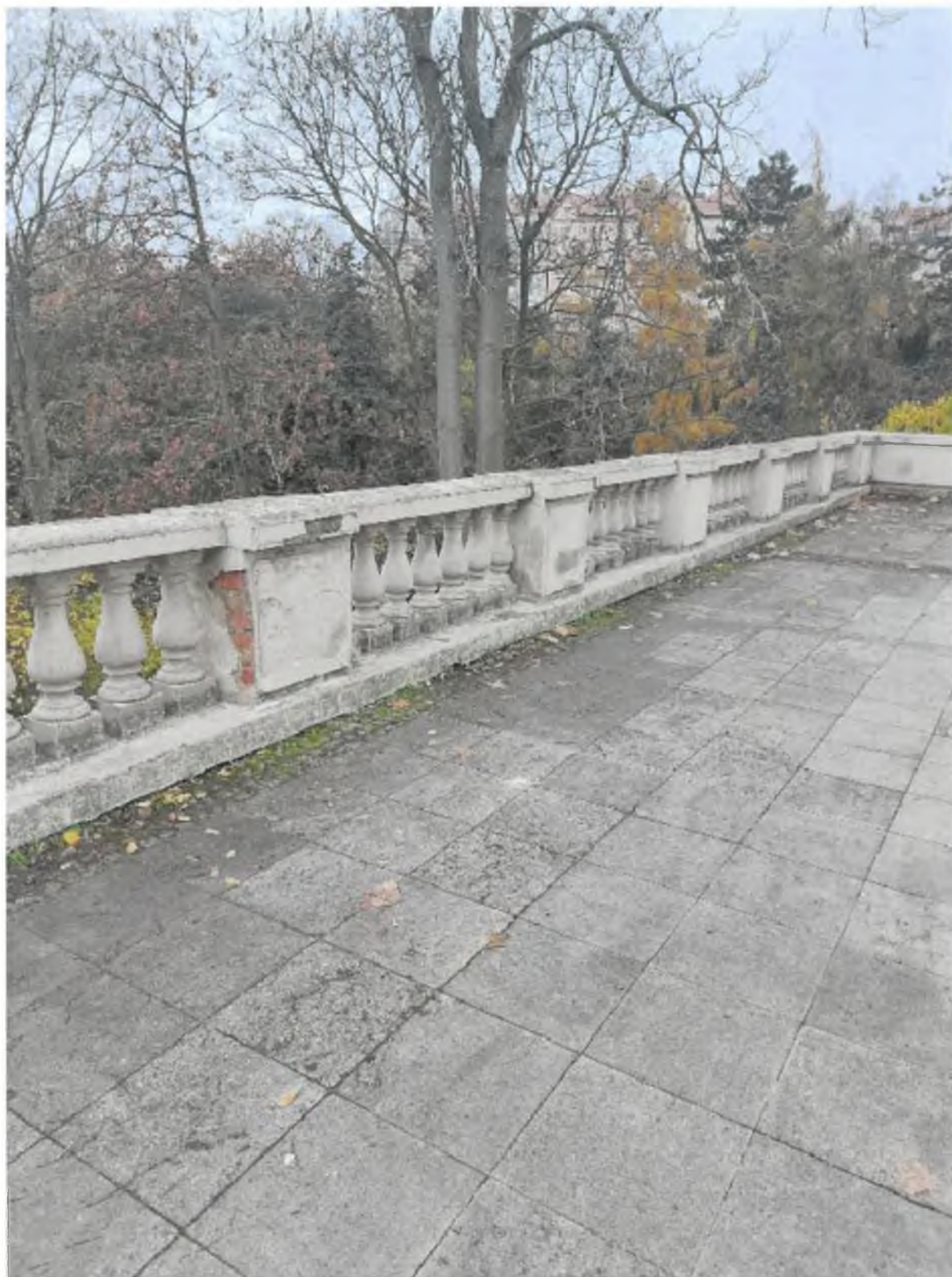
Foto 38 – Venky – Balustrády degradované omítky
