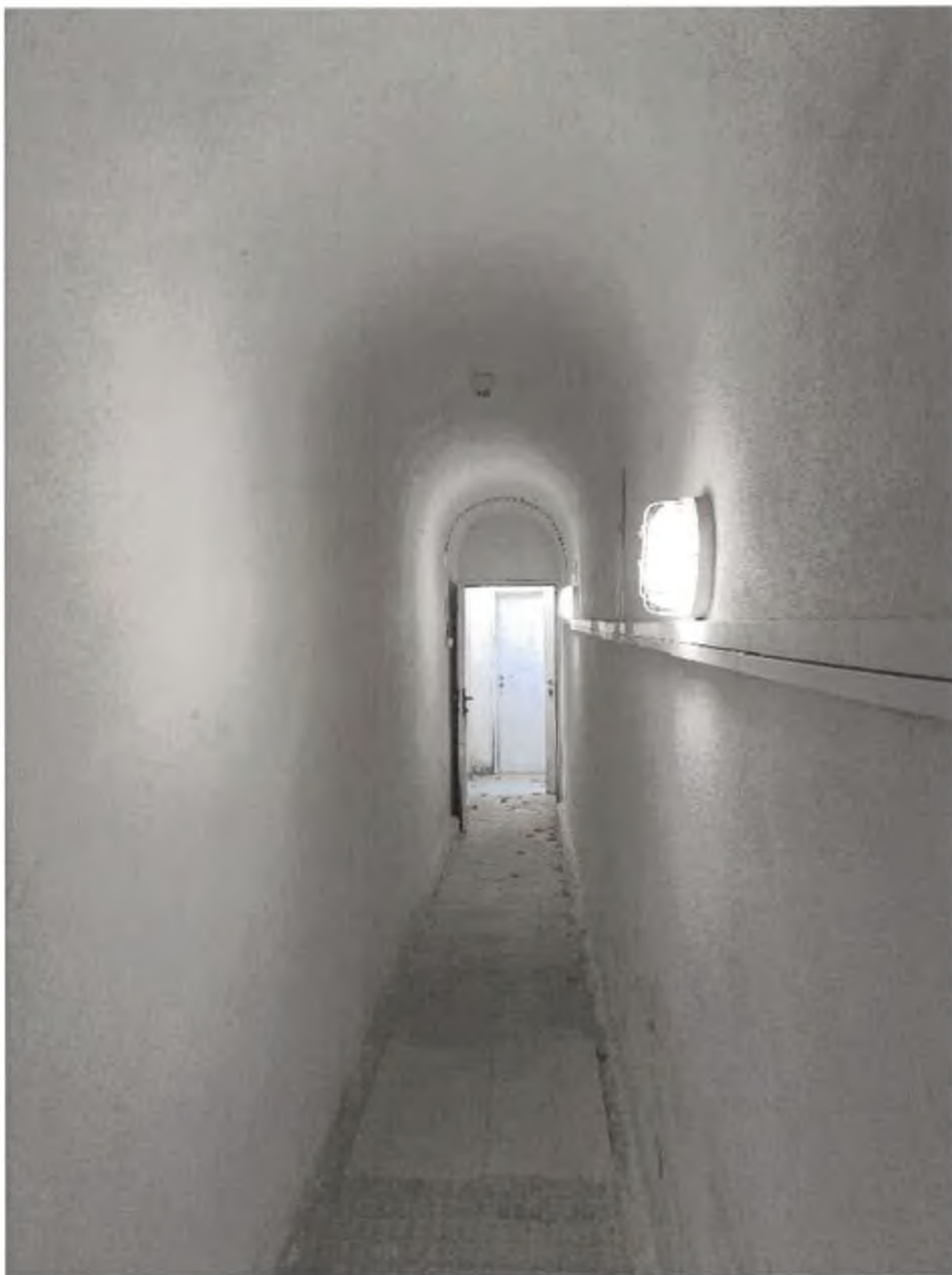
Foto 57 – Interiér – Vlhké sklepy – doporučeno řešit větrání sklepů
