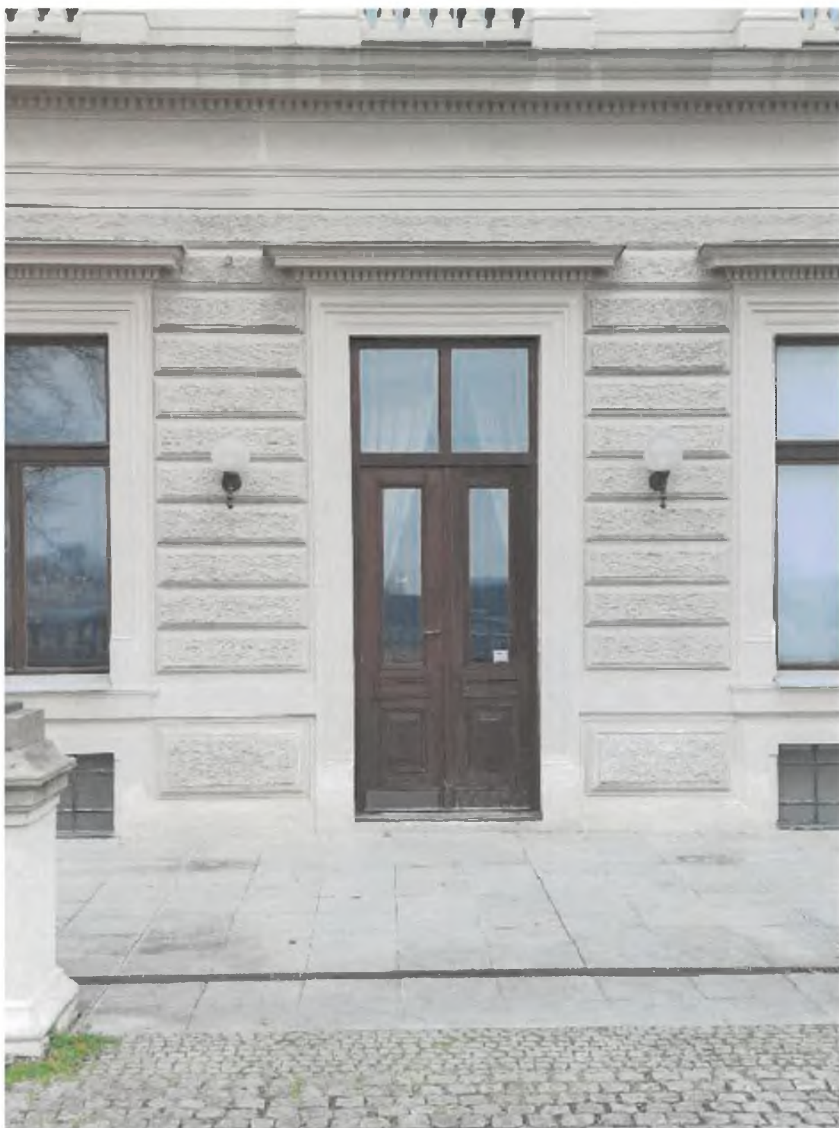
Foto 22 – Fasáda – jižní fasáda - degradace omítky – viditelný rozdíl materiálů již nefunkční sanační omítky nad terénem a v ploše
