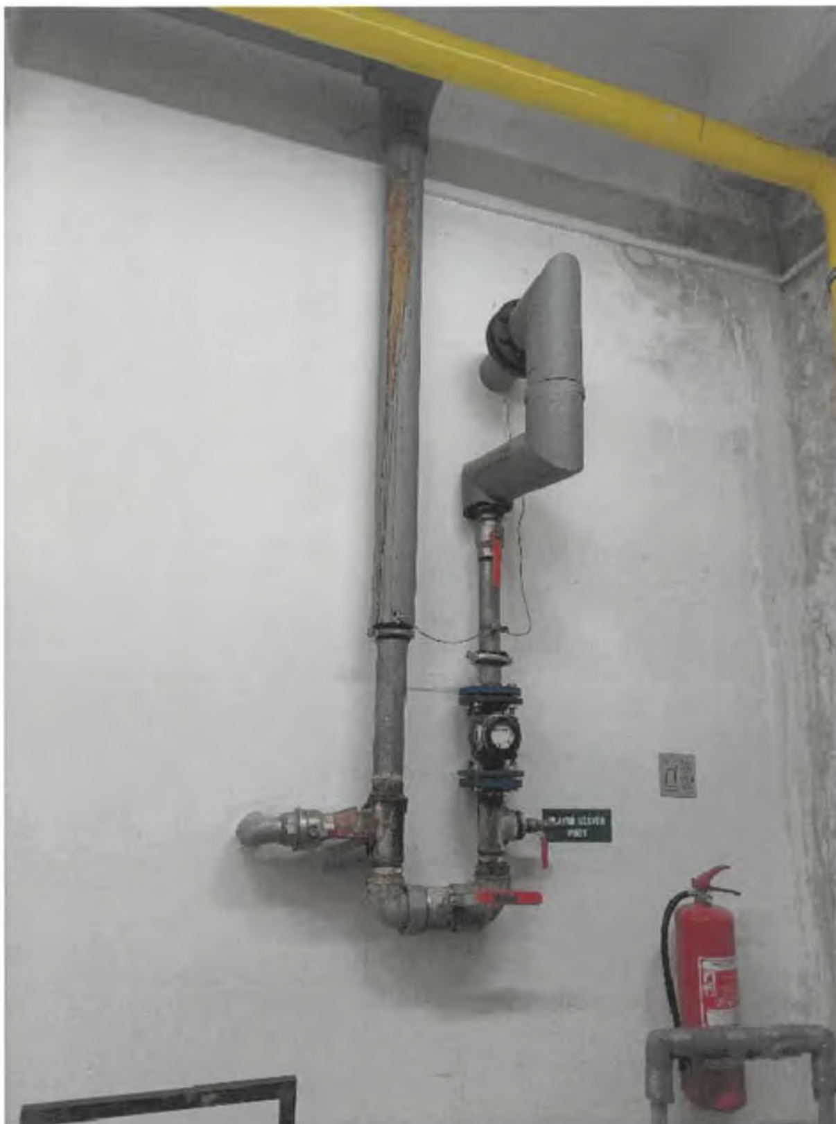
Foto 82 – Interiér – hlavní uzávěr vody – vyhovující, známky protékání
