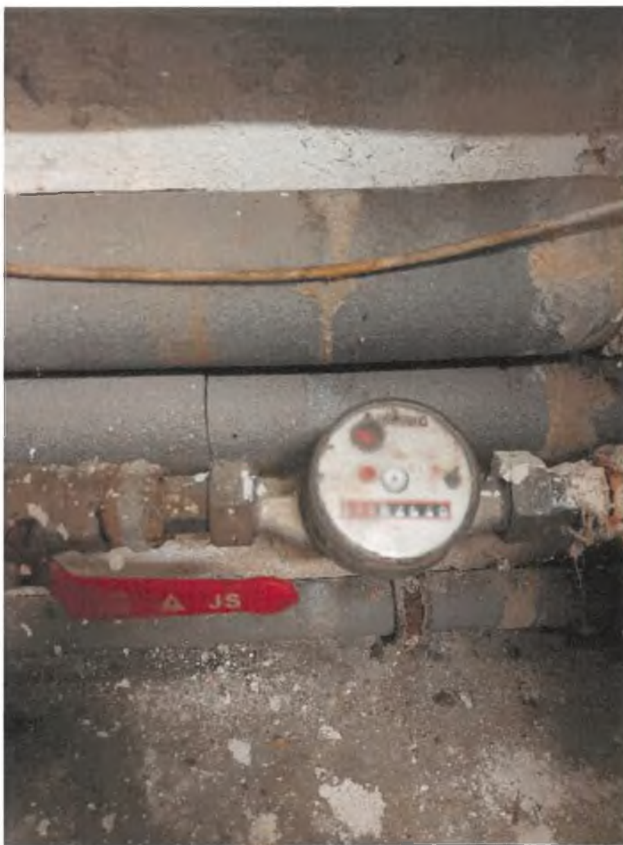
Foto 24 – Interiéry – technická místnost – vodoměr
