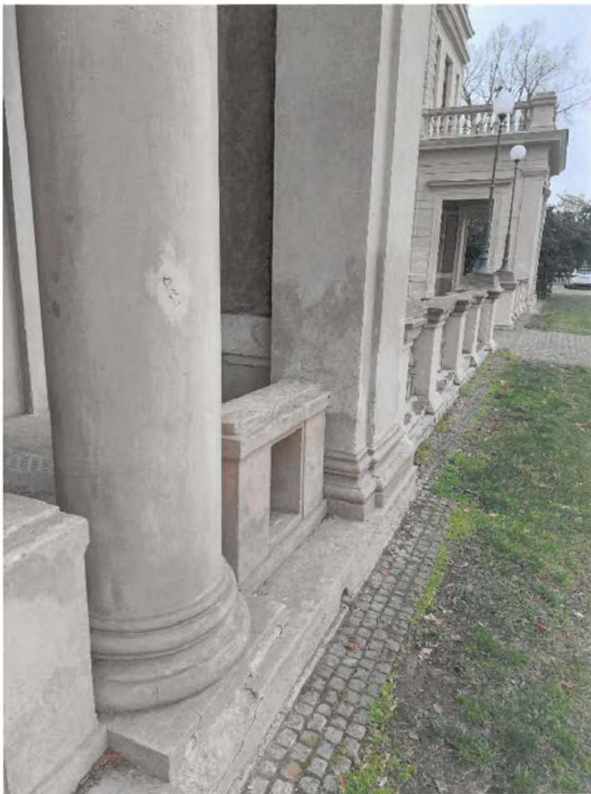
Foto 20 – Fasáda – jižní fasáda - degradace omítky
