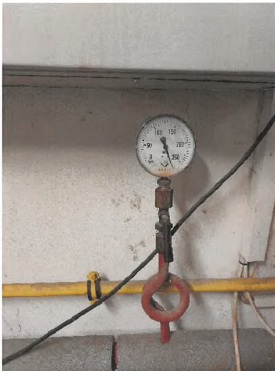
Foto 22 – Interiéry – technická místnost – barometr otopné soustavy
