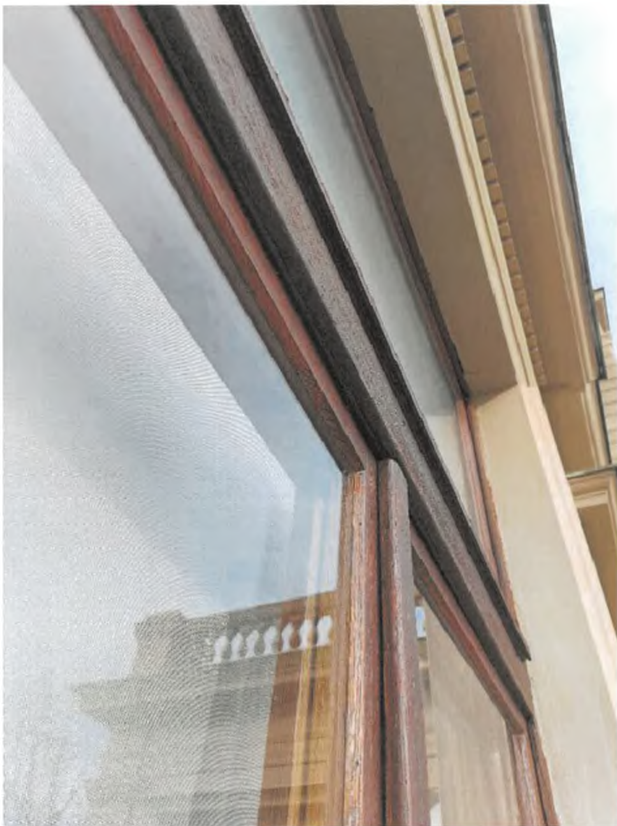
Foto 27 – Výplně otvorů – zkroucená okenní křídla nedoléhají k rámu
