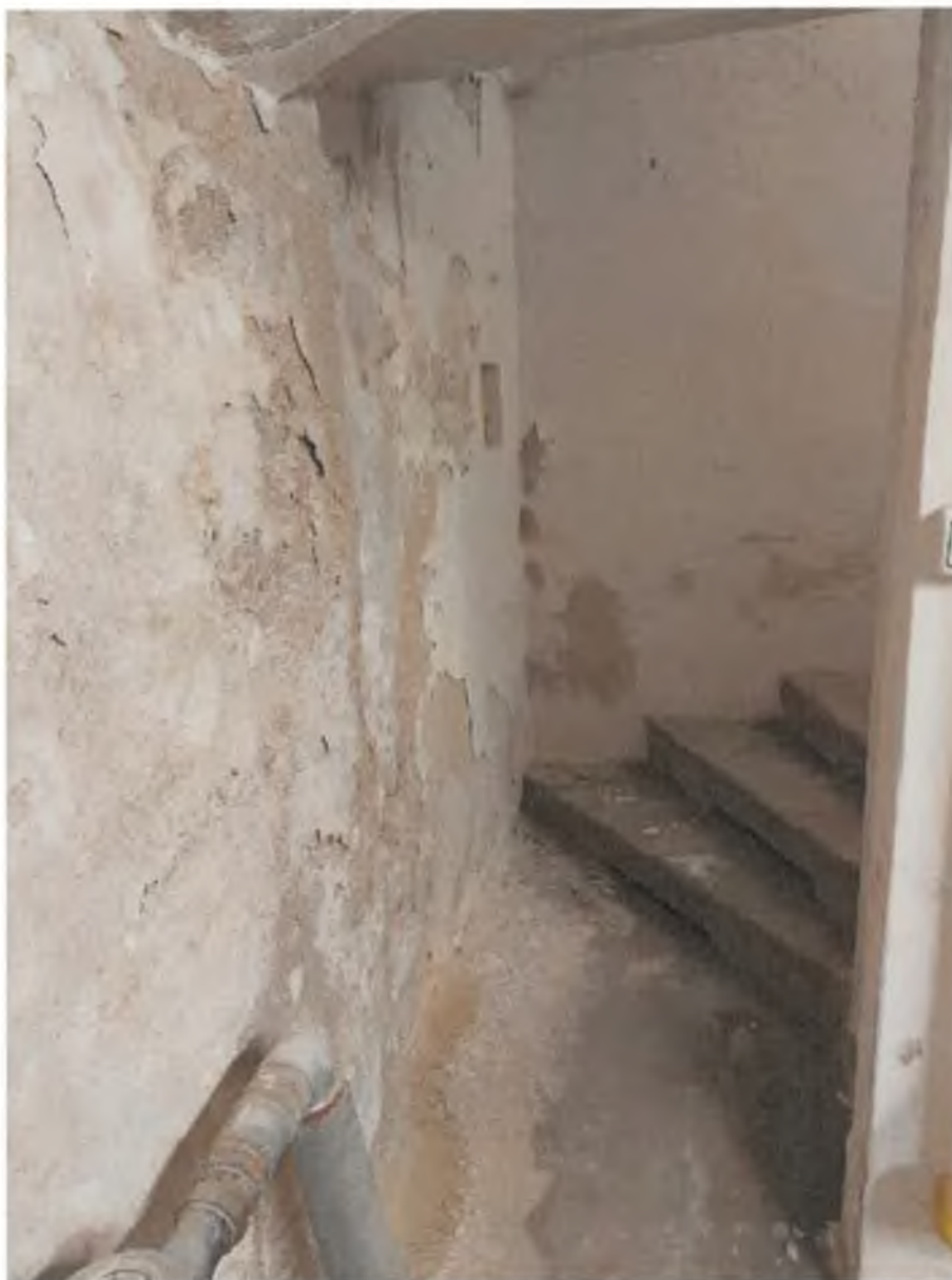
Foto 31 – Interiéry – technická místnost –vlhké podzemní zdivo
