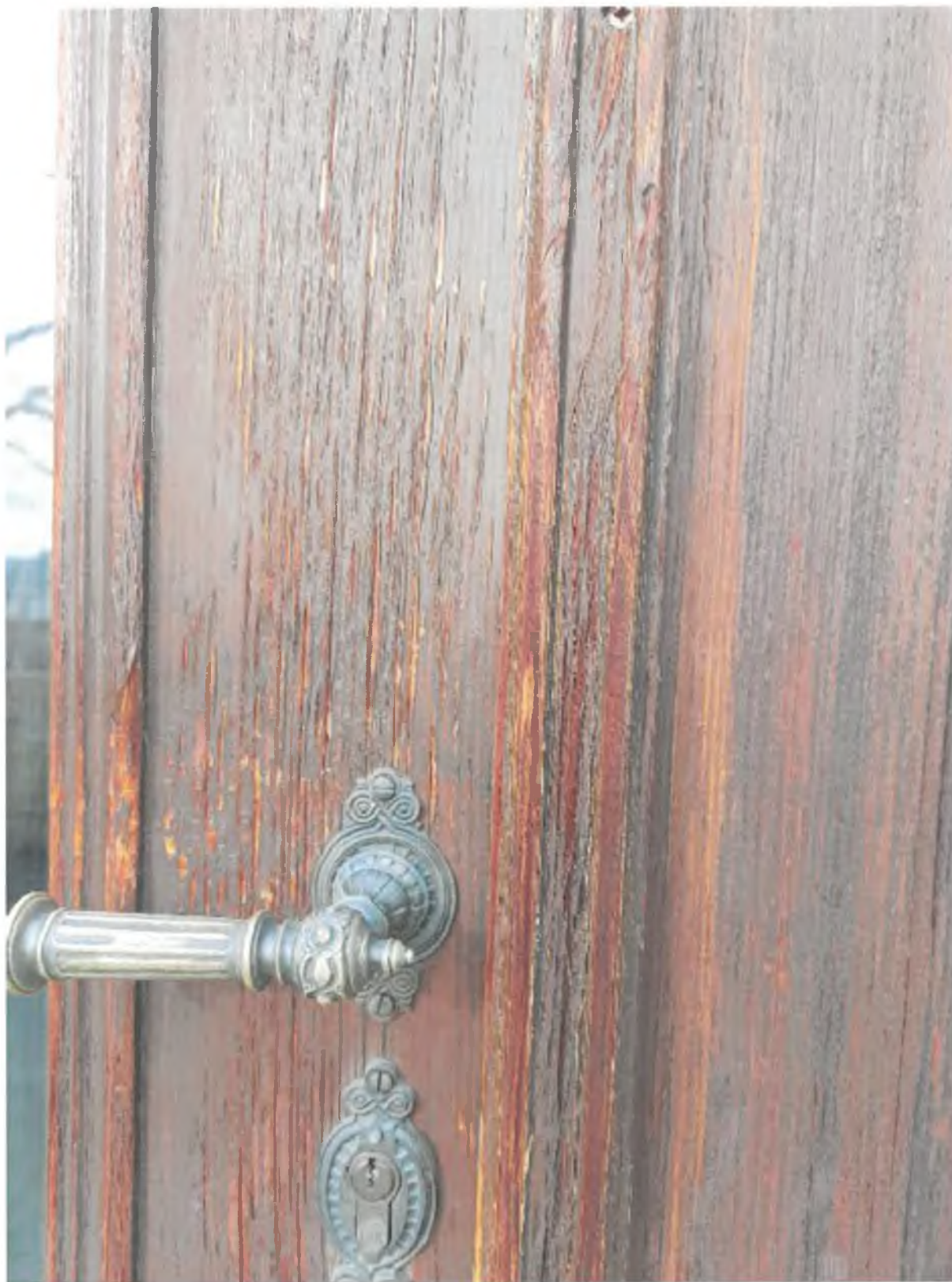
Foto 26 – Výplně otvorů – postupná degradace dveří
