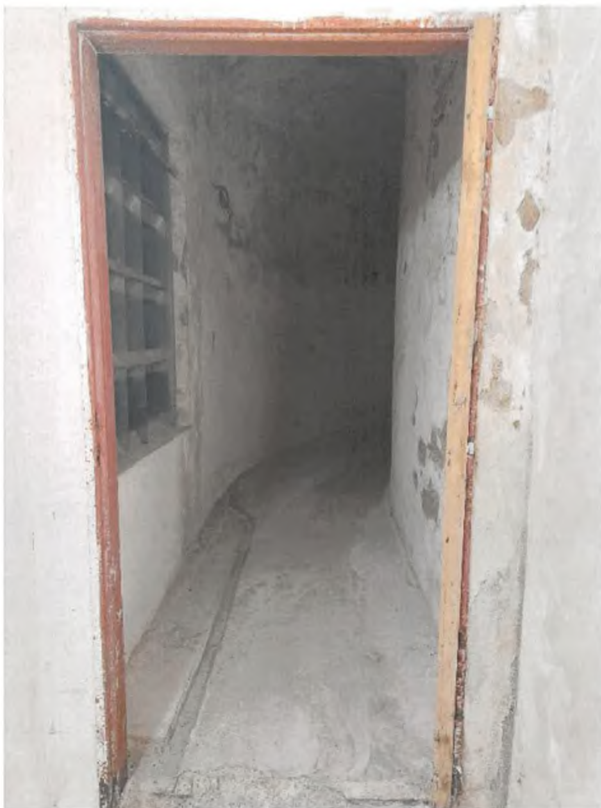
Foto 60 – Interiér – Vlhké sklepy – doporučeno řešit větrání sklepů
