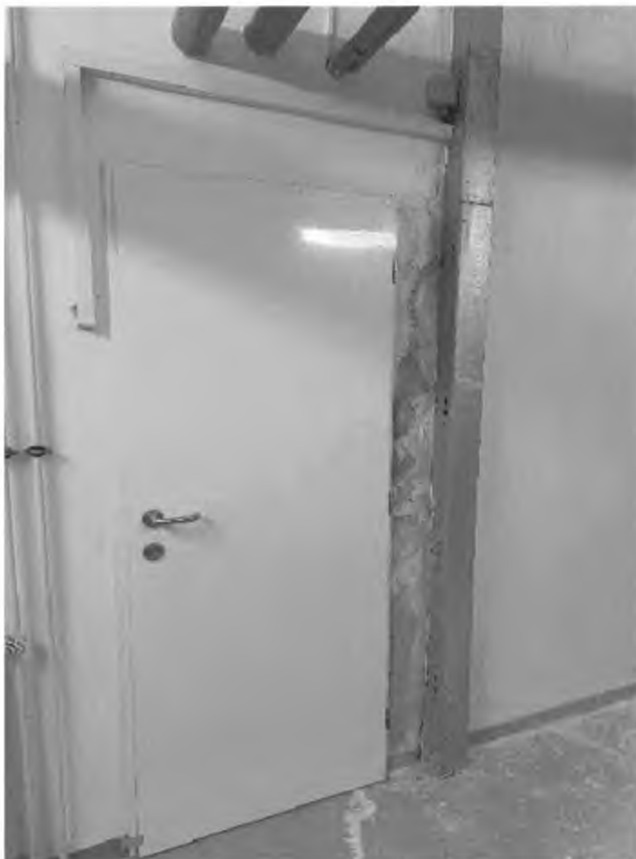
Foto 66 – Interiér – Vlhké sklepy – doporučeno řešit větrání
