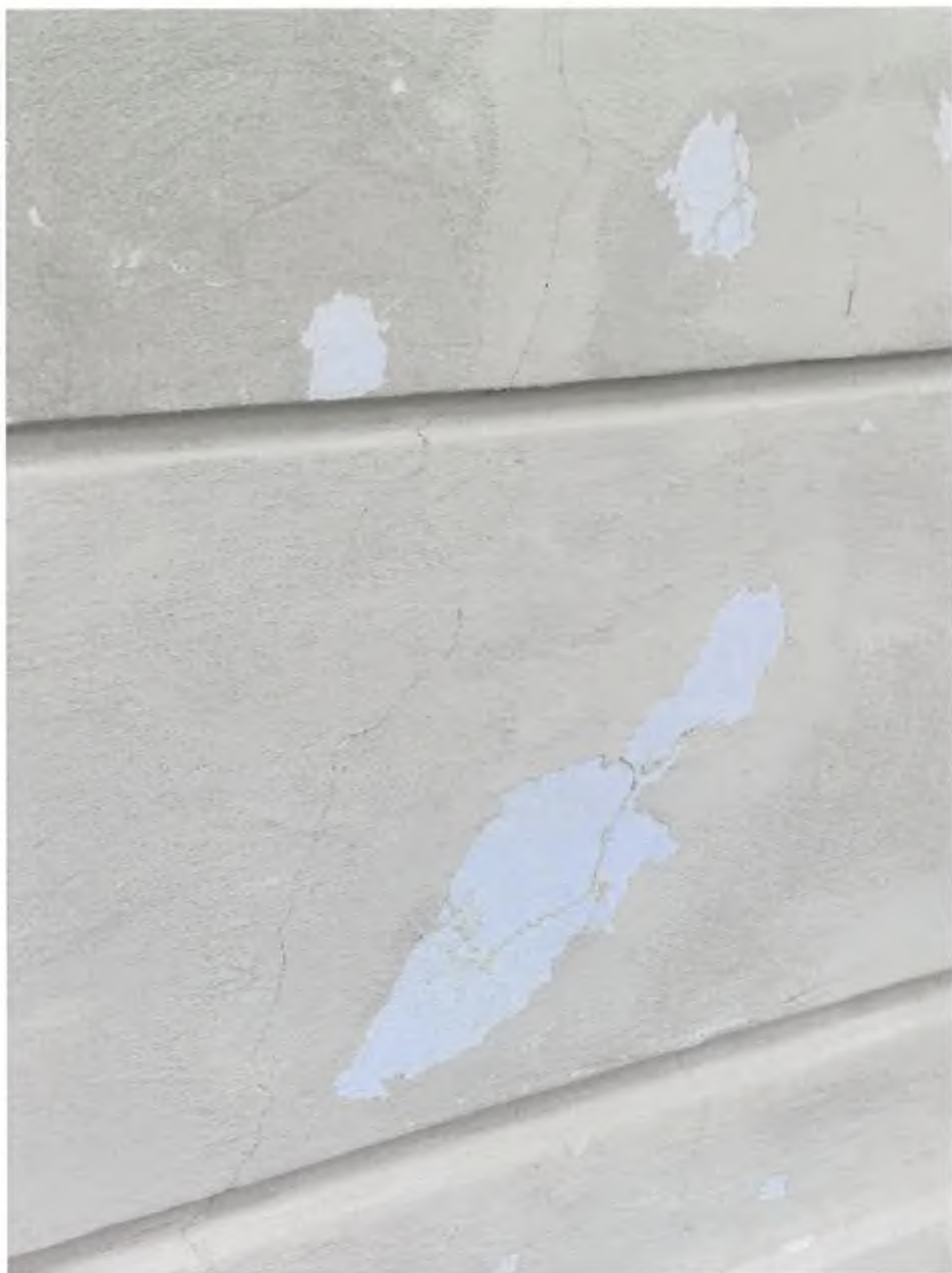
Foto 10 – Fasáda – odpadávající fasádní nátěr
