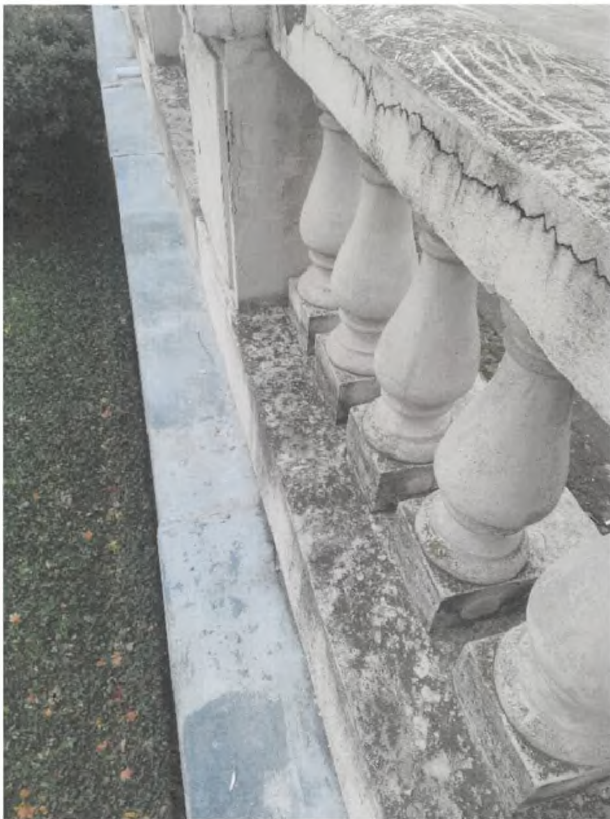
Foto 40 – Venky – Balustrády degradované omítky
