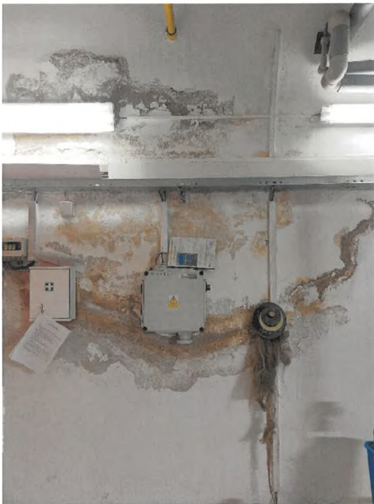
Foto 100 – Interiér – vlhké sklepy, netěsnosti a kondenzace vlhkosti na povrchu stěn a stropů
