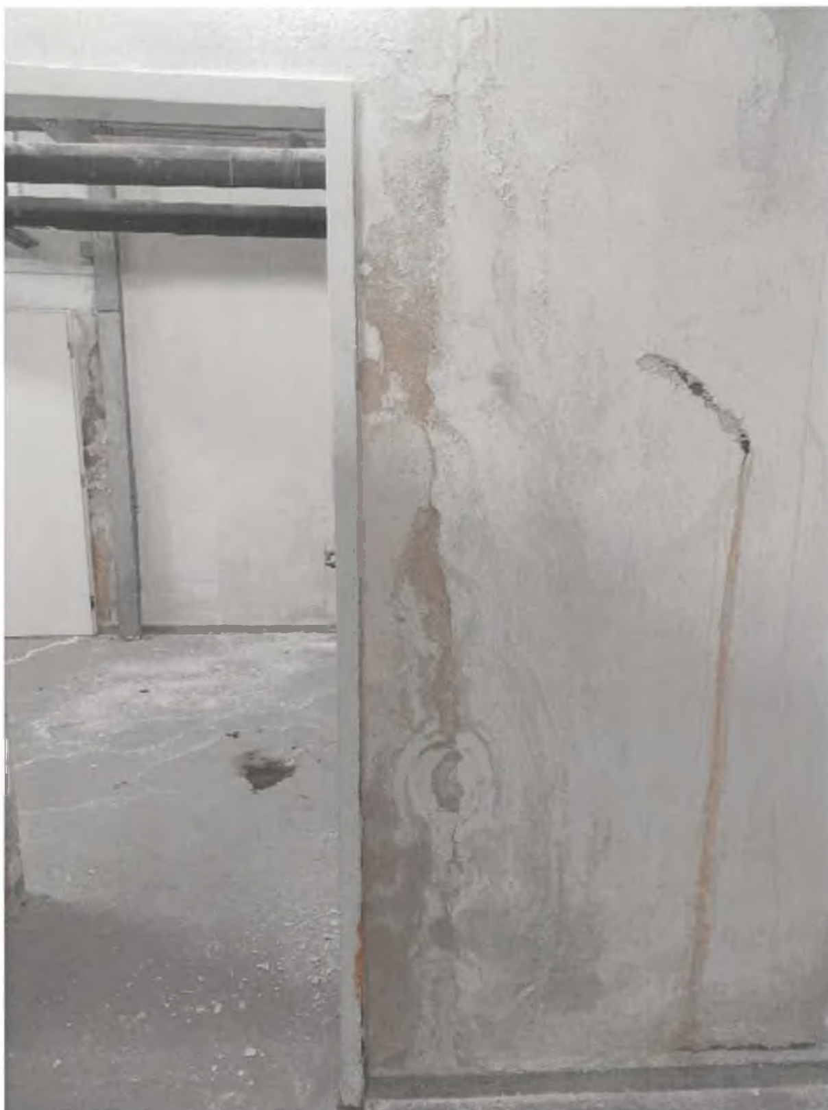
Foto 55 – Interiér – Vlhké sklepy – doporučeno řešit větrání sklepů
