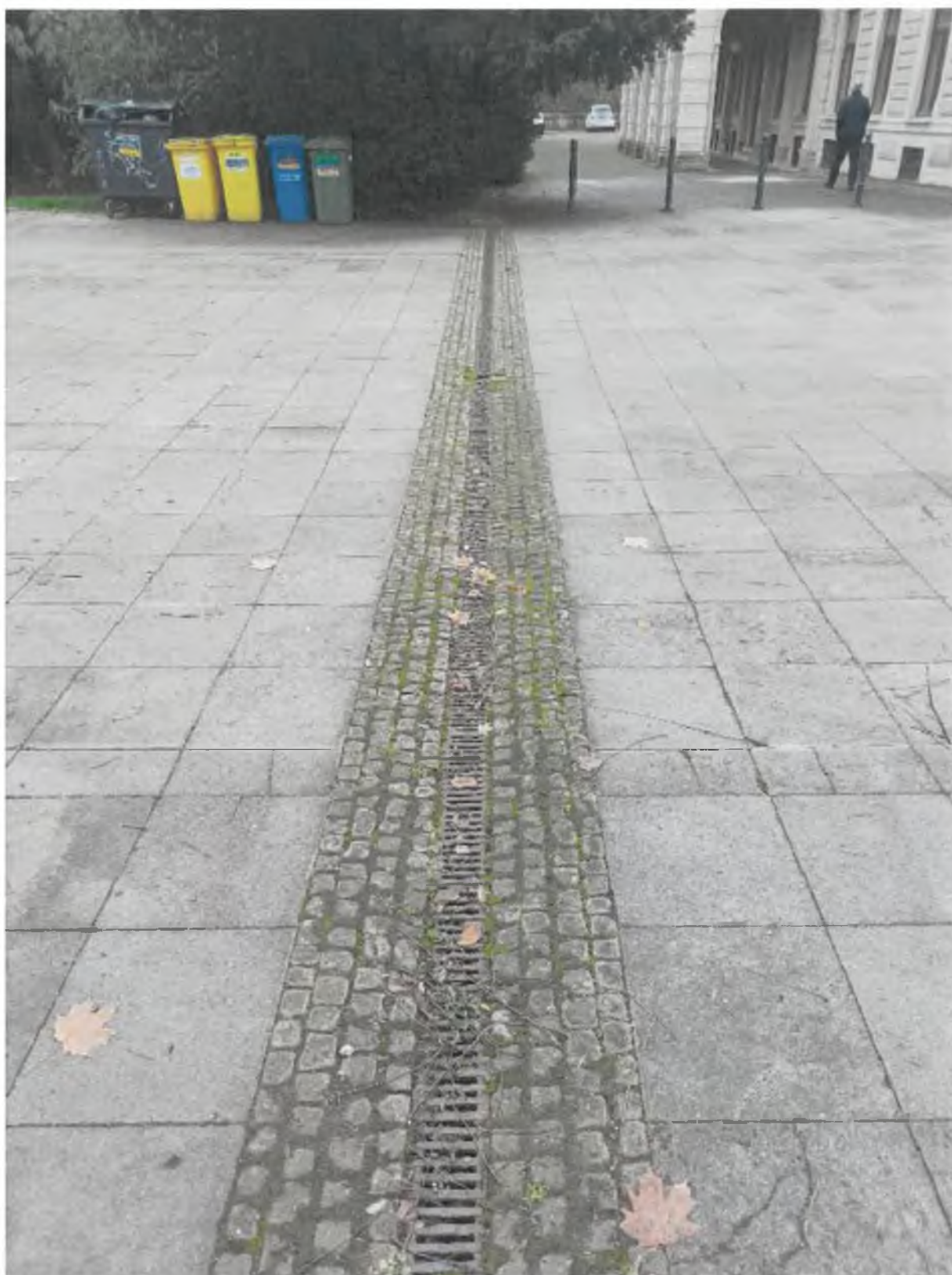
Foto 39 – Venky – Nutno pravidelně čistit kanalizace, kanály jsou zanesené
