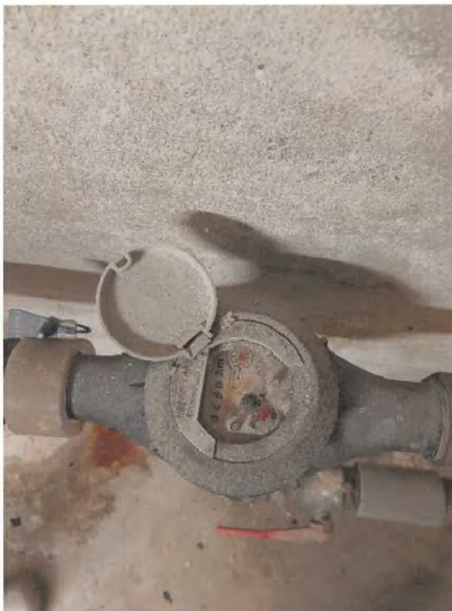
Foto 30 – Interiéry – technická místnost –vodoměr
