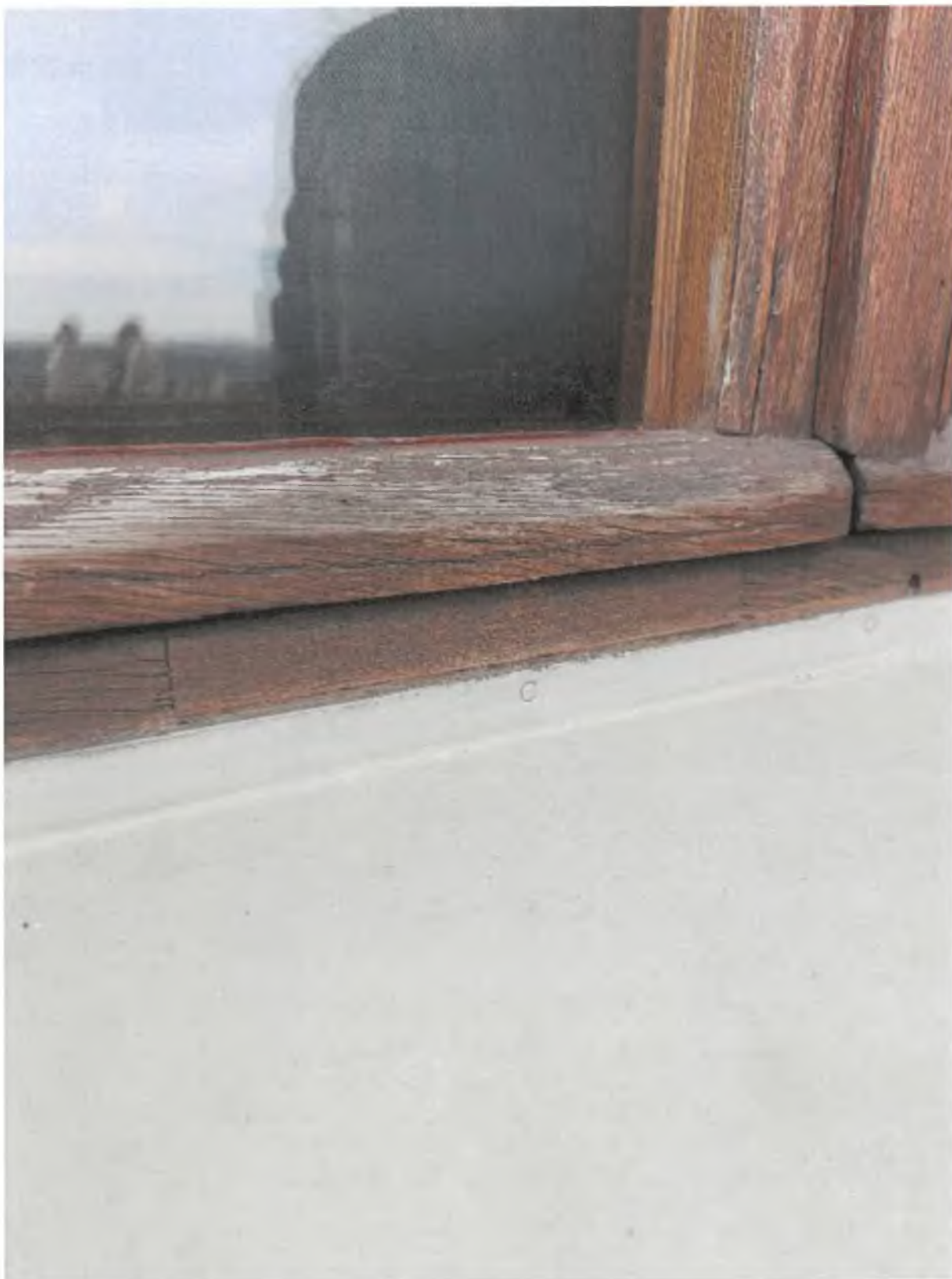
Foto 28 – Výplně otvorů – nevhodné: zasklívací lišta z exteriéru + spodní rám tvoří zároveň funkci okapničky + napojení parapetu k rámu
