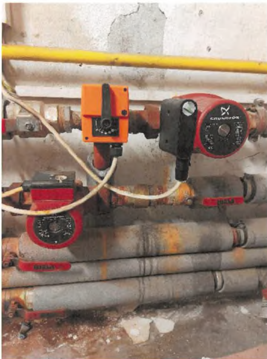
Foto 23 – Interiéry – technická místnost – čerpadlo otopné soustavy
