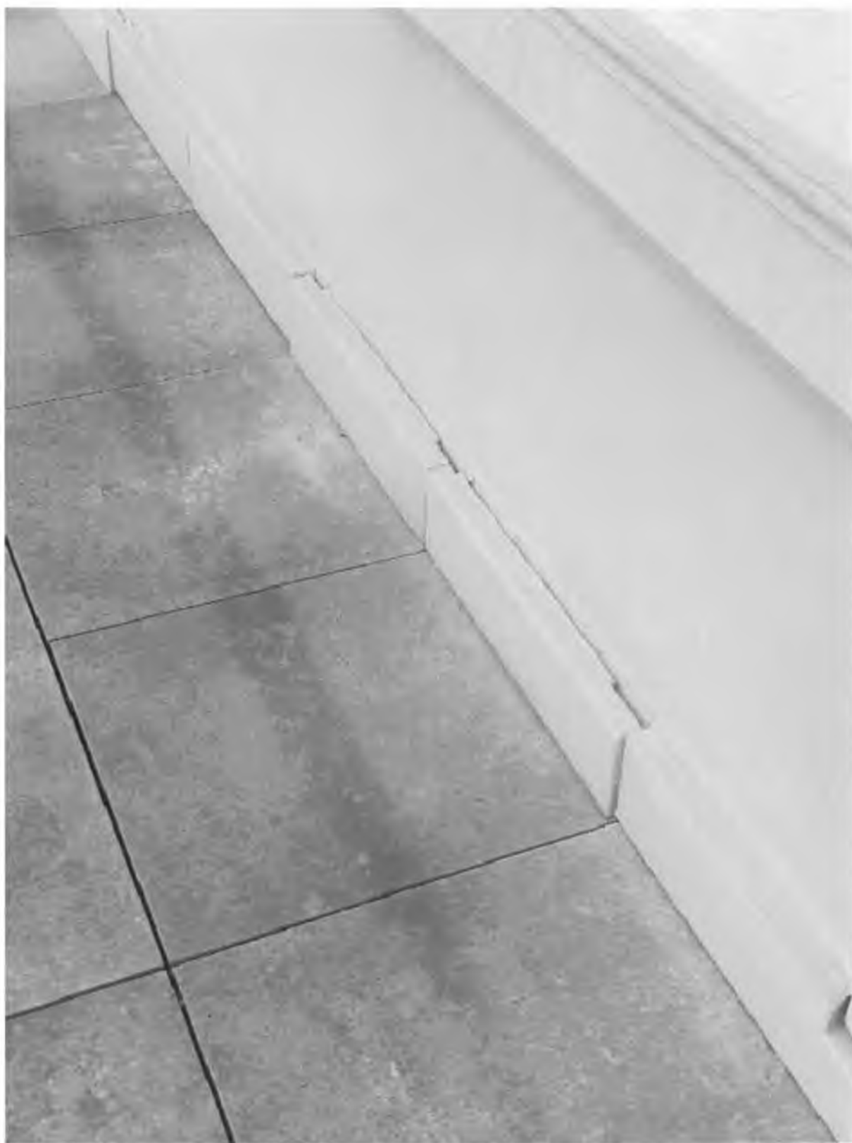
Foto 9 – Fasáda – odpadaná soklová dlažba
