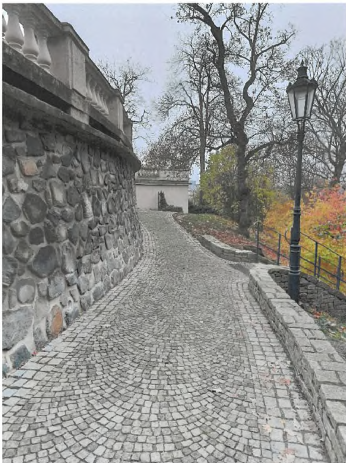
Foto 43 – Venky – Opěrná stěna – viditelné prosakování vod - absence nebo nefunkčnost řízeného odvodnění opěrné stěny potrubím skrze stěnu
