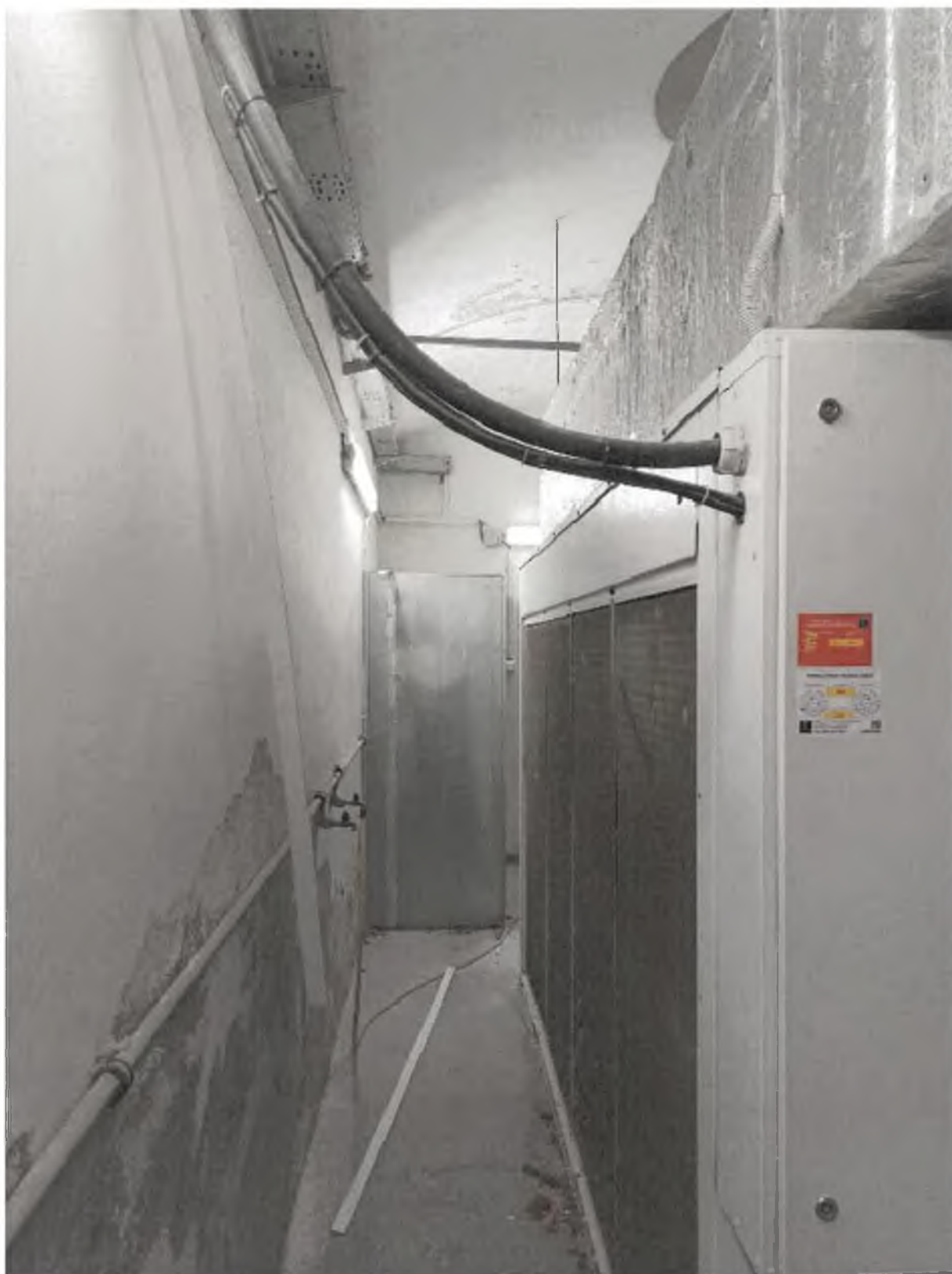
Foto 71 – Interiér – Vlhké sklepy – doporučeno řešit větrání + Chladicí jednotka (chiller) TRANE 3-D Scroll, určená k výrobě chladu pro vodní okruh (např. fan coils, VZT chladiče, klimatizaci serverovny nebo objektu)
