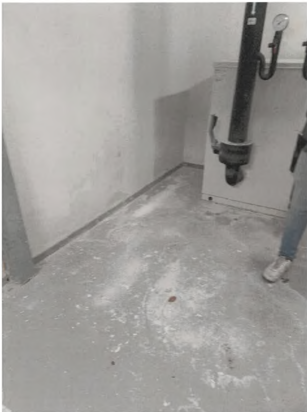
Foto 68 – Interiér – Vlhké sklepy – doporučeno řešit větrání
