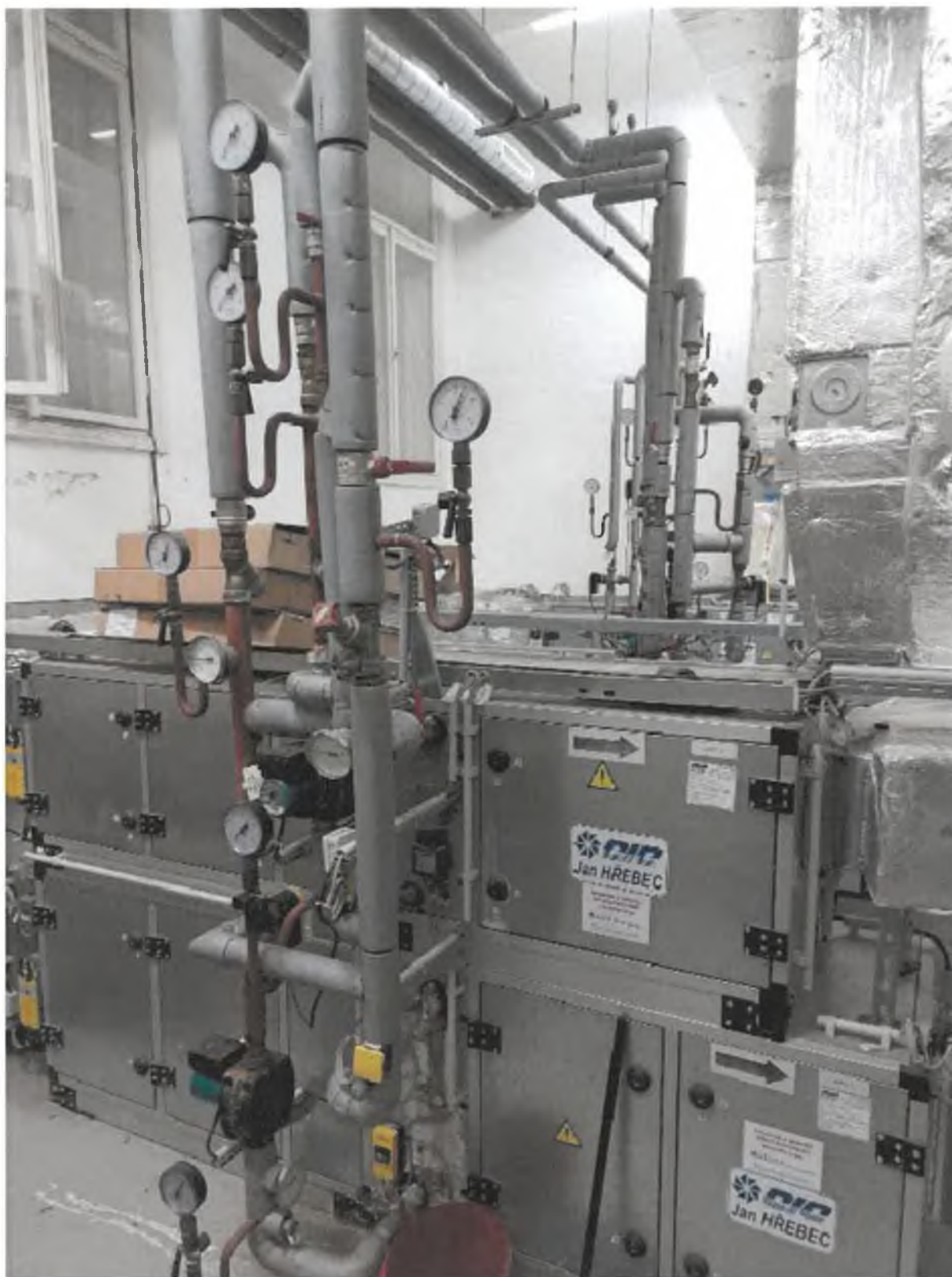
Foto 92 – Interiér – centrální vzduchotechnická jednotka s vodním výměníkem, napojená na potrubní a měřicí systém, používaná pro větrání a klimatizaci objektu.
