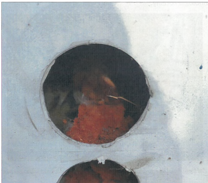
Obrázek 8: Vnější plechový plášť s izolací (není patrná přítomnost podbití azbestovou deskou)
