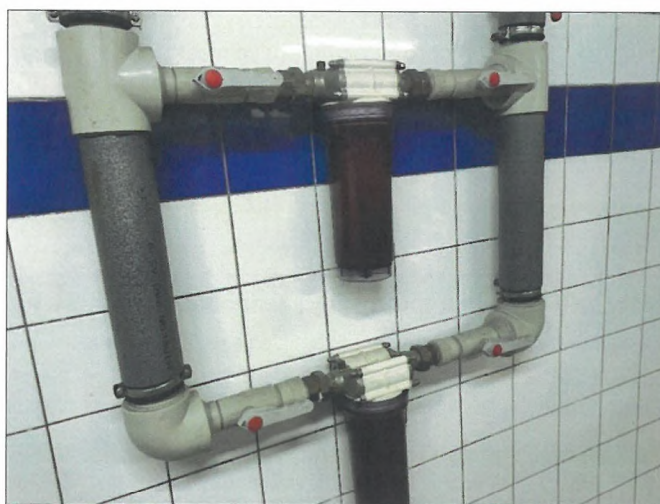
Obrázek 11: Rozvody vody v kotelně tvořené PPR potrubím s mirelonovou tepelnou izolací
