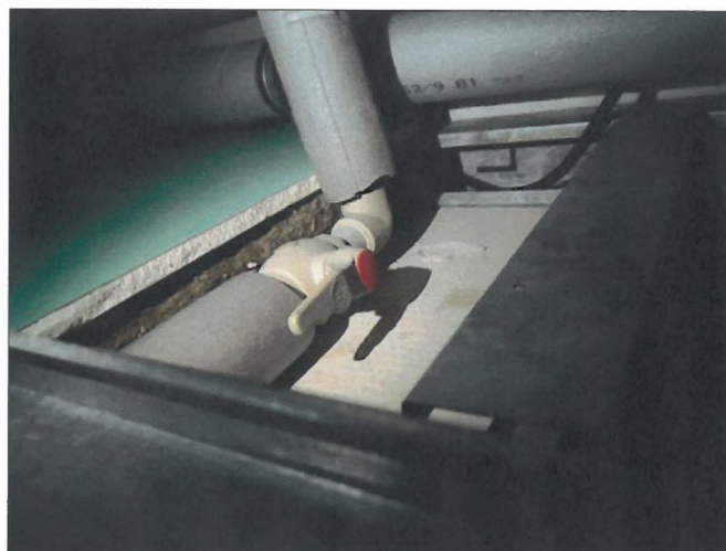
Obrázek 7: pravděpodobně osinkocementová deska v ostění stoupaček vodovodního potrubí (deska se stínem kulového kohoutu)
