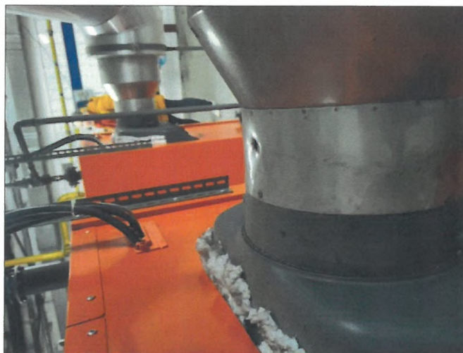
Obrázek 6: Zařízení kotelny - pravděpodobný výskyt černého azbestového provazce v těsnění
