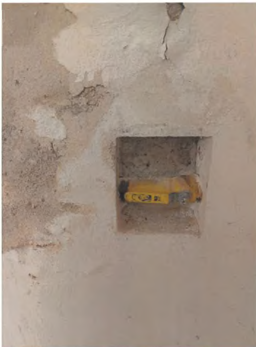
Foto 20 – Interiéry – technická místnost – hlavní uzavěr plynu
