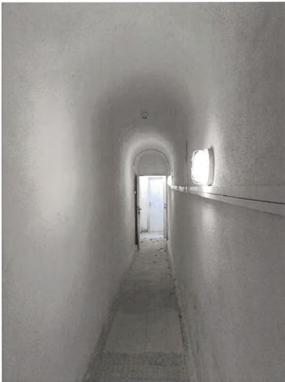
Foto 57 – Interiér – Vlhké sklepy – doporučeno řešit větrání sklepů
