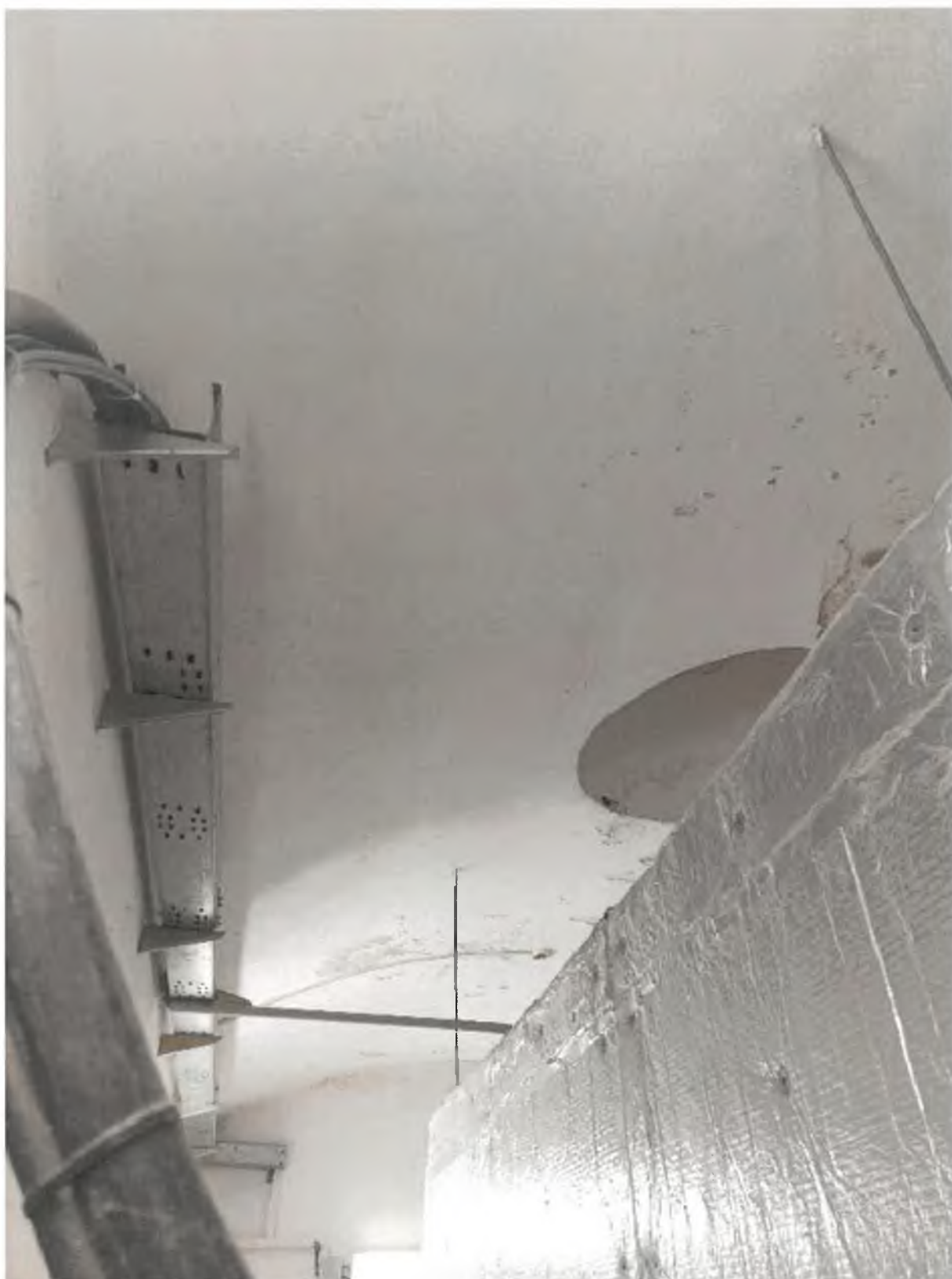
Foto 72 – Interiér – Vlhké sklepy – doporučeno řešit větrání + Chladicí jednotka (chiller) TRANE 3-D Scroll, určená k výrobě chladu pro vodní okruh (např. fan coils, VZT chladiče, klimatizaci serverovny nebo objektu)
