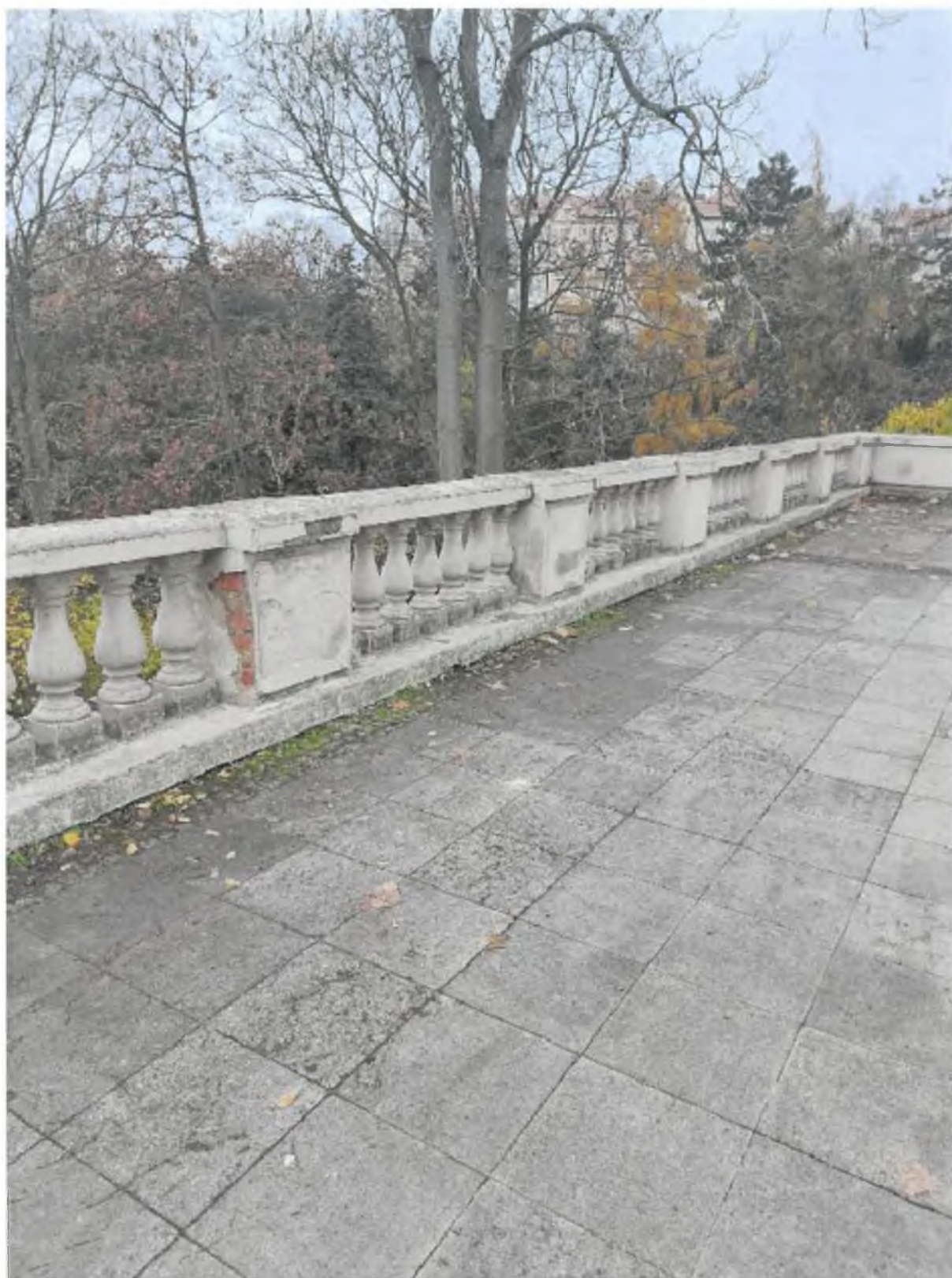
Foto 38 – Venky – Balustrády degradované omítky
