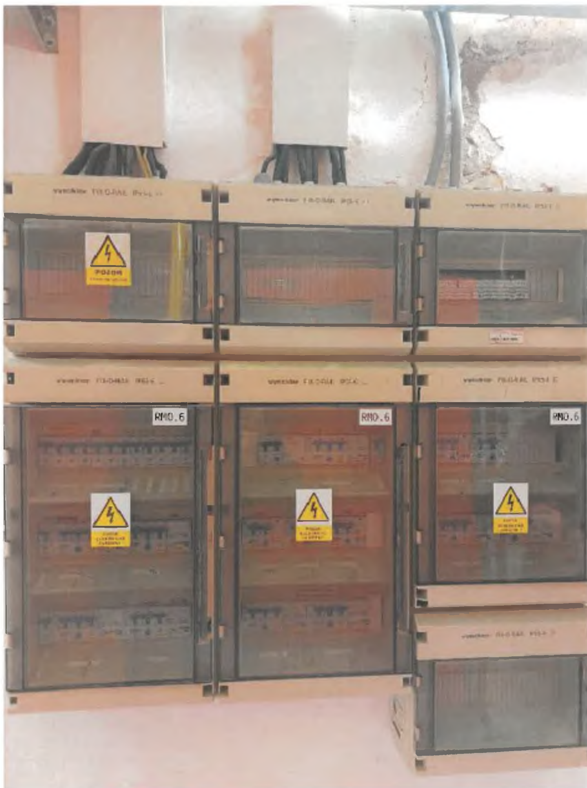
Foto 78 – Interiér – hnízdo rozvaděčů
