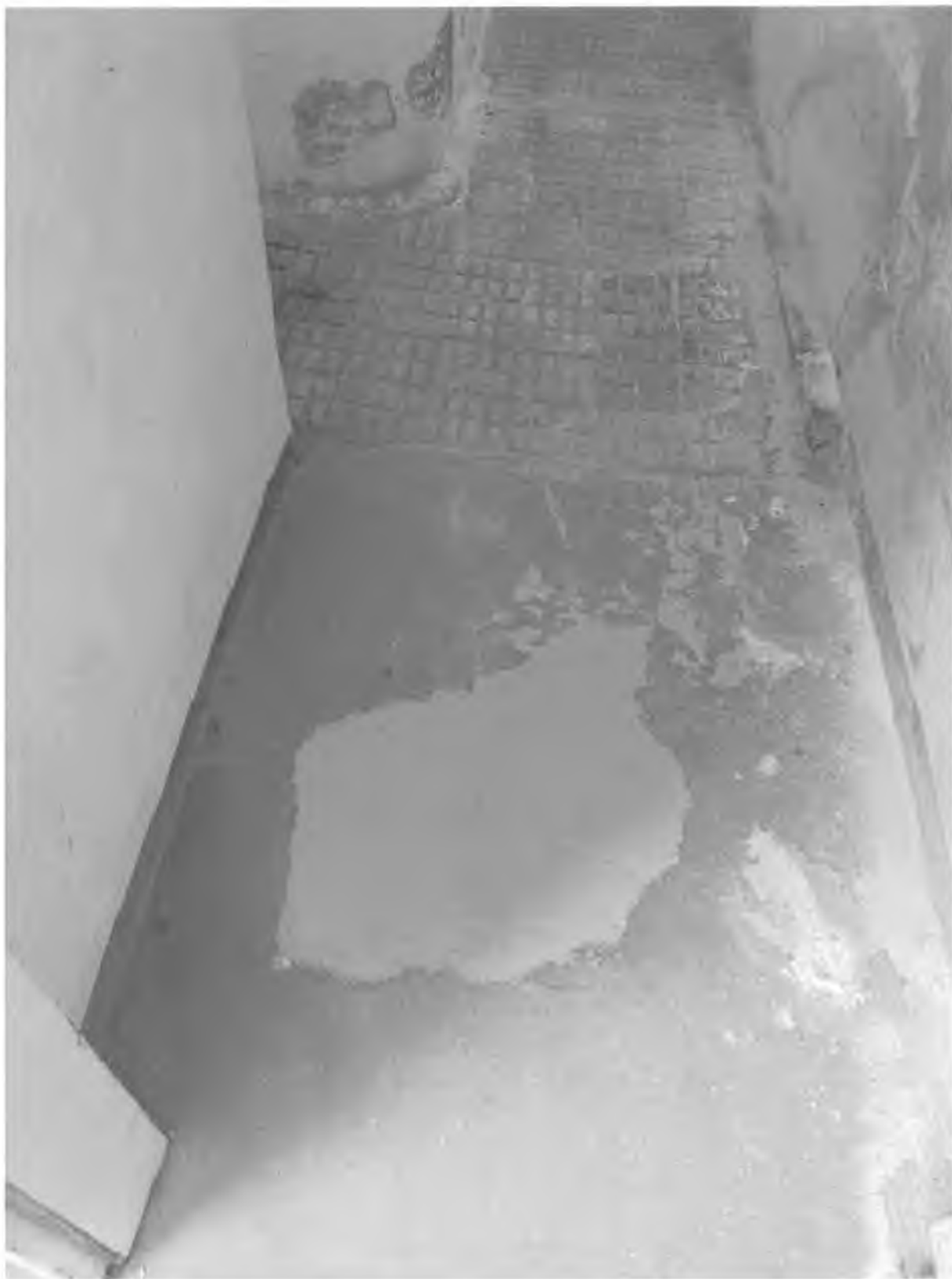
Foto 58 – Interiér – Vlhké sklepy – doporučeno řešit větrání sklepů
