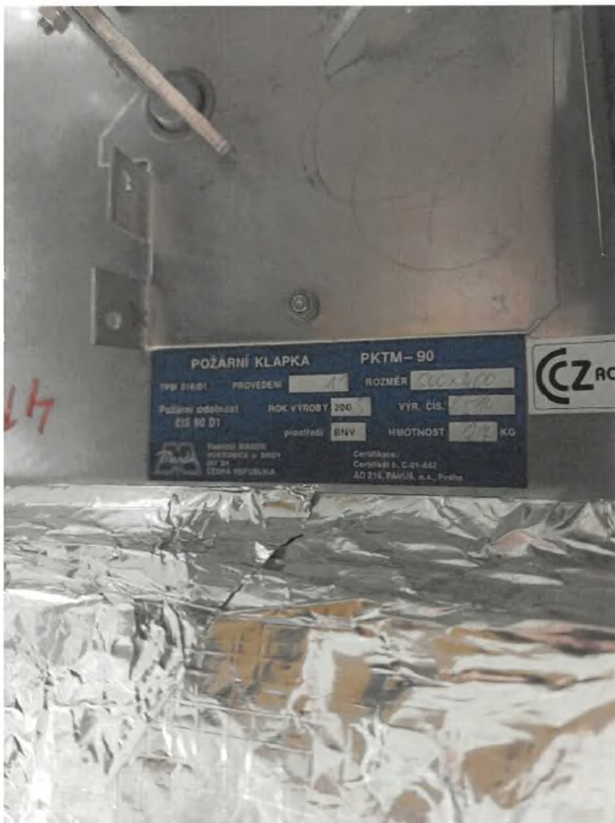
Foto 95 – Interiér – VZT požární klapka
