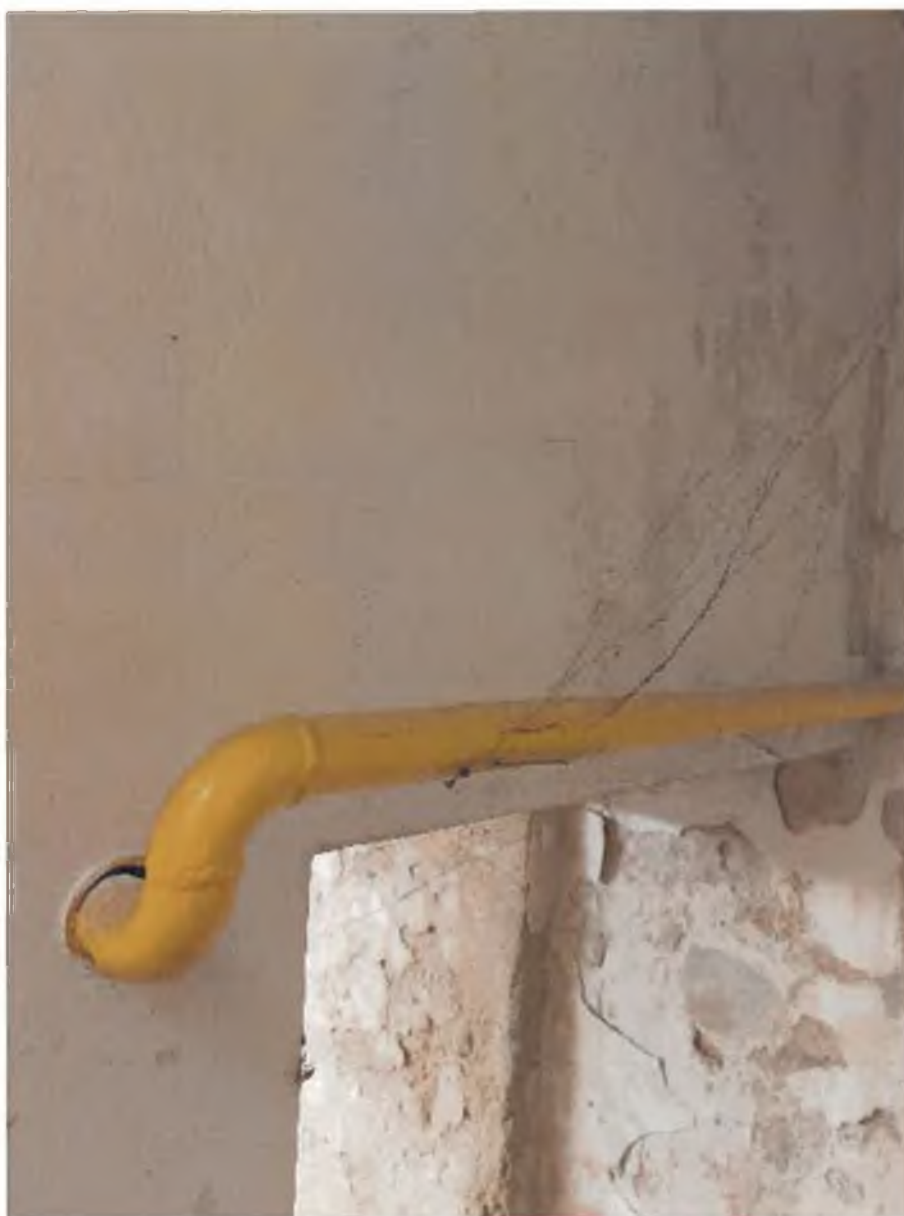
Foto 18 – Interiéry – technická místnost – potrubí plynovodu - viditelná vlhkost zdiva
