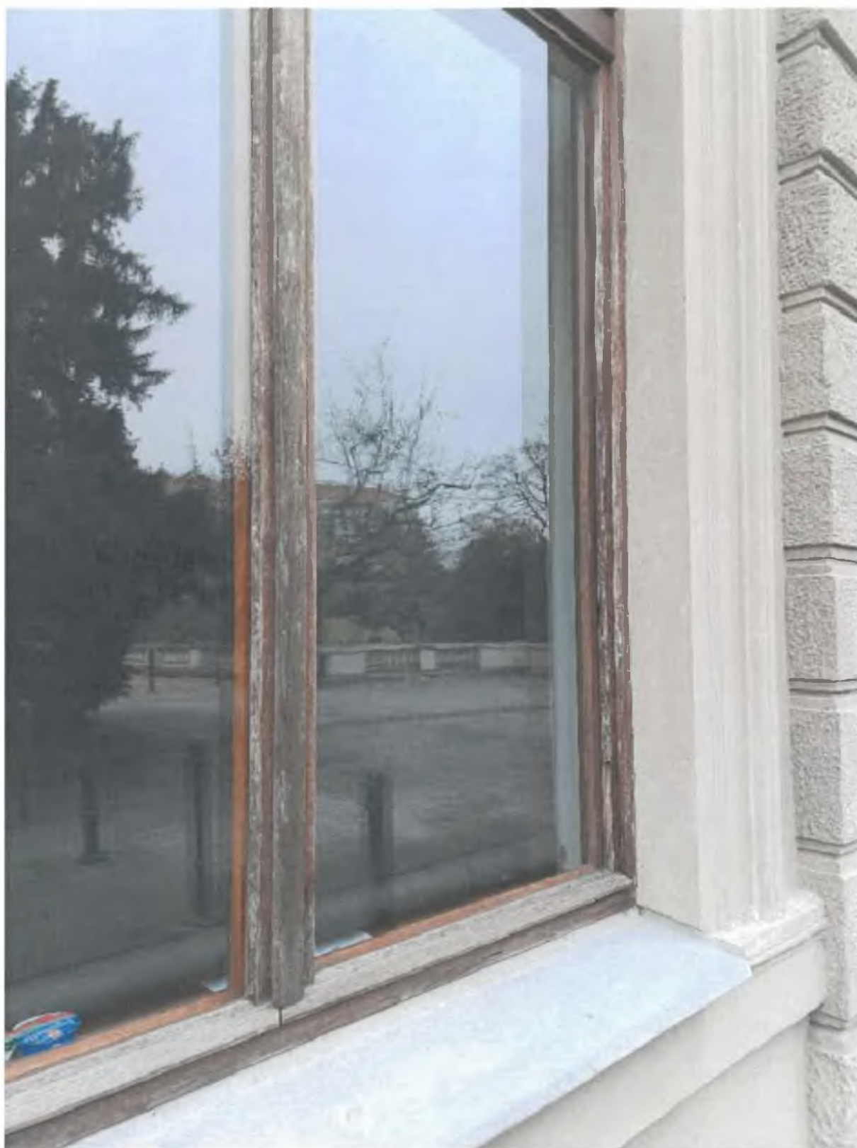
Foto 31 – Výplně otvorů – parapet lakovaný pozink + viditelná degradace okna
