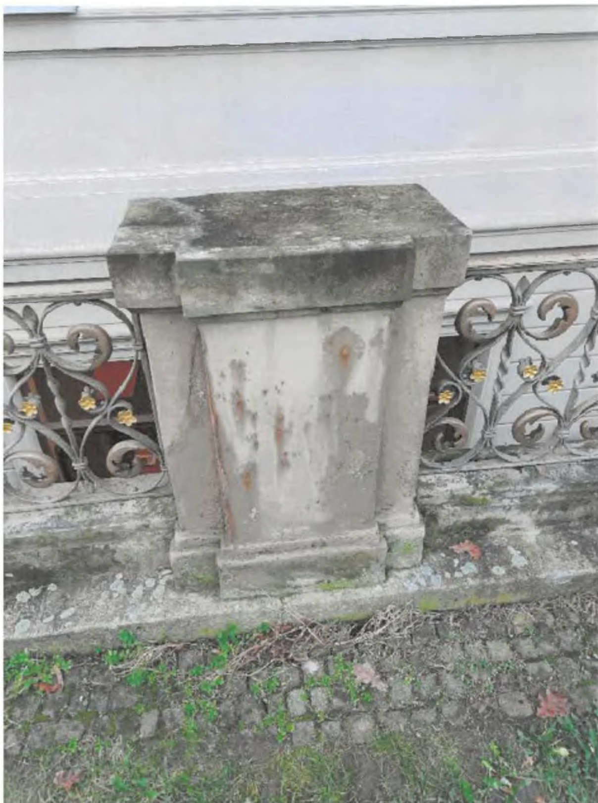
Foto 42 – Venky – Balustrády degradované omítky + zábradlí v dobrém stavu
