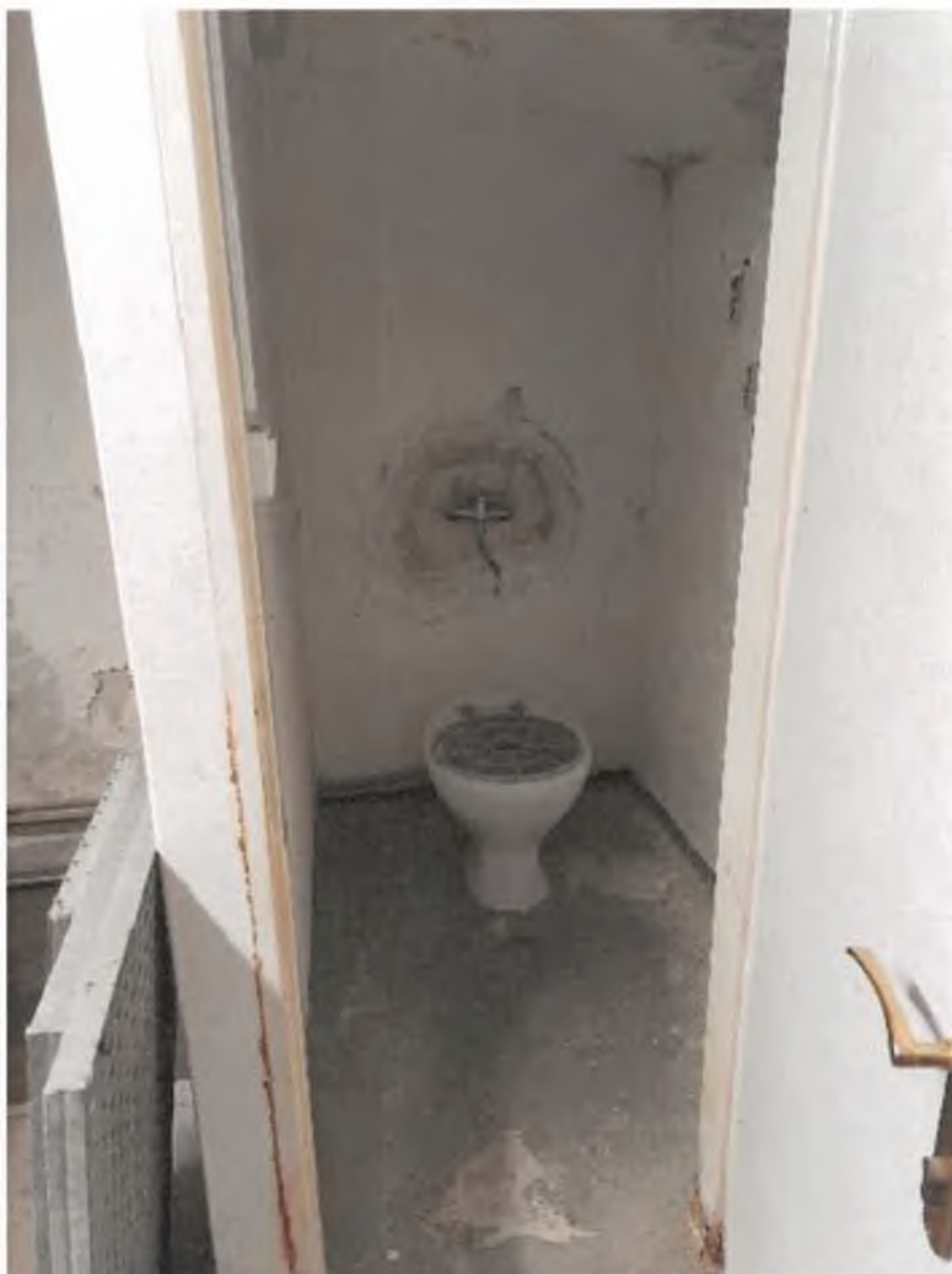
Foto 33 – Interiéry – technická místnost –výlevka
