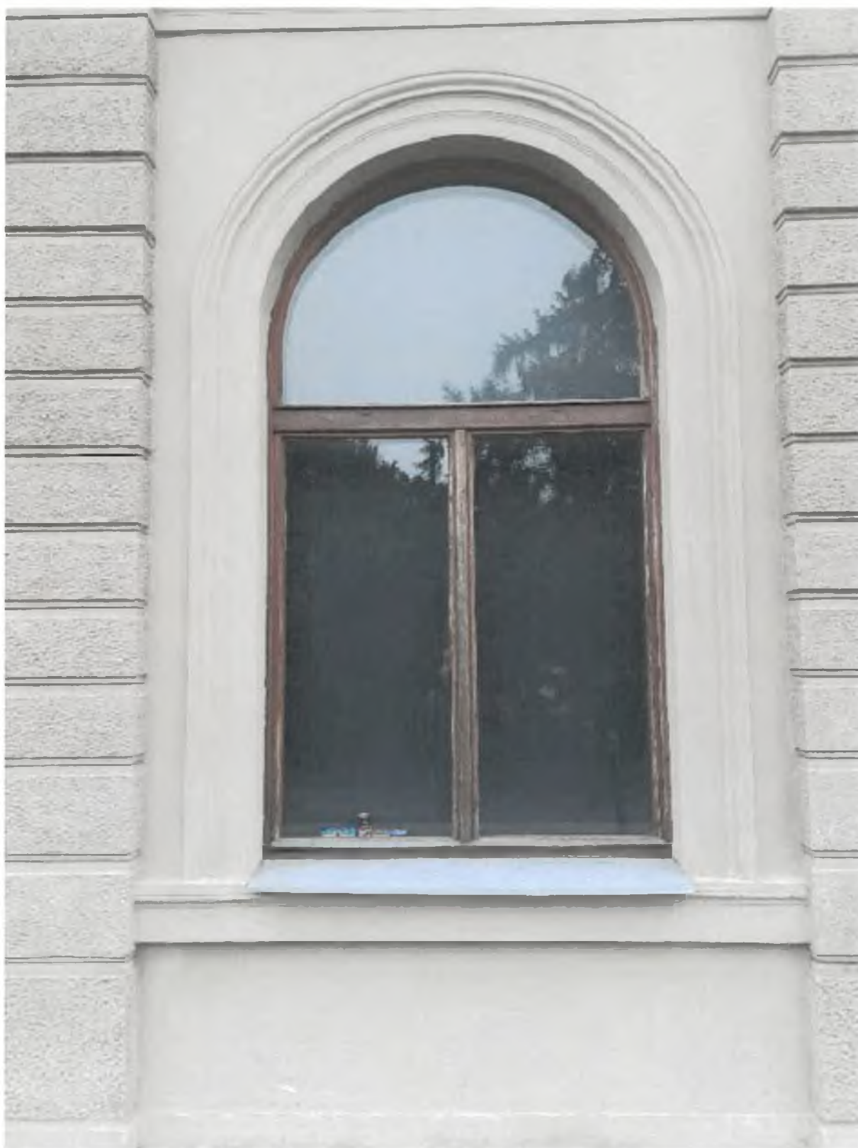
Foto 29 – Výplně otvorů – okno severní fasády 1.NP
