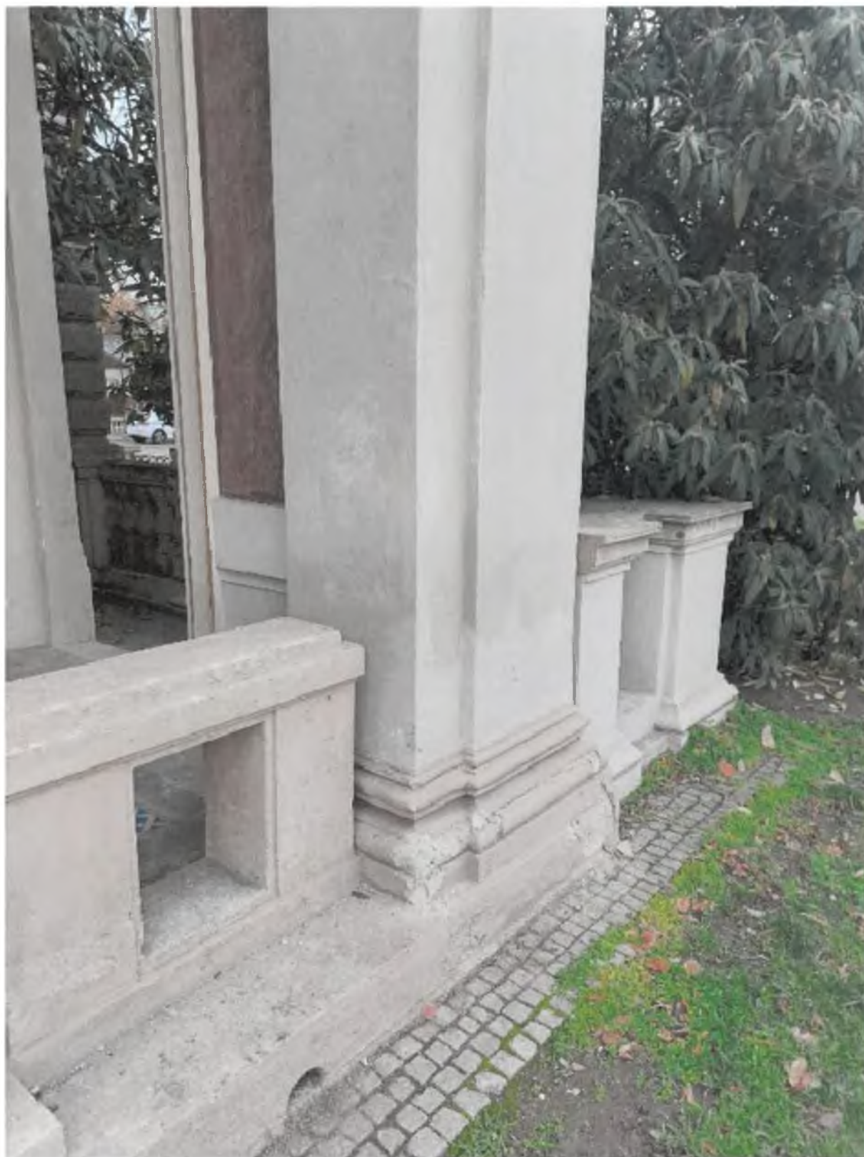
Foto 15 – Fasáda – jižní fasáda - degradace omítky
