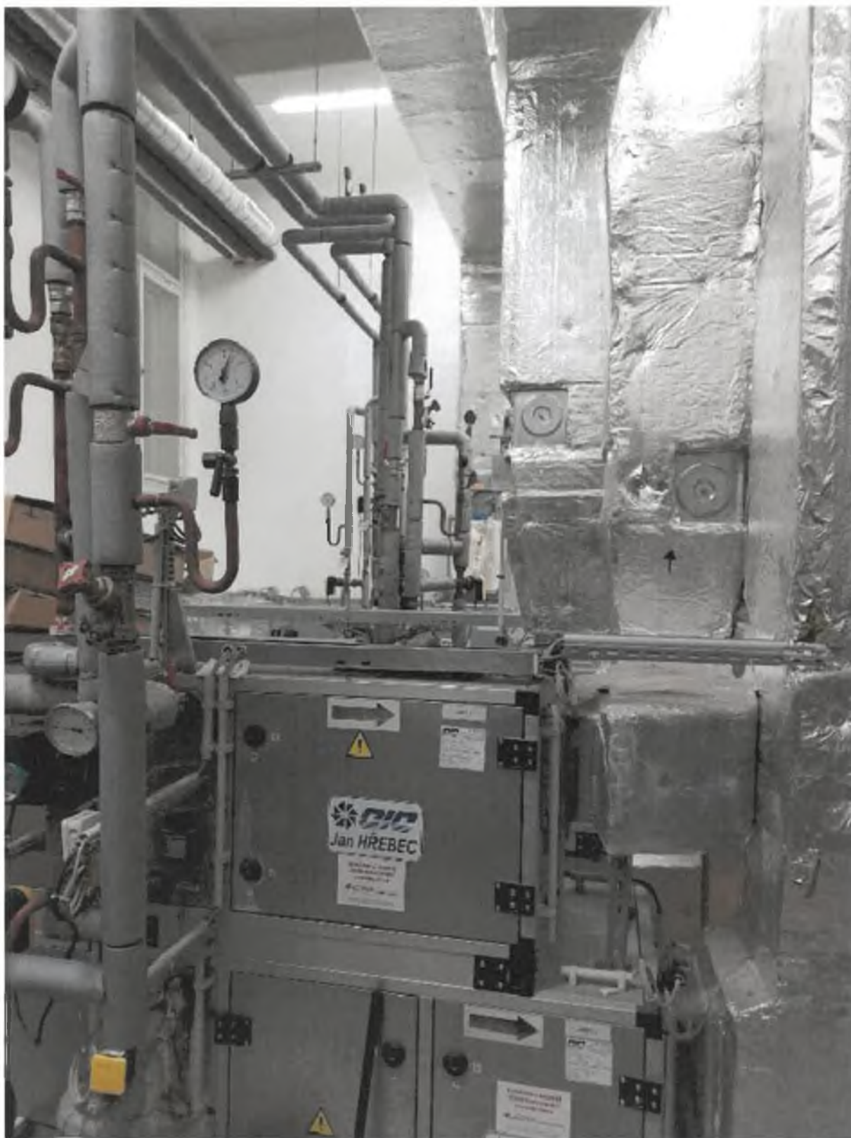
Foto 91 – Interiér – centrální vzduchotechnická jednotka s vodním výměníkem, napojená na potrubní a měřicí systém, používaná pro větrání a klimatizaci objektu.
