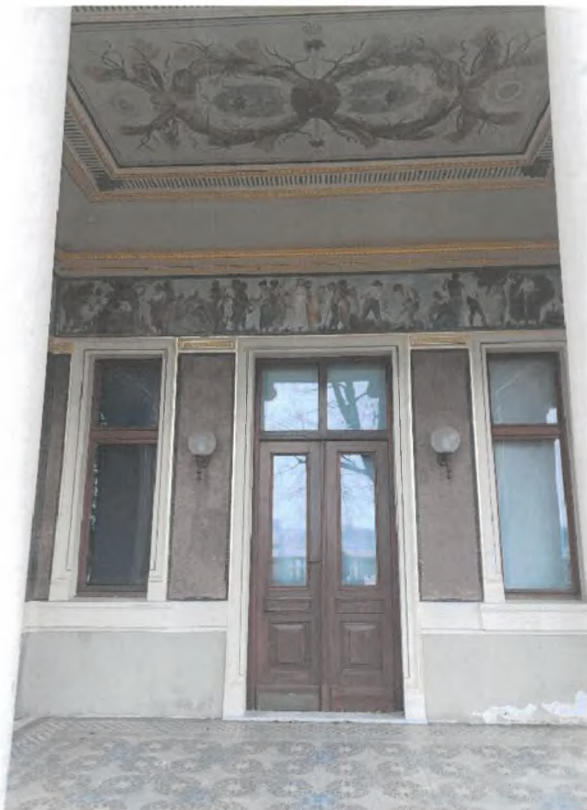
Foto 19 – Fasáda – jižní fasáda – odpadaný fasádní nátěr
