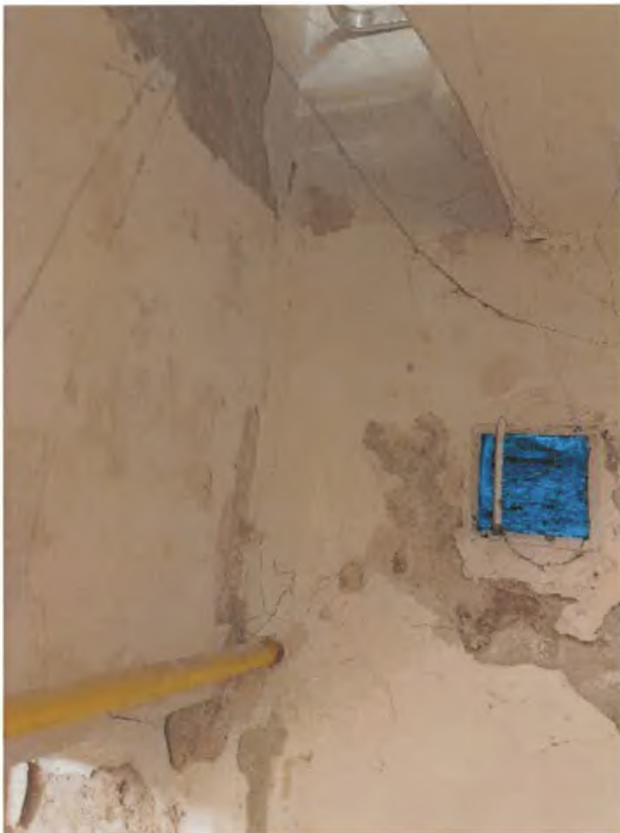
Foto 19 – Interiéry – technická místnost – potrubí plynovodu – viditelná vlhkost zdiva
