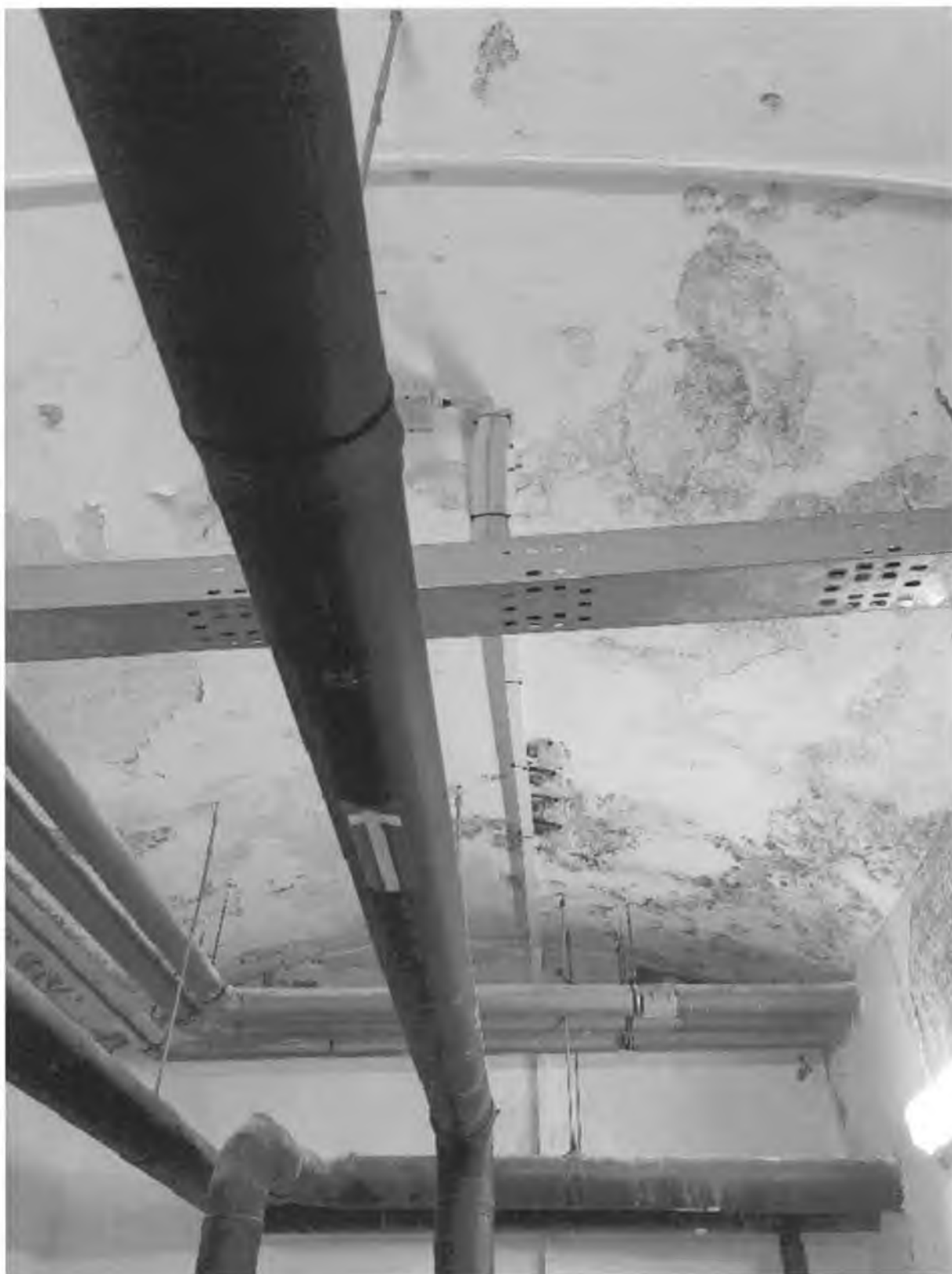
Foto 67 – Interiér – Vlhké sklepy – doporučeno řešit větrání
