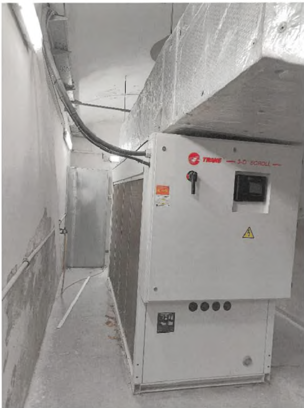
Foto 69 – Interiér – Vlhké sklepy – doporučeno řešit větrání + Chladicí jednotka (chiller) TRANE 3-D Scroll, určená k výrobě chladu pro vodní okruh (např. fan coils, VZT chladiče, klimatizaci serverovny nebo objektu)
