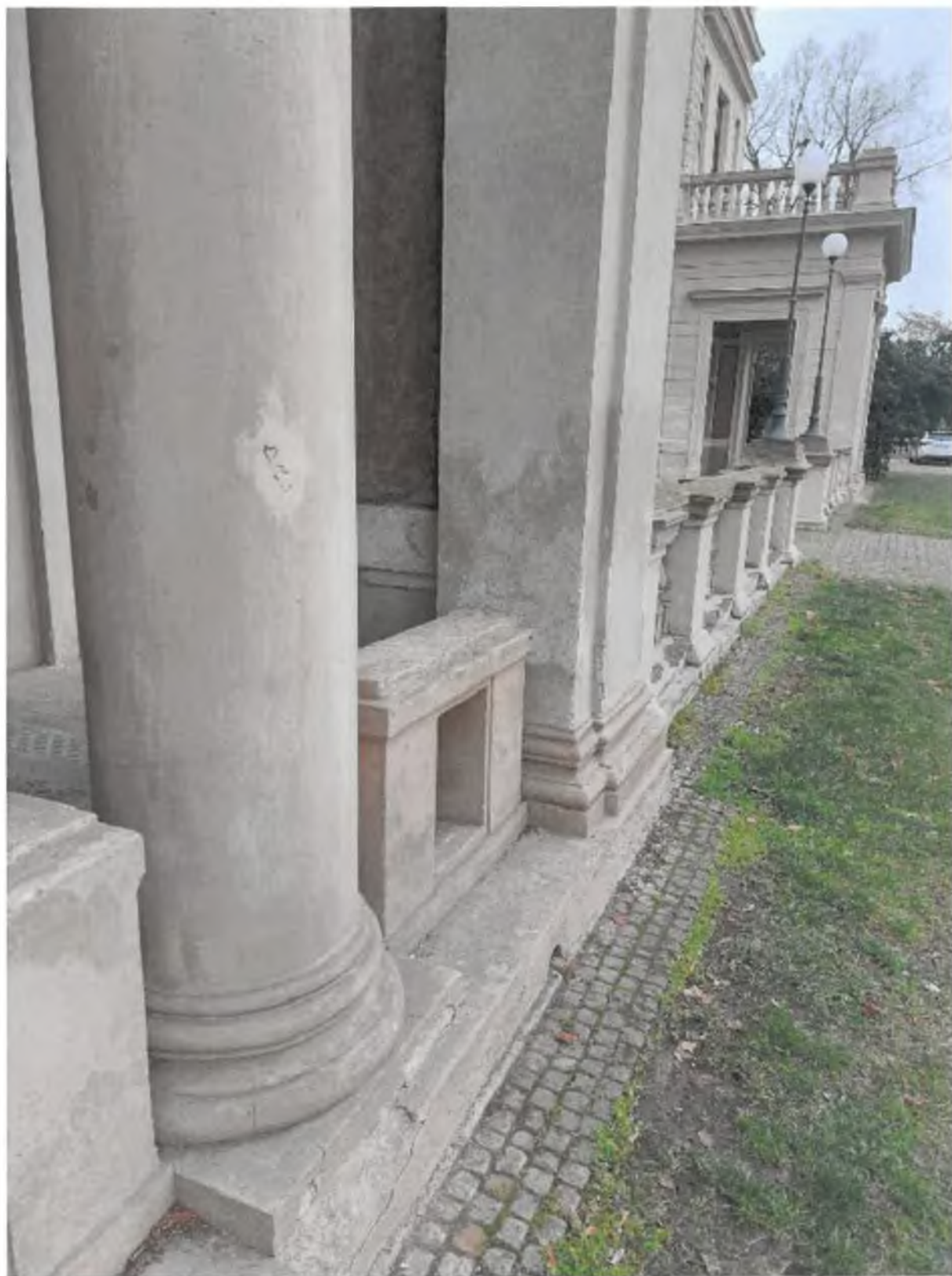
Foto 20 – Fasáda – jižní fasáda - degradace omítky
