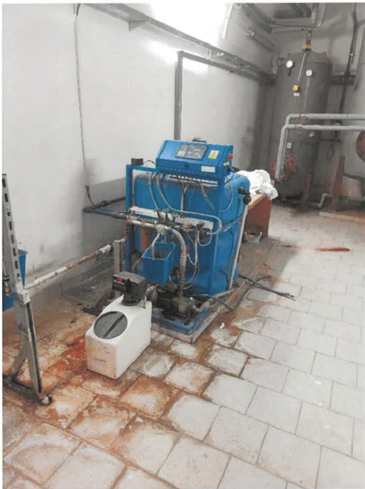
Foto 79 – Interiér – úpravna vody
