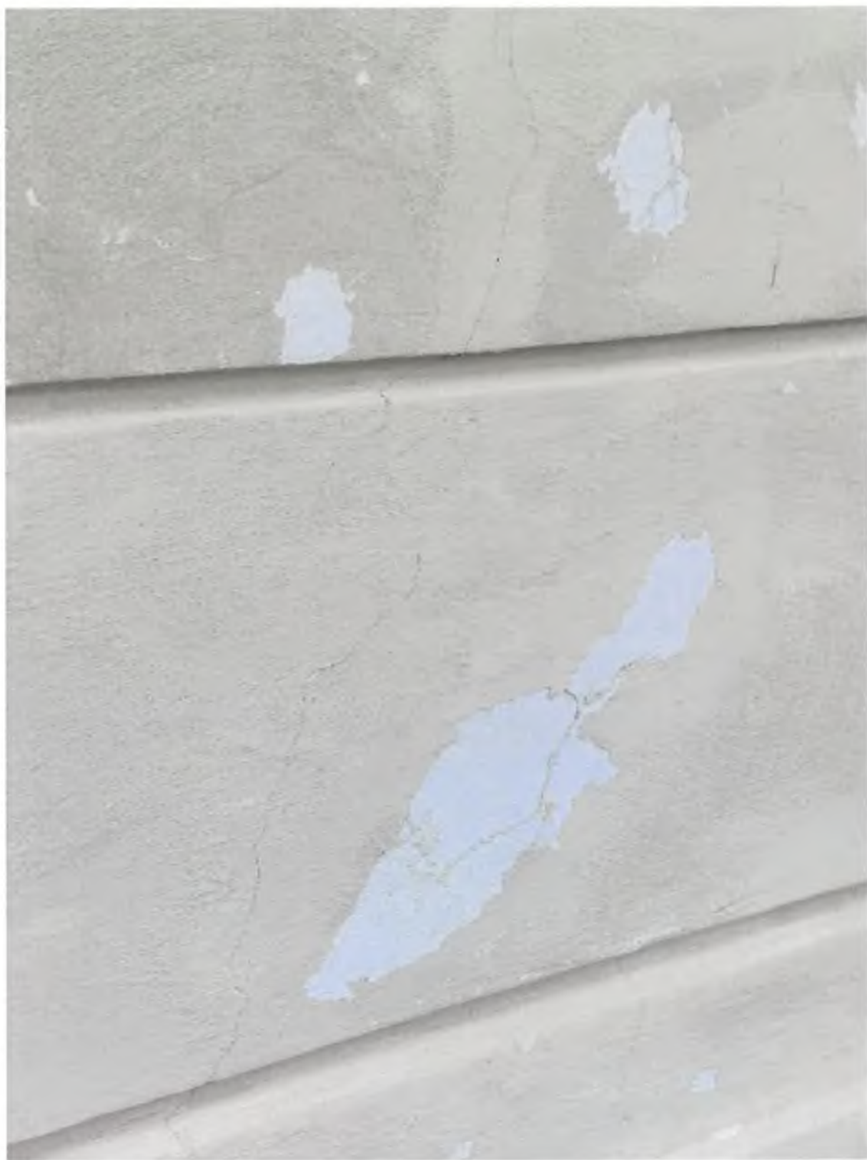
Foto 10 – Fasáda – odpadávající fasádní nátěr
