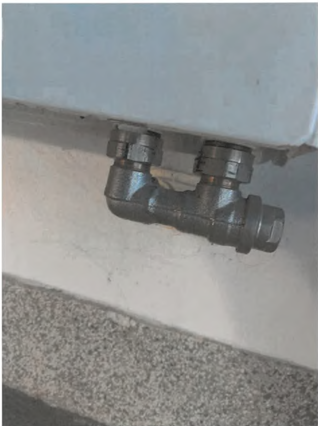
Foto 46 – Interiér – Armatury topného systému těles
