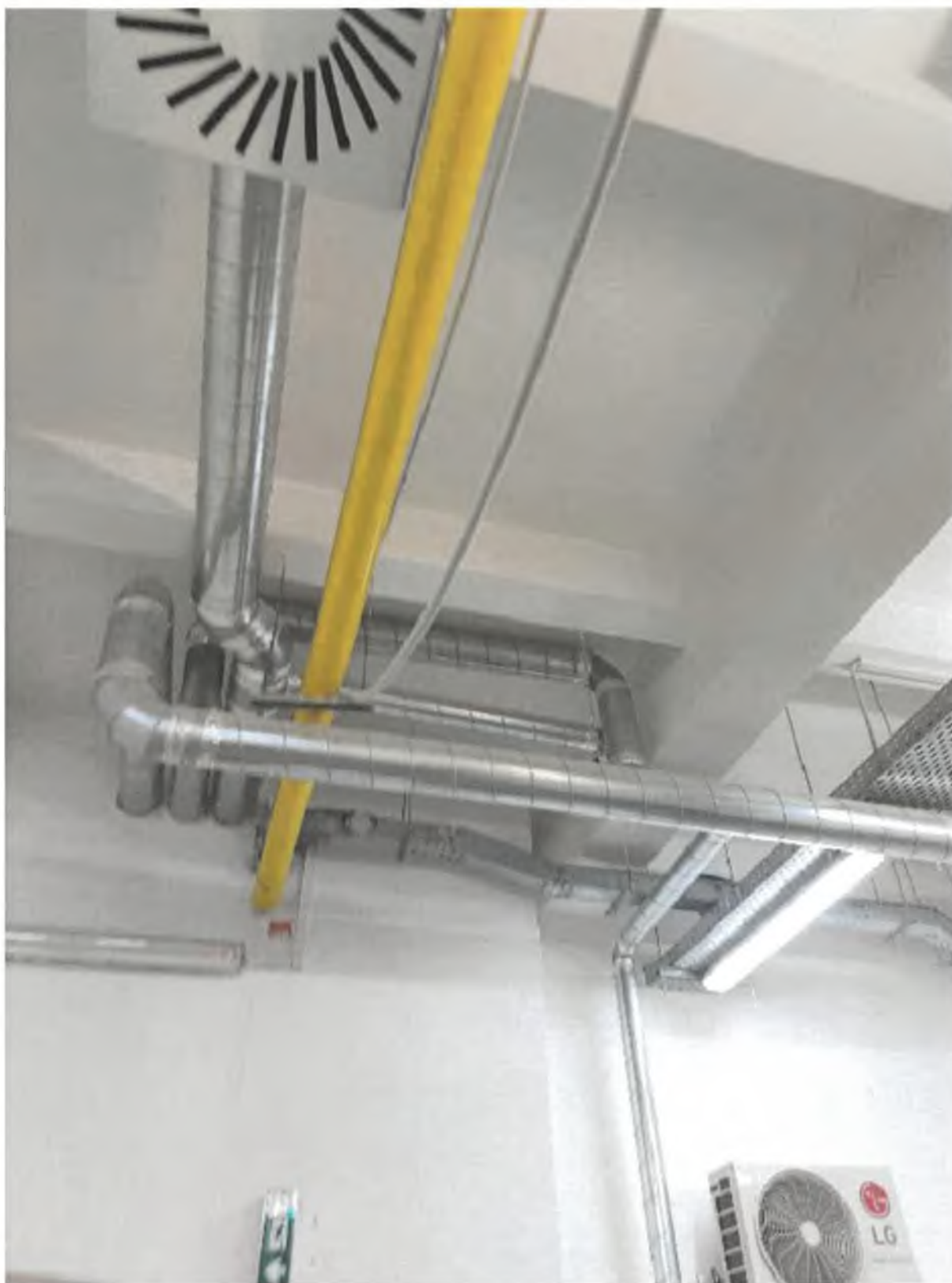
Foto 86 – Interiér – potrubí VZT, plynu, elektro, v technických částech
