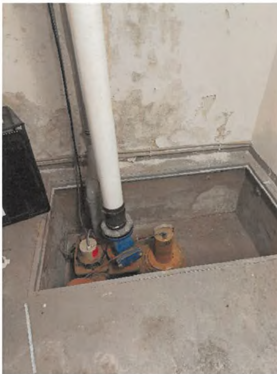
Foto 34 – Interiéry – technická místnost – přečerpávací stanice splaškových vod
