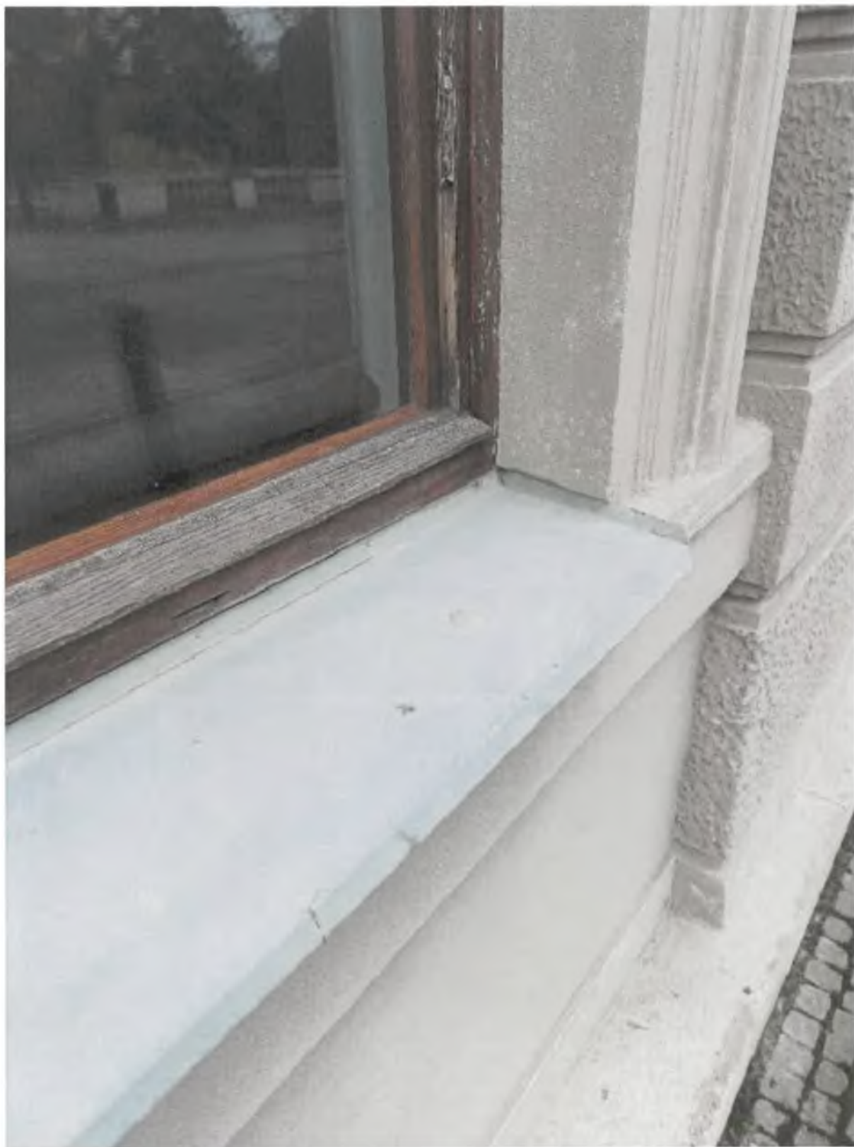
Foto 30 – Výplně otvorů – parapet lakovaný pozink – znatelná dožilost parapetu, praskliny
