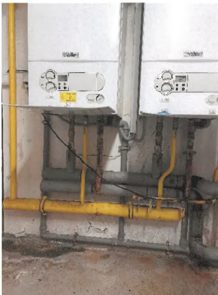
Foto 26 – Interiéry – technická místnost – otopná soustava v kotelně + plynovod a dva kotle
