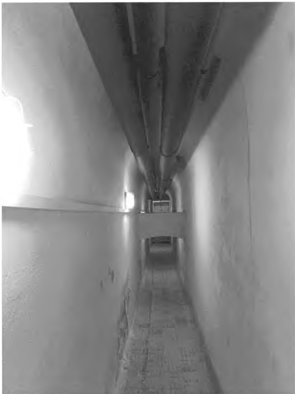
Foto 77 – Interiér – Vlhké sklepy – doporučeno řešit větrání + potrubí čerpadla
