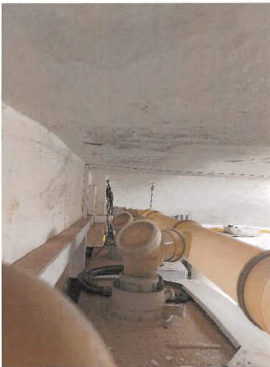
Foto 16 – Interiéry – technická místnost – odkouření plynových kotlů
