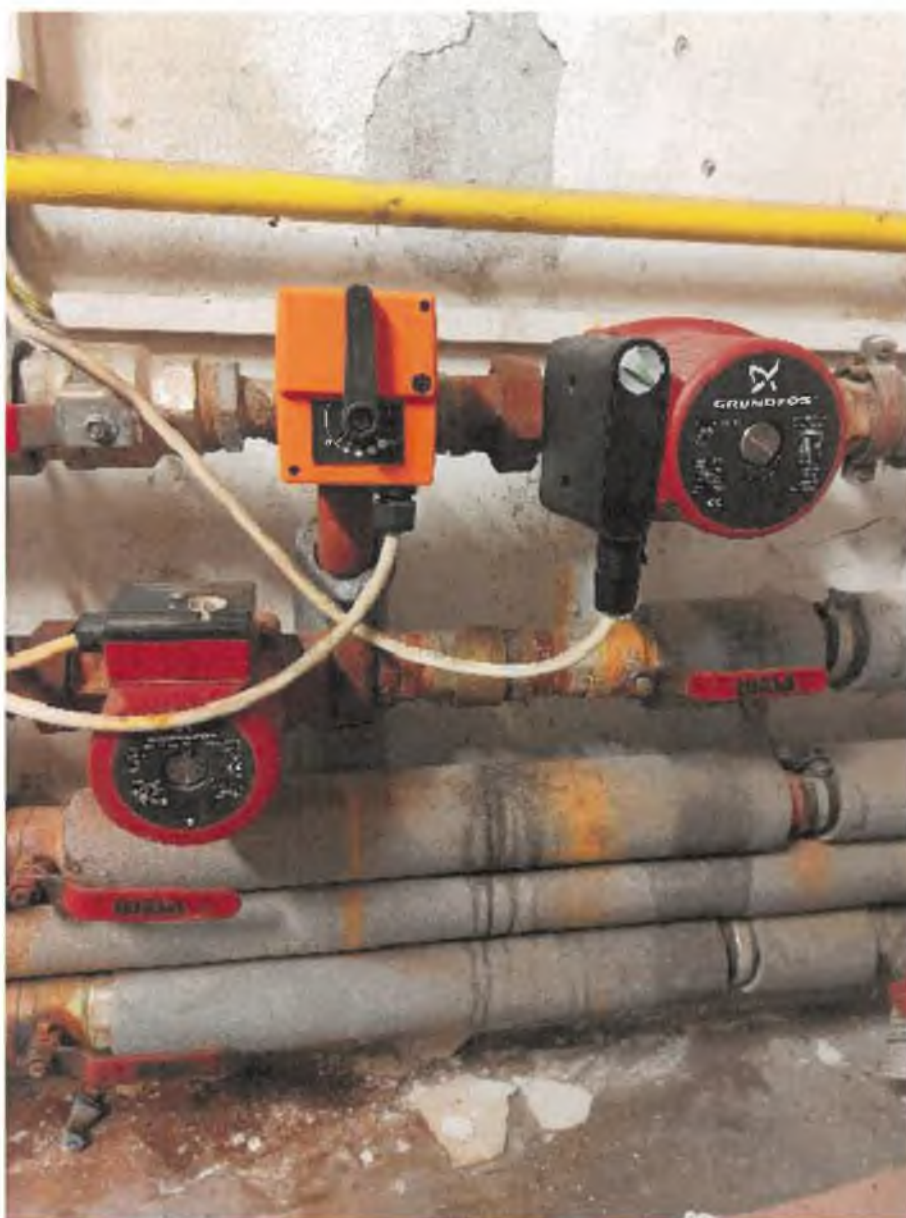
Foto 23 – Interiéry – technická místnost – čerpadlo otopné soustavy
