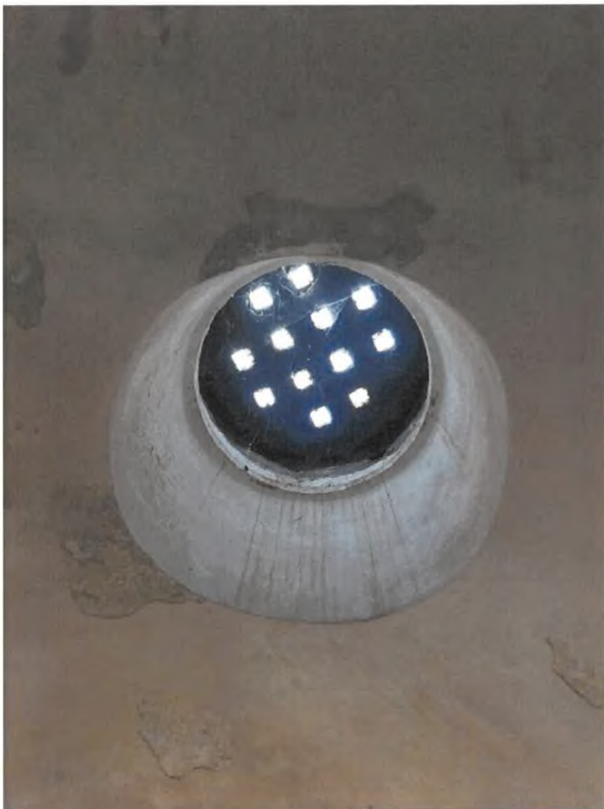
Foto 61 – Interiér – Vlhké sklepy – částečné větrání poklopem
