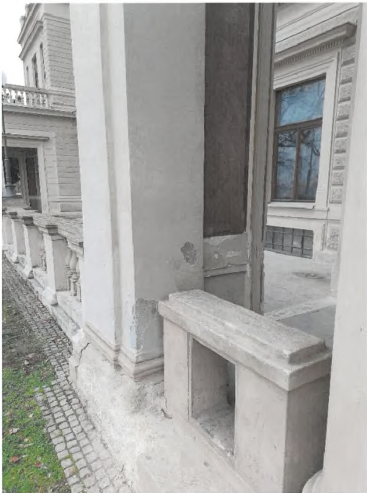
Foto 14 – Fasáda – jižní fasáda - degradace omítky
