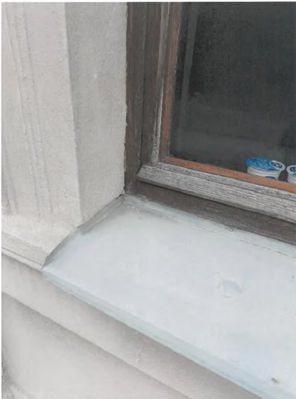
Foto 24 – Výplně otvorů – parapet lakovaný pozink – znatelná dožilost parapetu, špatně provedení propojení parapetu s oknem,
