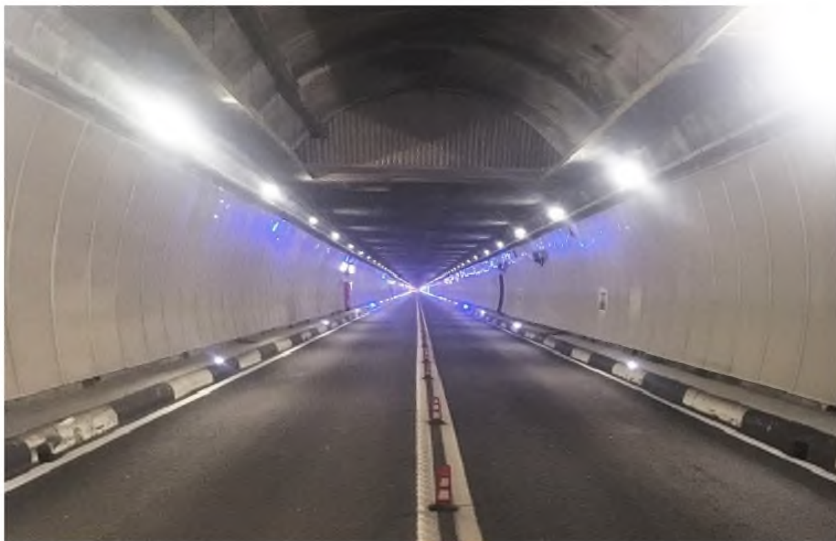
Obr. 13 Ražený silniční tunel Velký St. Bernhard s instalovaným zařízením pro geotermální energii
